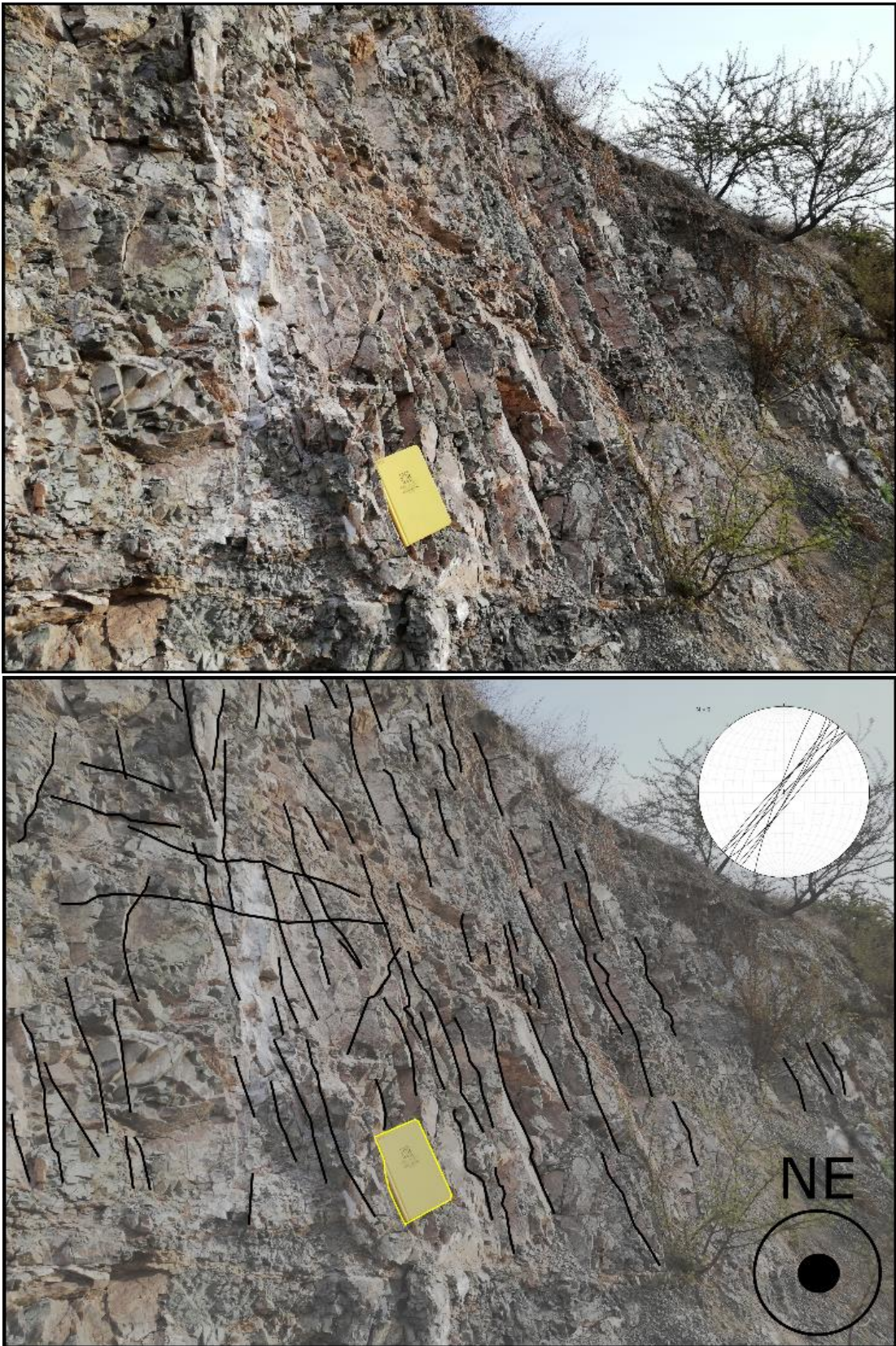
Figura 42. Fotografía del sitio 4 en la zona de falla 4 (arriba) y su observación estructural junto al gráfico de los planos de fracturas en Stereonet (abajo).
