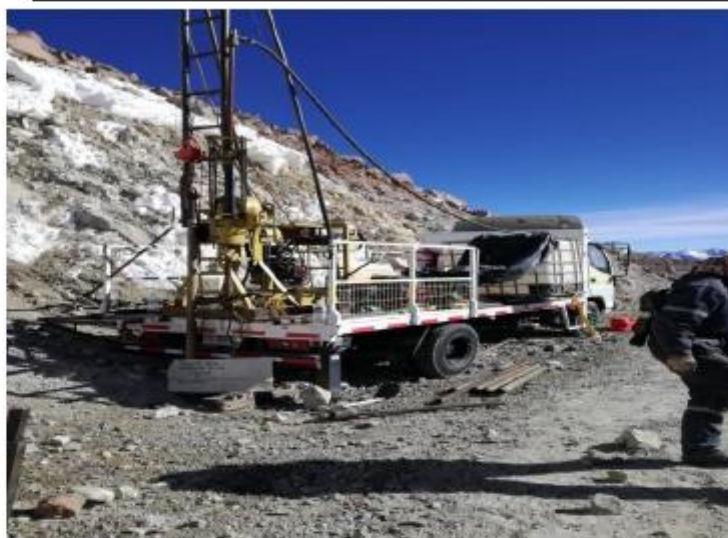
Fotografía N° : 1 Sondaje N° : ST.04 Camino de acceso cerro Chajnantor Descripción: : Ubicación de Sondaje a 5.342 metros de altura
