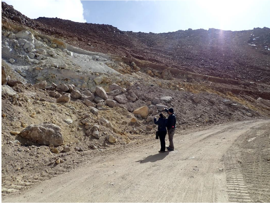
Fotografía 18. Acercamiento del talud inestable. DM 2+500
