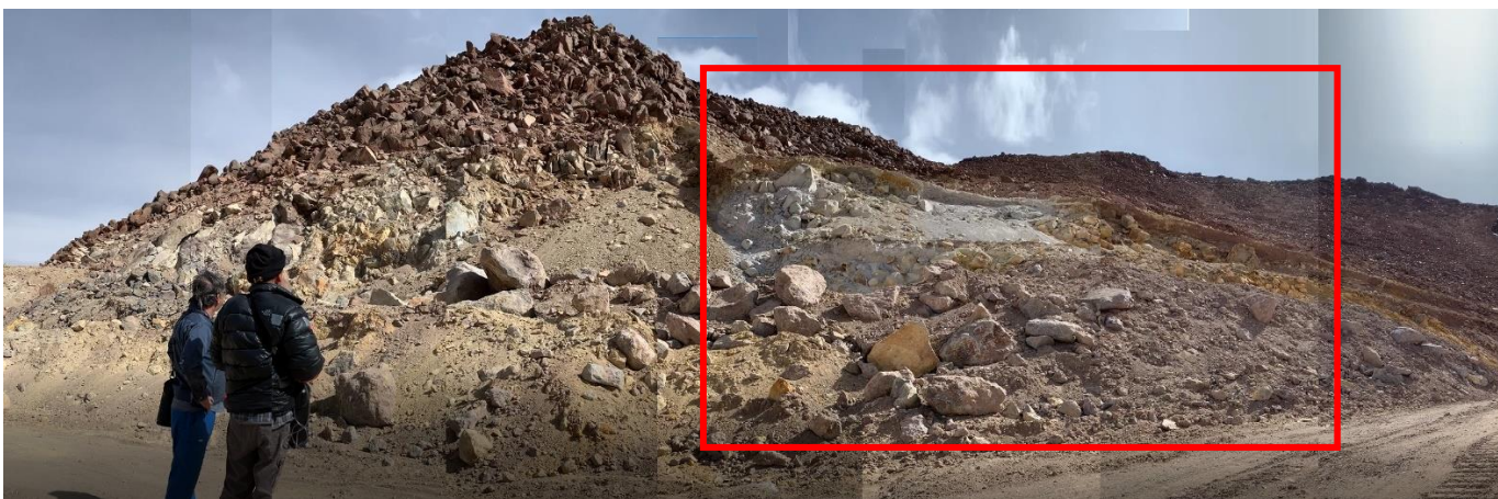
Fotografía 17. Vista panorámica del talud DM 2+500. Cuadro rojo señala área donde hay problemas de estabilidad.
