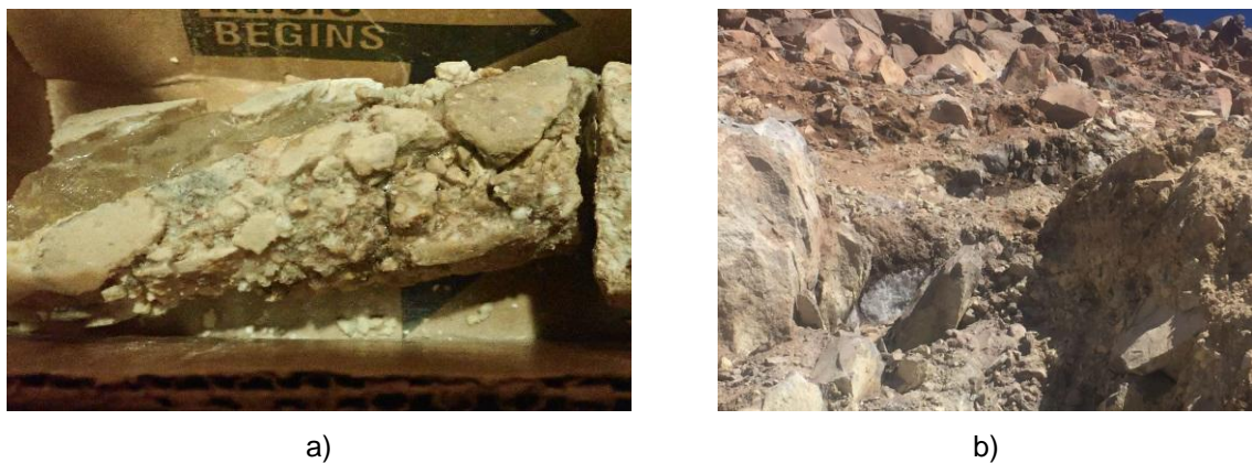
Figura 23. Tipos de hielo dentro de los taludes en el km 3.7. a) Hielo segregado b) Hielo intrusivo (Recuperado de: Yoshikawa, 2018)
