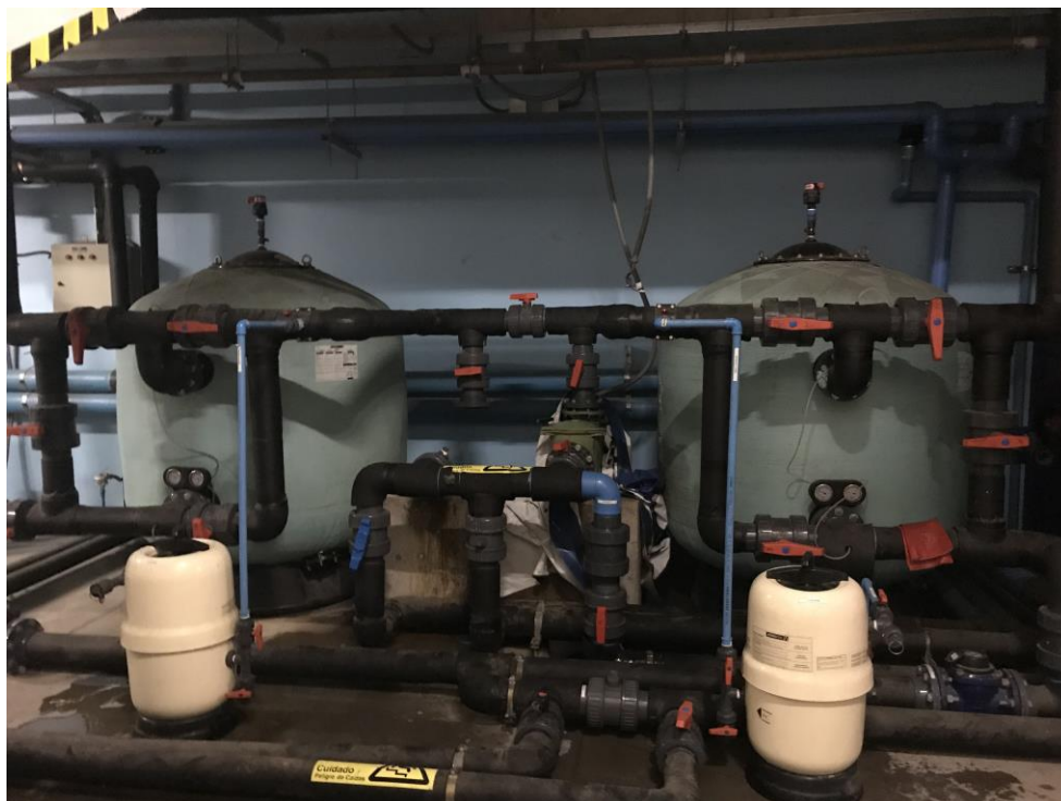
Figura 117: Cloradores, filtros y bombas de circulación de agua piscina temperada
