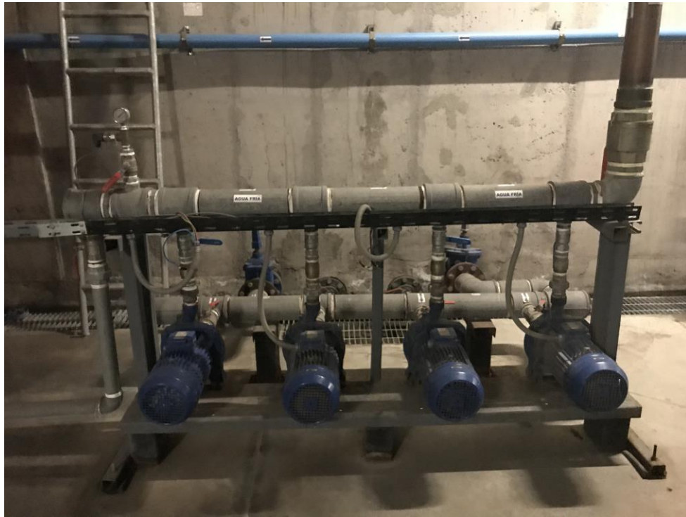
Figura 116: Bombas de agua potable
