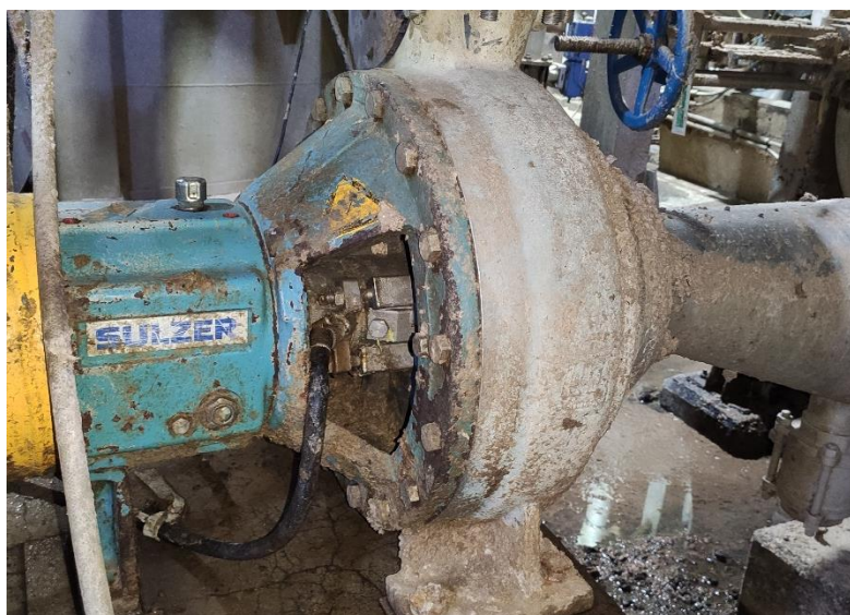
Figura 4.23: Bomba Descarga Estanque Sedimentación
