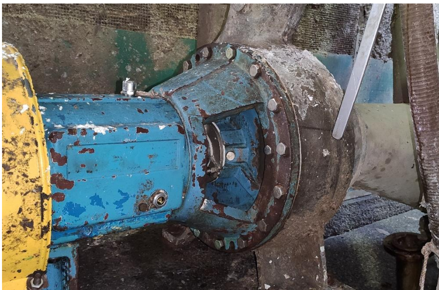
Figura 4.11: Bomba de descarga UP60
