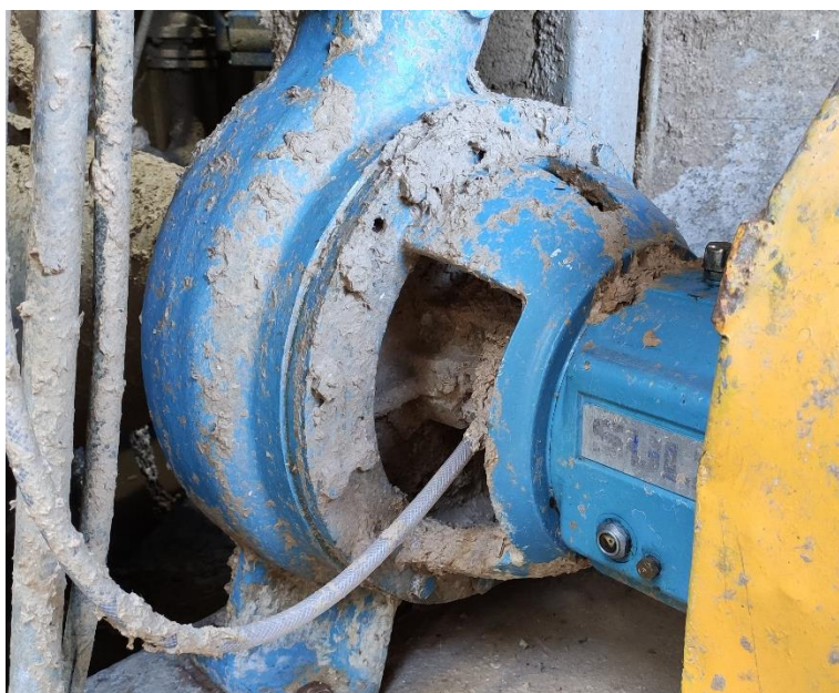
Figura 4.3: Bomba de descarga UP90
