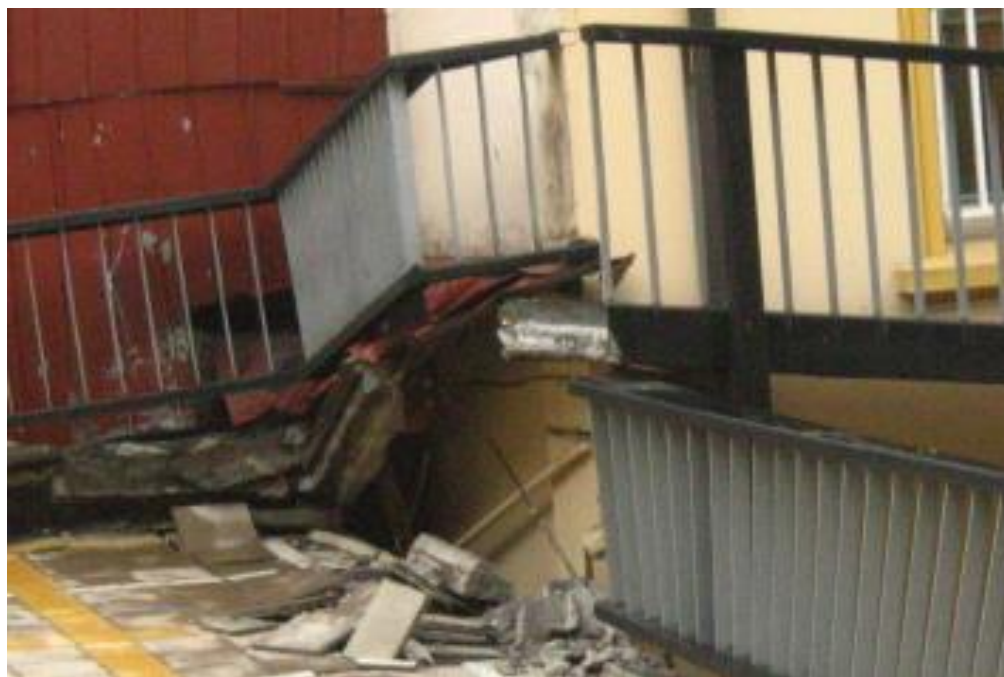
Fig. 2.12 Descenso de la estructura relativo a la estructura existente (Foto S. Sáez).
