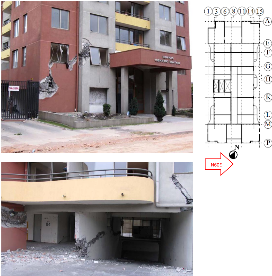
Fig. 5.8 Daños en edificio Centro Mayor (Foto Benjamín Westenenk).
