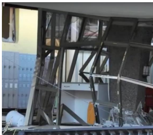
Fig. 2.27 Concentración de columnas de aluminio cercanas al Eje 1-B, vista desde el Este.
