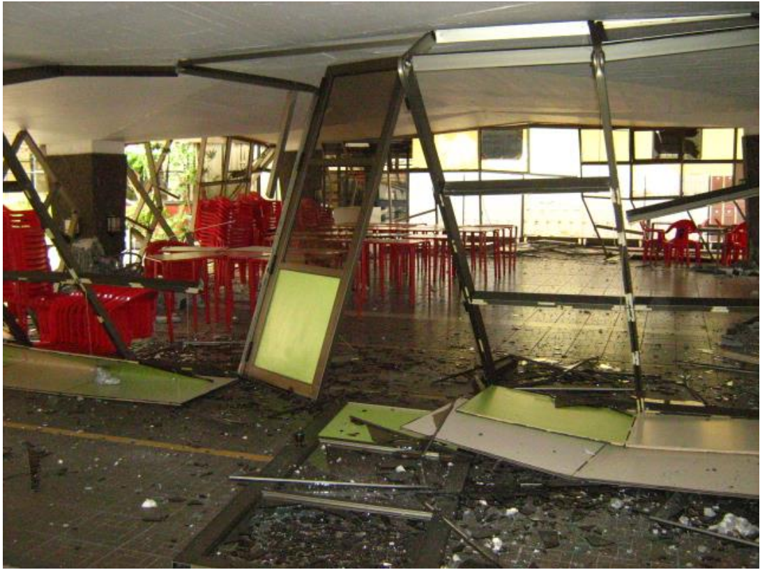
Fig. 2.20 Falla en columna intersección ejes 2-B, cercana, vista desde el Norte (Foto S. Sáez).
