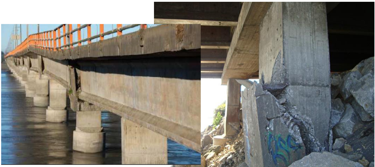
Fig. 5.41 Daños en Puente Juan Pablo II.
