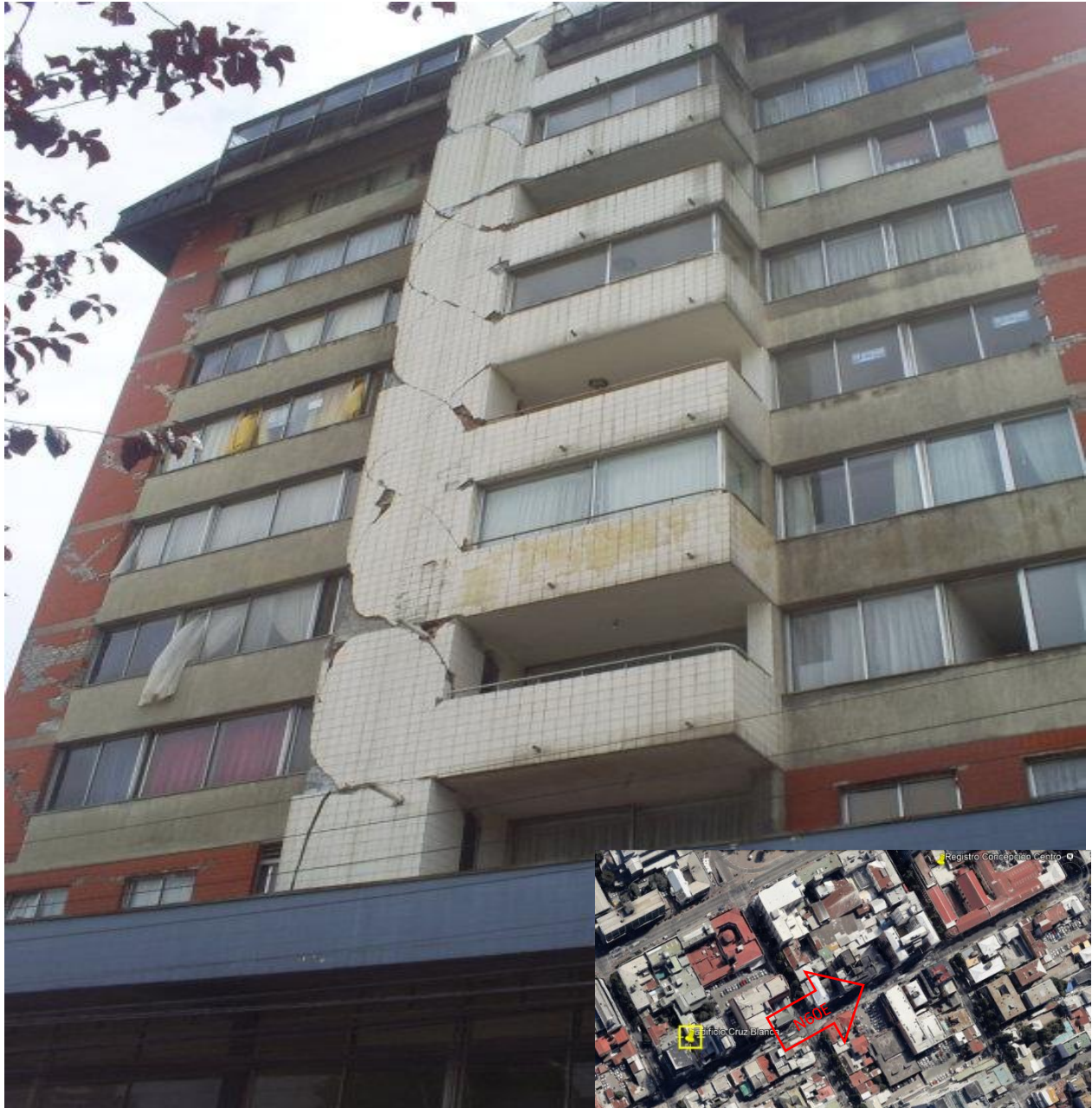
Fig. 5.20 Edificio Cruz Blanca, con daños evidentes en la Dirección N60^{\circ}E .
