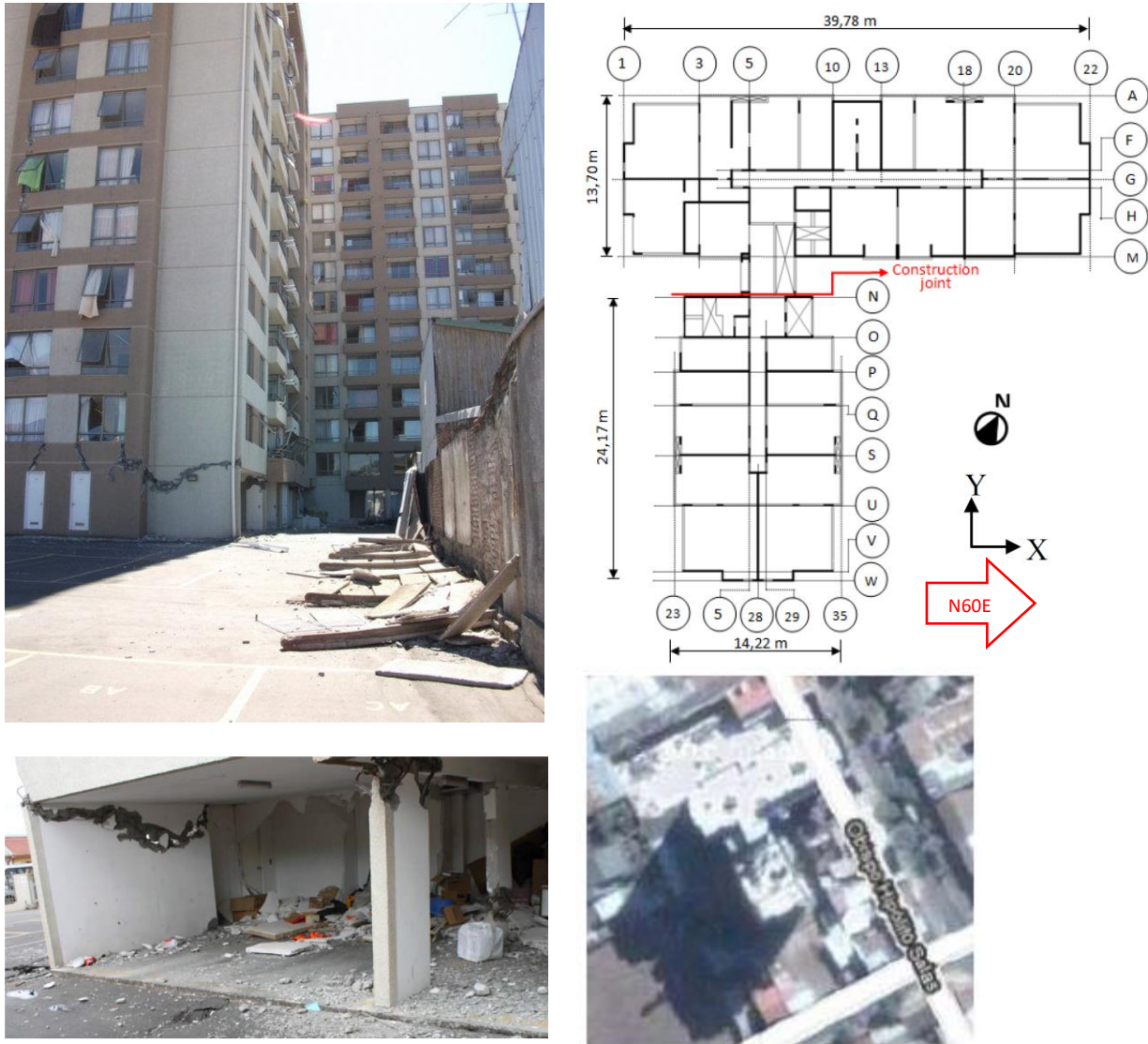
Fig. 5.7 Daños en torre Plaza del Río (Fotos Benjamín Westenenk).
