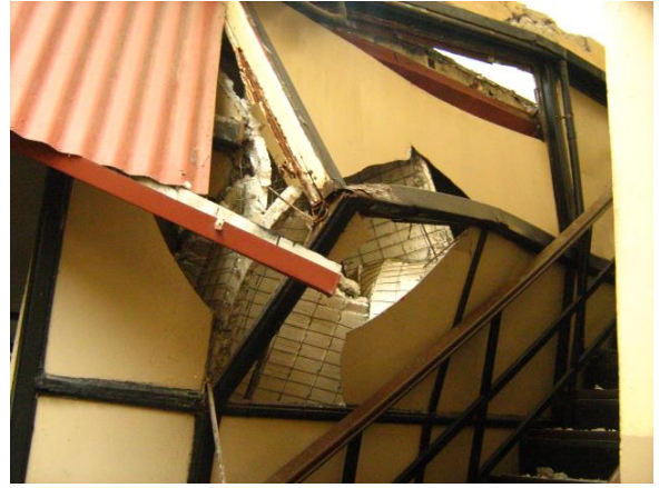
Fig. 2.24 Panel existente cercano al Eje3, vista desde el exterior.
