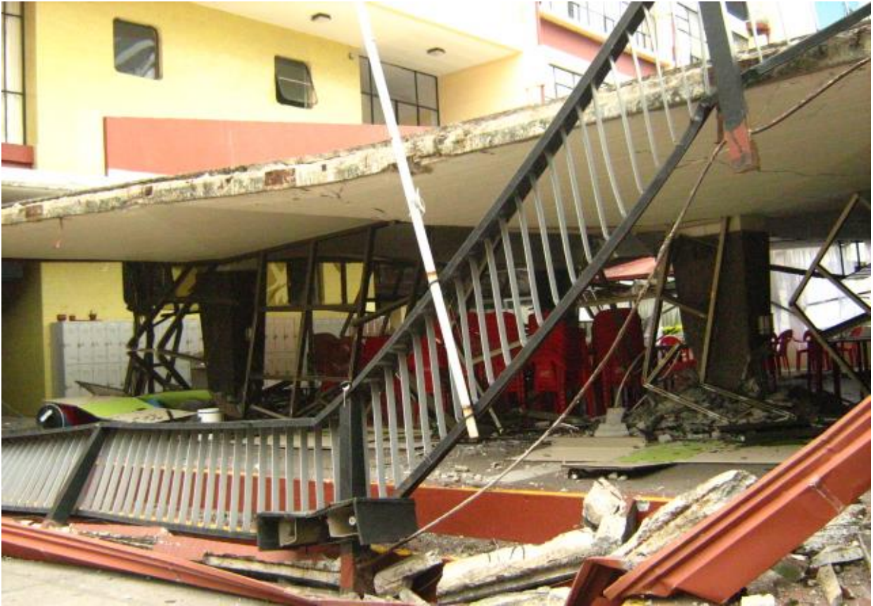
Fig. 2.22 Falla en columnas intersección ejes 1-B, más lejana, y 2-A más cercana, vista desde el este. Se aprecia el desprendimiento de la baranda superior (Foto S. Sáez).
