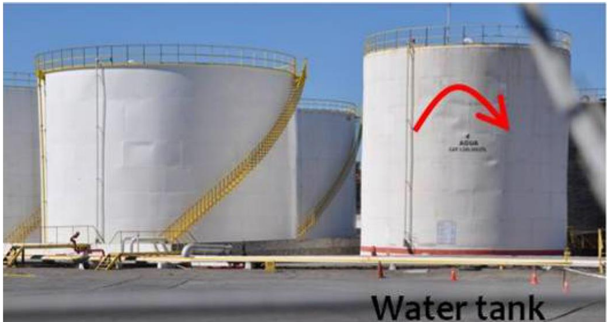
Fig. 5.54 Daños por pandeo y giro en estanques [64].
