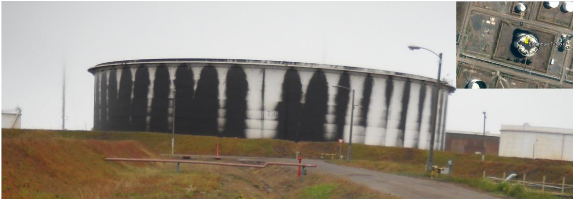
Fig. 5.51 Derrame en estanque T-30XX (Foto Carlos Patuelli).
