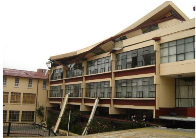
Fig. 2.9 Caída de vigas superiores y colapso 4º piso biblioteca (Foto Salvador Sáez).
