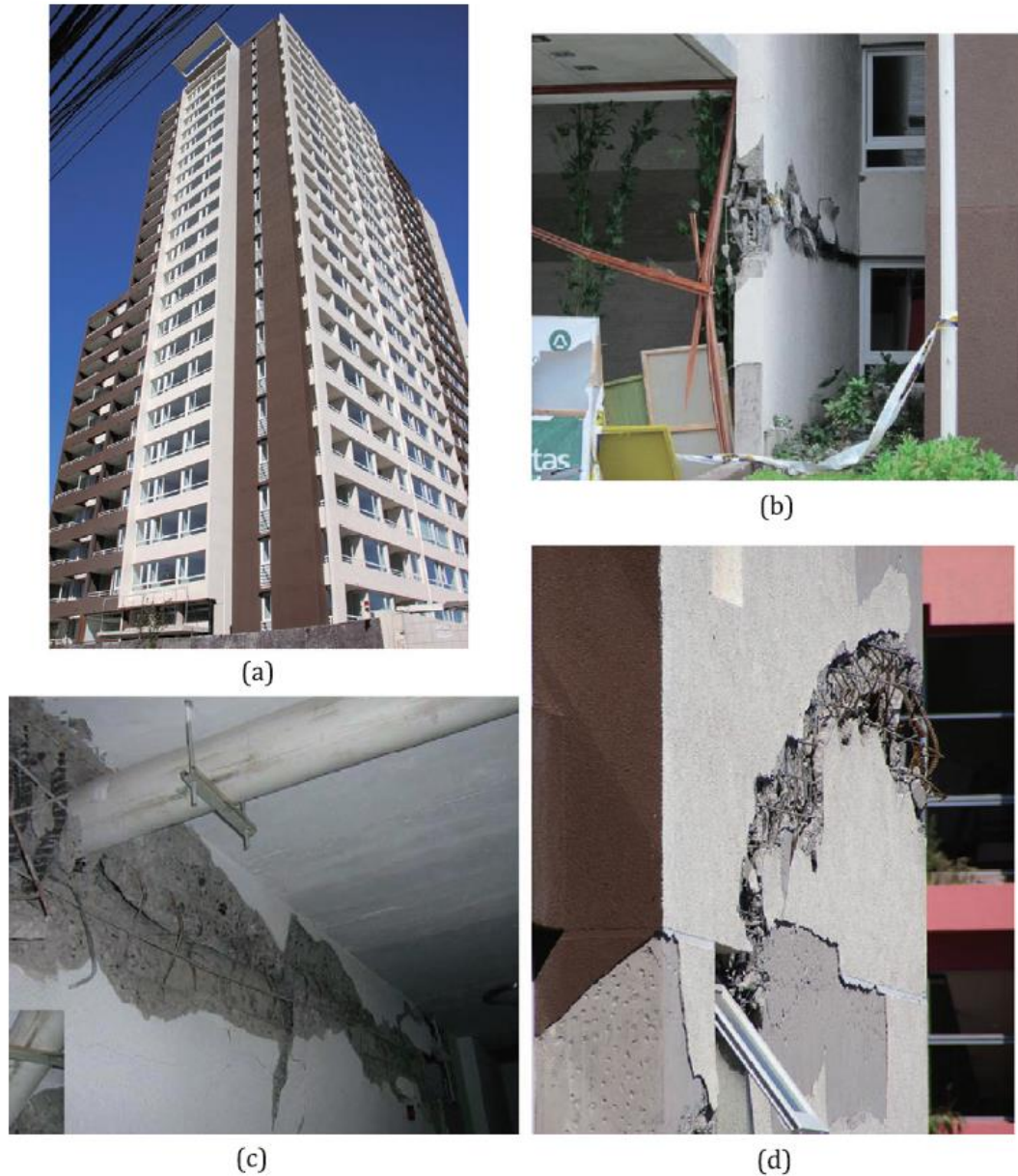
Fig. 5.14 Daños edificio Geocentro Obispo Salas. a) Vista en elevación b) Falla del muro en la entrada c) Falla en muro en subterráneo d) Falla en muro trasero del edificio [60].
