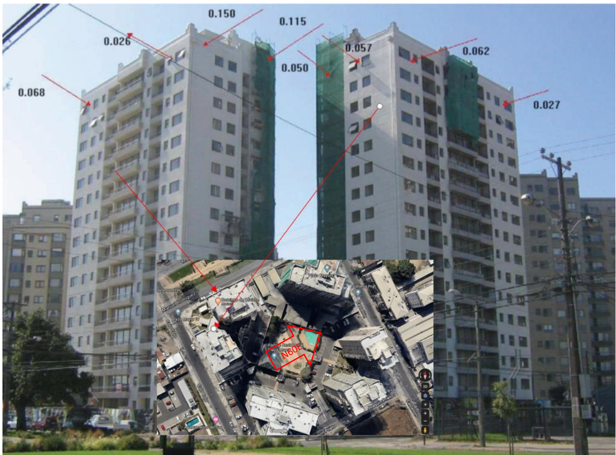
Fig. 5.19 Deformaciones permanentes en los edificios Plaza Mayor [61].
