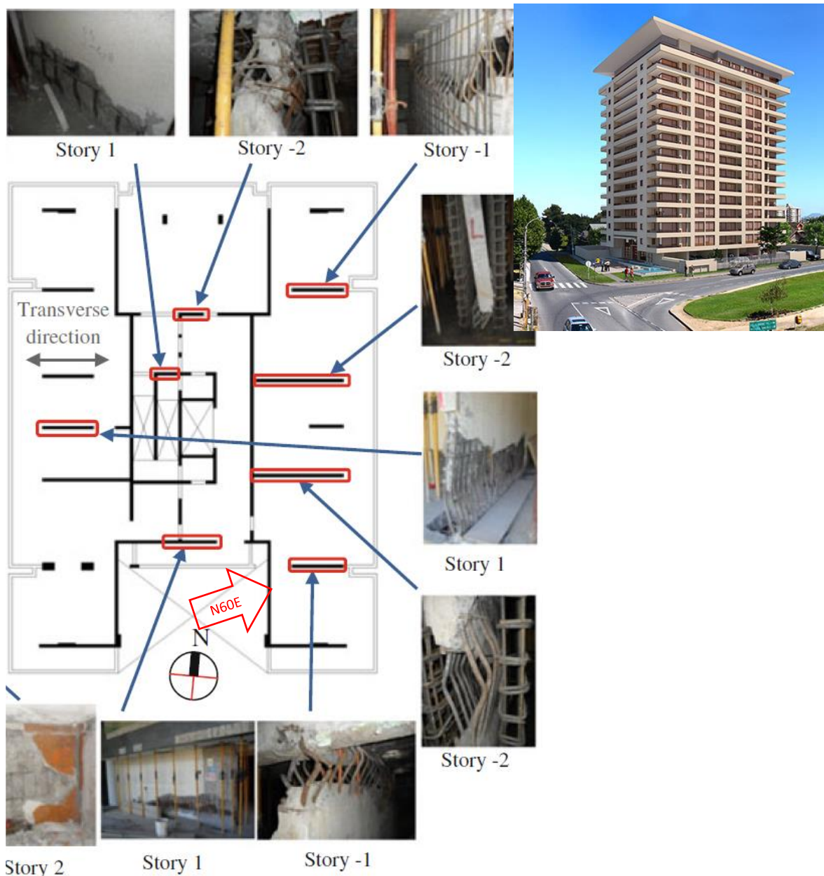
Fig. 5.35 Daños edificio Alto Huerto (Foto Benjamín Westenenk).
