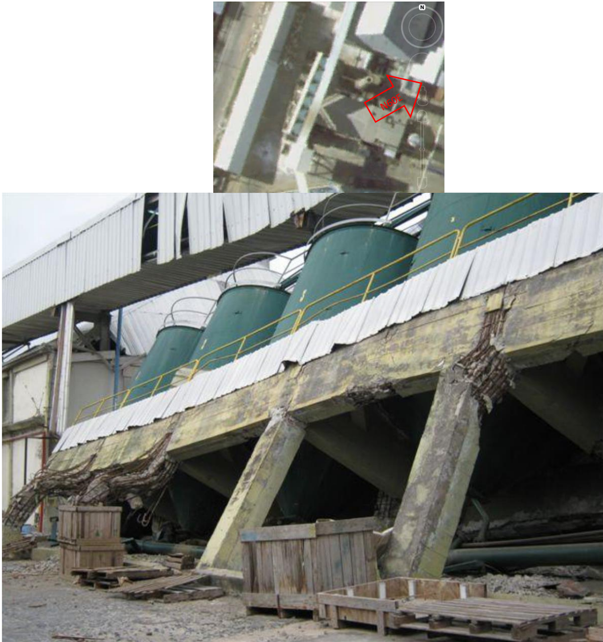
Fig. 5.57 Daños en Planta de Vidrios, Lirquén (Foto Pedro Hidalgo).
