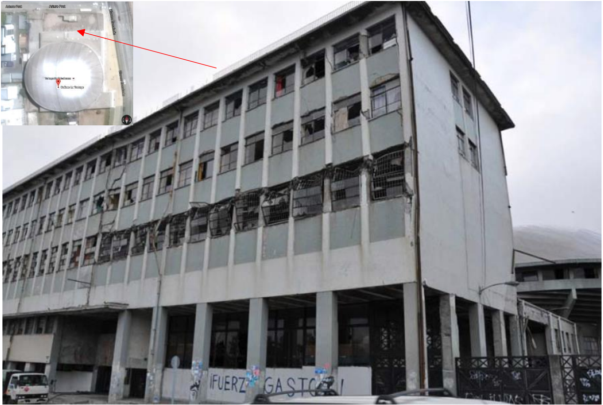
Fig. 5.38 Daños en Edificio Arturo Prat 88, Talcahuano. (Foto: Benjamín Westenenk).
