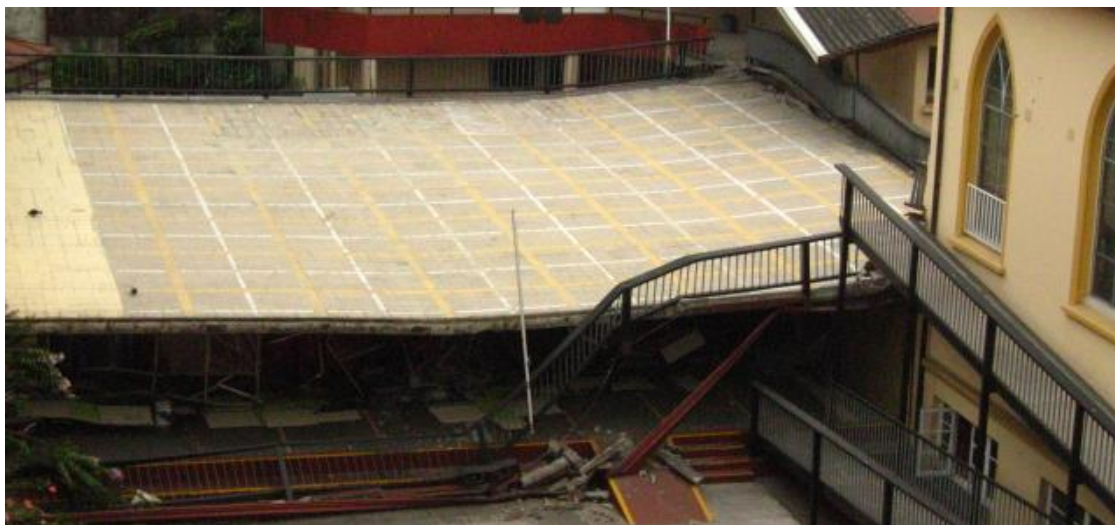
Fig. 2.11 Imagen general colapso (Foto S. Sáez).
