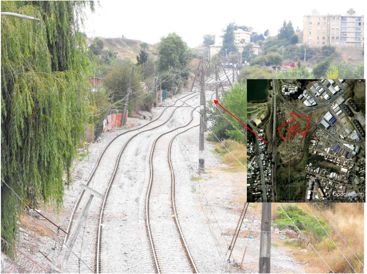
Fig. 5.47 Daños en línea ferra cercana a Paso Superior Arturo Prat (Foto Luis Enrique Fritz).
