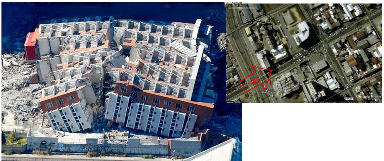
Fig. 5.4 El edificio de Alto Río colapsado tras el terremoto del 27 de febrero de 2010. (Foto “El Mercurio”, Mario Quilodrán. Foto lateral vista panorámica Google Earth).
