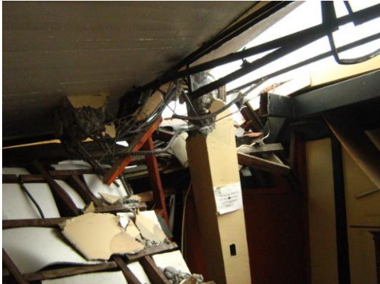
Fig. 2.8 Detalle colapso caída biblioteca en el piso 4 (Foto Salvador Sáez).
