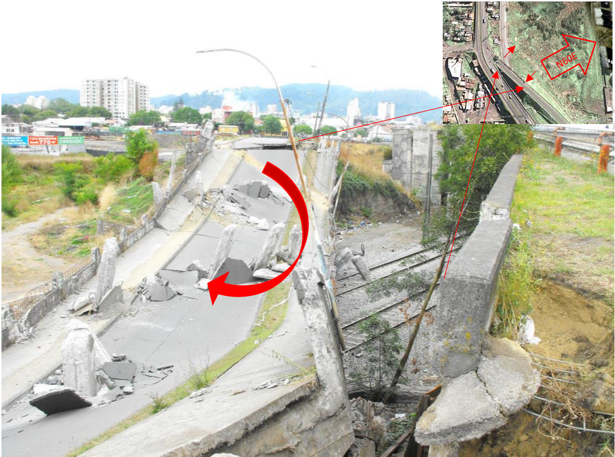
Fig. 5.46 Daños en Paso Superior Arturo Prat (Foto Luis Enrique Fritz).
