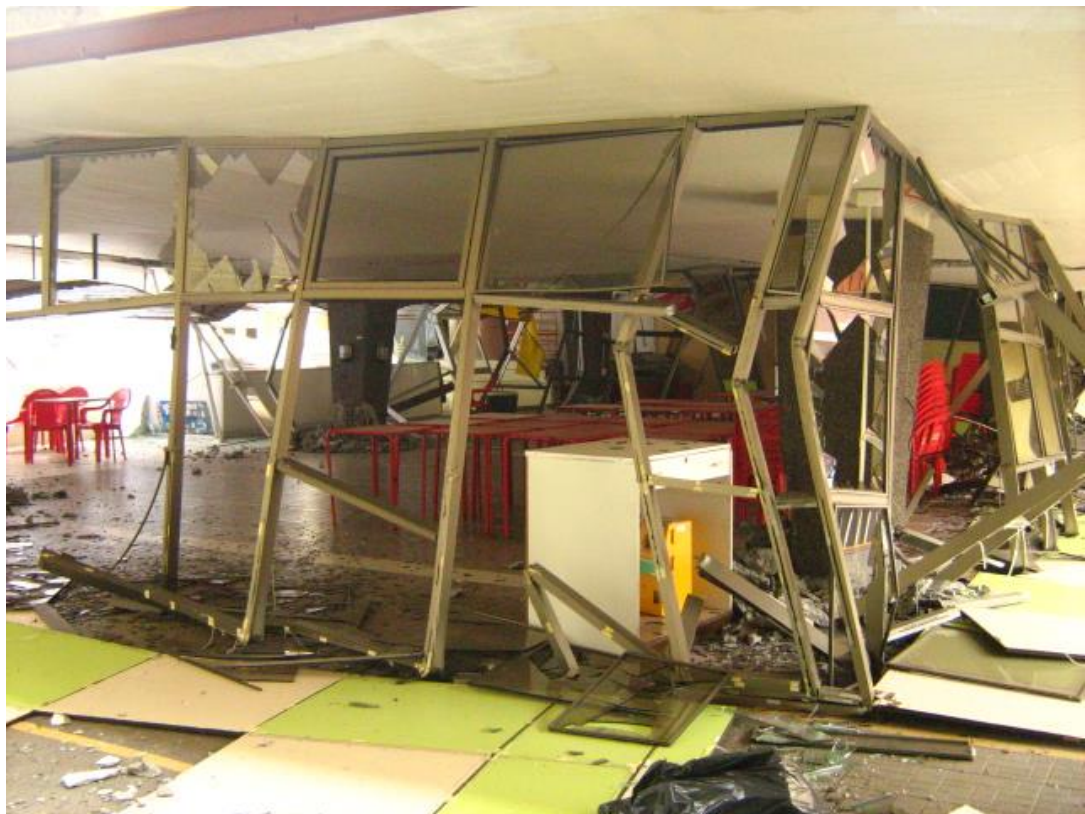
Fig. 2.21 Falla en columnas intersección ejes 1-B, más cercana, y 2-A más lejana, vista desde el sur (Foto S. Sáez).
