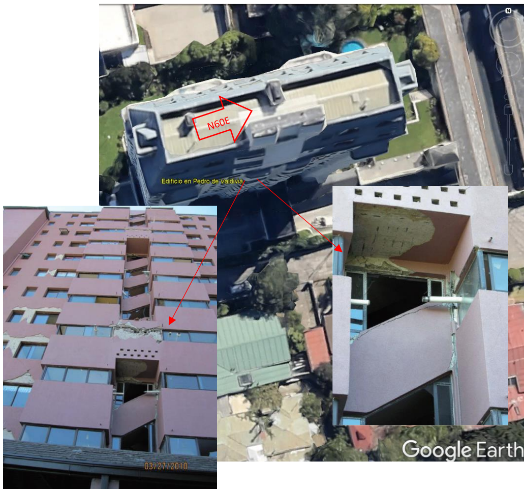
Fig. 5.37 Edificio Pedro de Valdivia, Concepción. Daños dominantes en dirección N60^{\circ}E [62].
