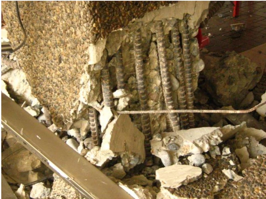
Fig. 2.19 Falla en columna intersección ejes 2-B, vista desde el Este (Foto S. Sáez).
