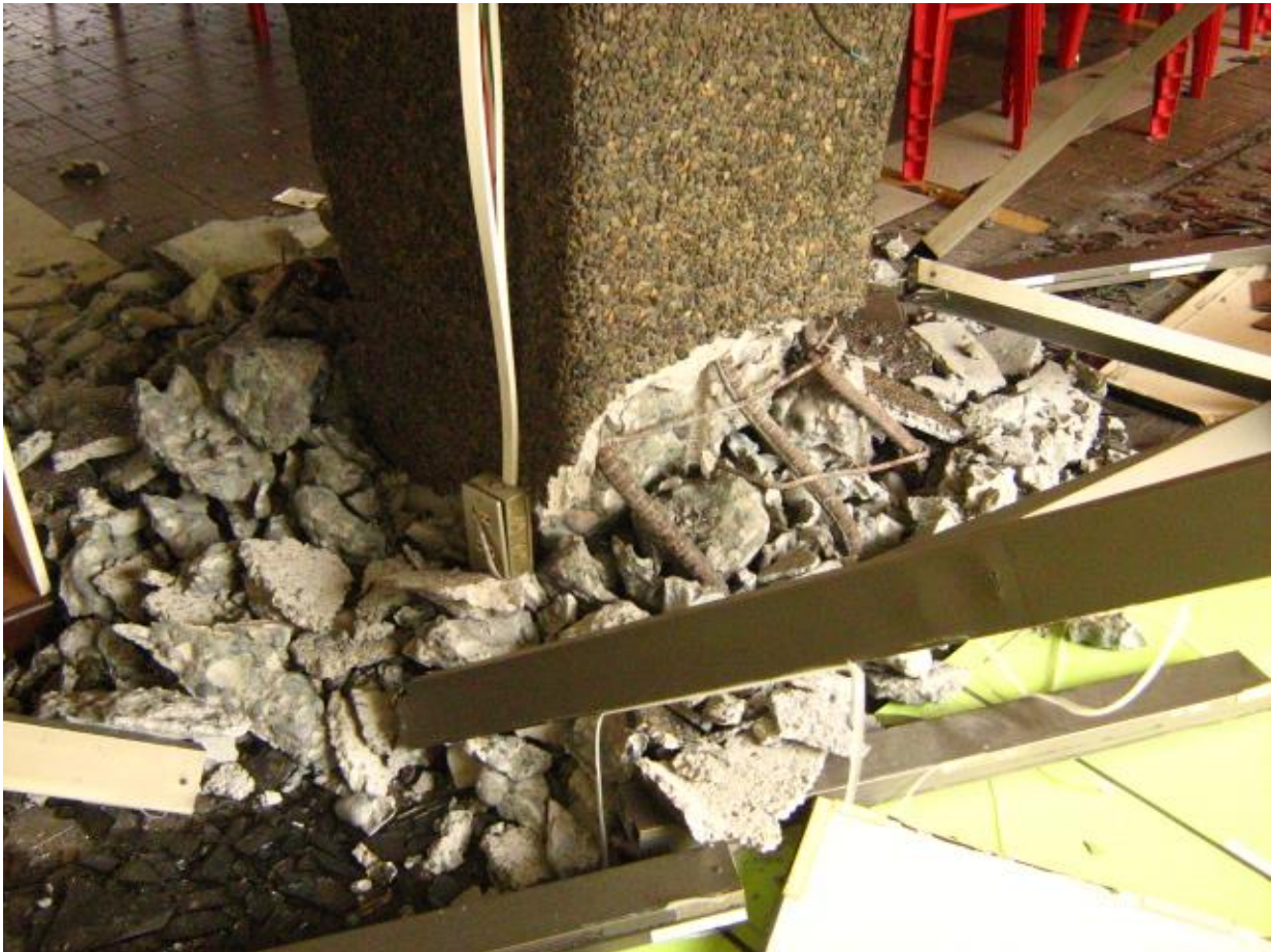
Fig. 2.17 Falla en columna intersección ejes 1-B, vista desde el Sur (Foto S. Sáez).
