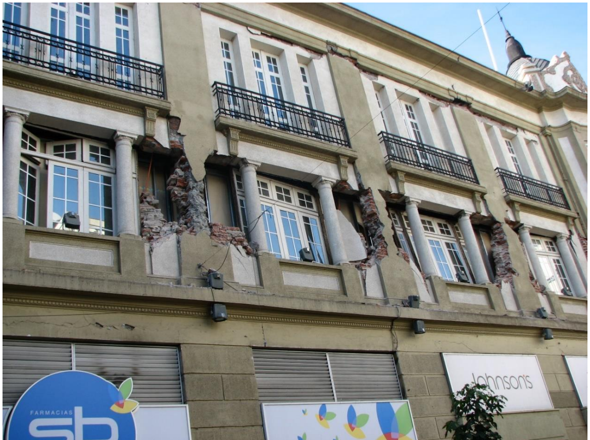
Fig. 5.25 Daños en fachada tiendas Johnson calle Barraos Arana, paralela a N60°E (Foto propia).
