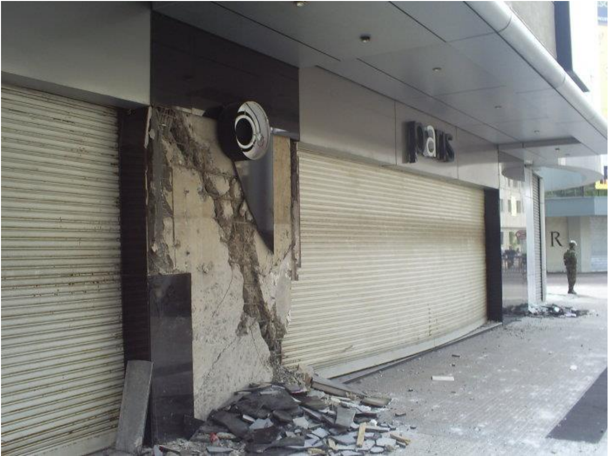
Fig. 5.28 Daños en muros primer piso tienda Almacenes París fachada calle Barros Arana.
