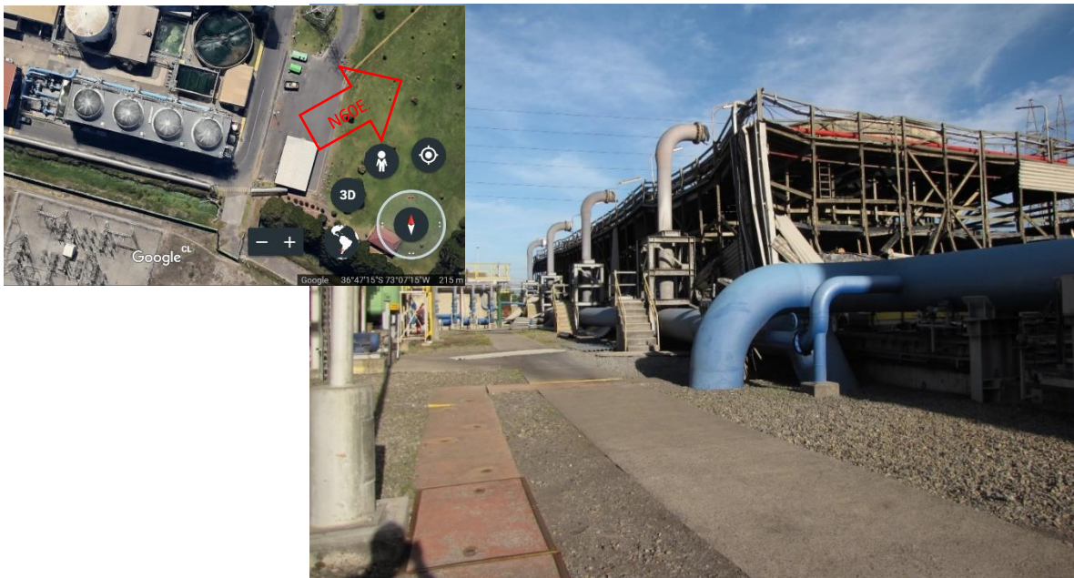
Fig. 5.52 Torre de aerorefrigeración. (Foto Carlos Patuelli).
