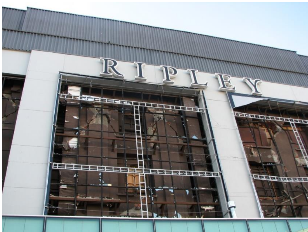
Fig. 5.27 Daños en Fachada tienda Ripley Paralelos Barros Arana (Foto propia).
