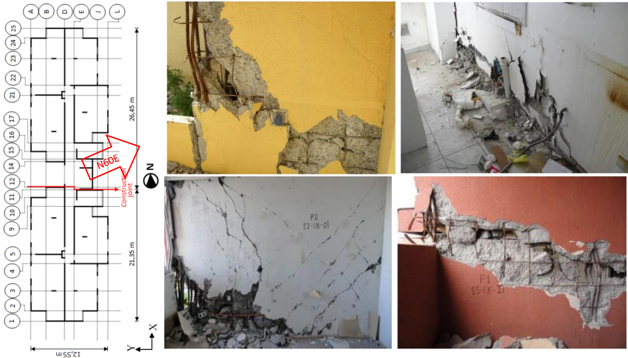
Fig. 5.21 Daños en edificios Rodrigo de Triana y Puerto de Palos (Foto Benjamín Westenek).
