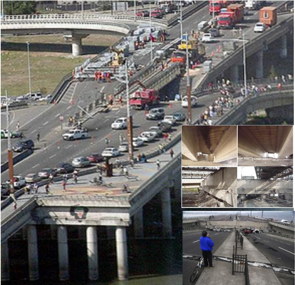
Fig. 5.44 Daños en Puente Llacolén (Fotos Egon Wolf y Claudio Nuñez).
