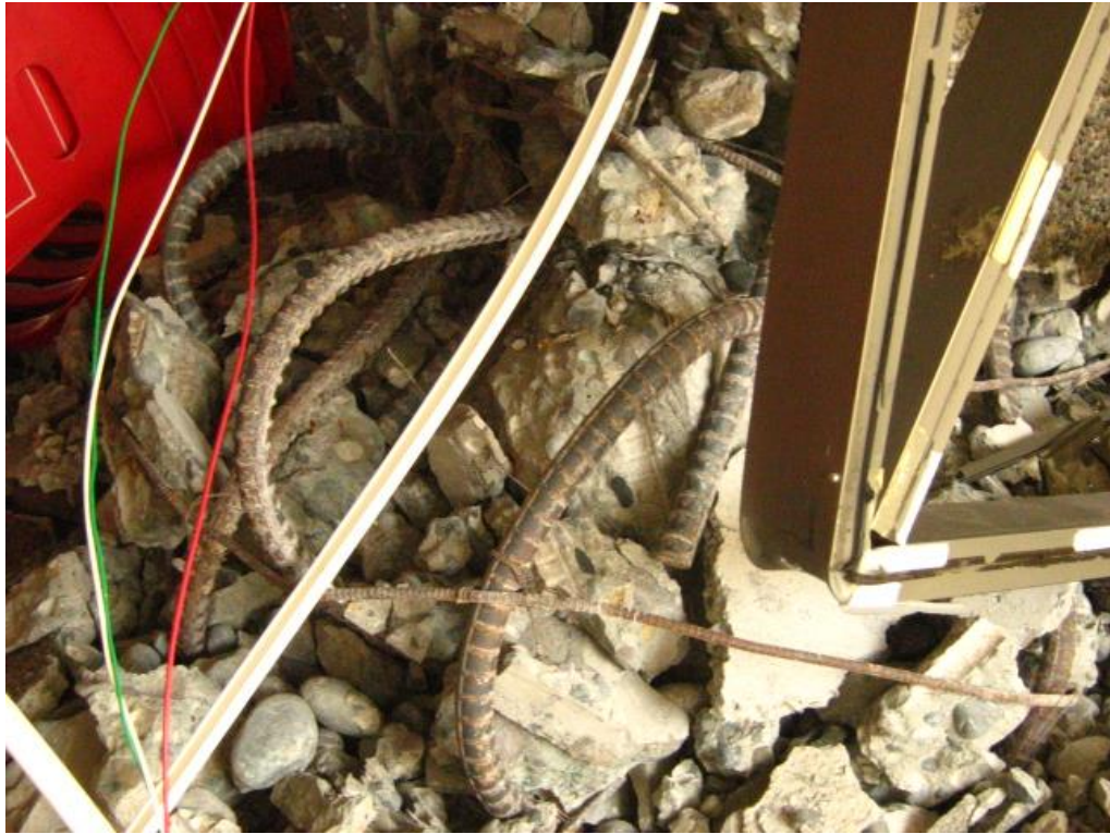
Fig. 2.18 Falla en columna intersección ejes 2-B, vista desde el Sur (Foto S. Sáez).
