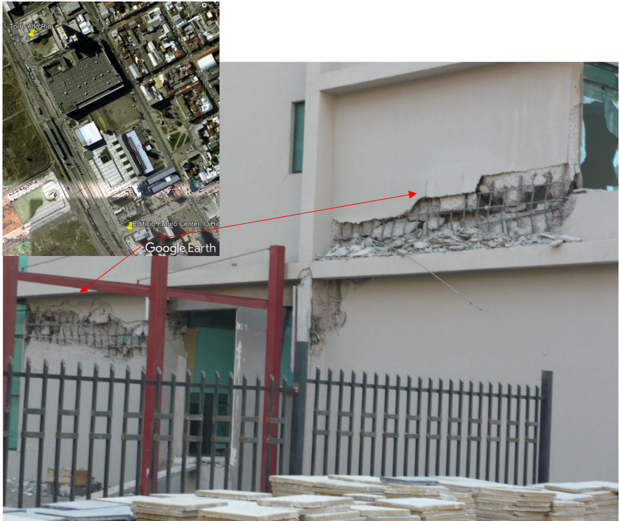
Fig. 5.17 Daños Edificio Futuro Center (Fotos Rodrigo Betanzo. Foto ubicación Google Earth).
