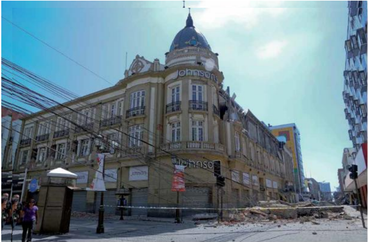
Fig. 5.24 Daños en fachada tiendas Johnson calle Barros Arana con Colo-Colo. (Foto propia).
