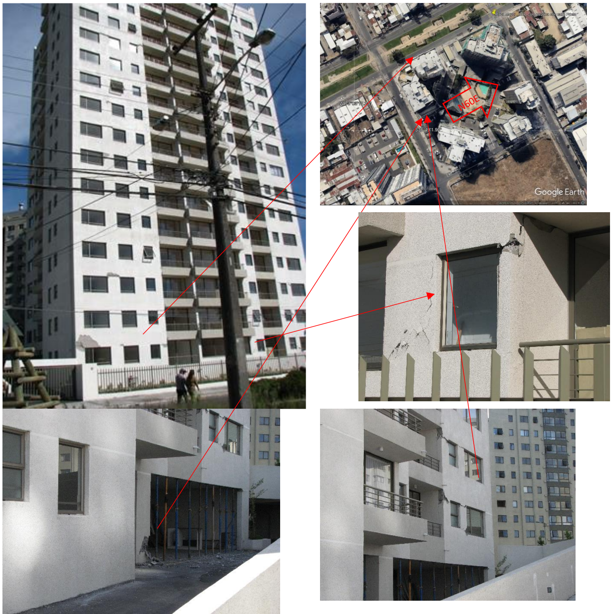
Fig. 5.18 Daños en conjunto Plaza Mayor (Fotos propias).
