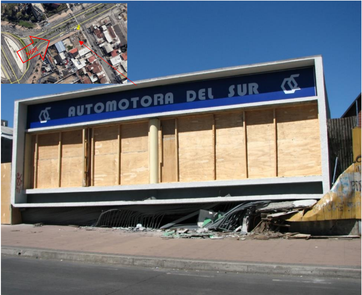
5.22 Daños en Automotora del Sur (Foto Propia).
