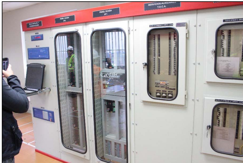
Figura 3.9 – Bastidores de control y protecciones (fuente: autor).
