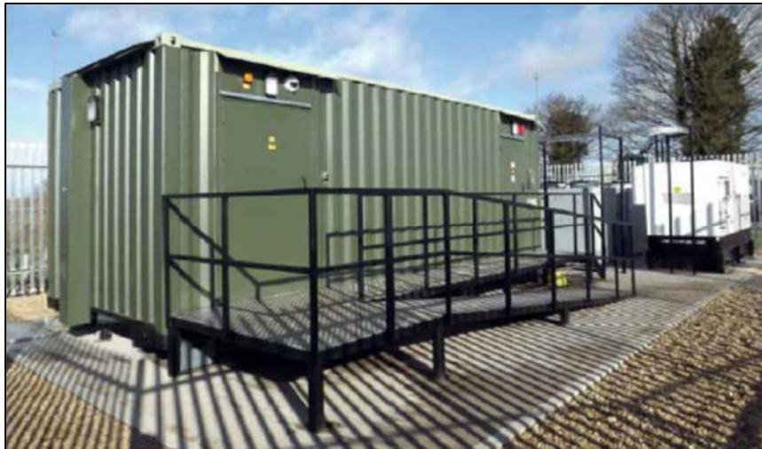
Figura 1.3 – Caseta eléctrica tipo contenedor [25].
