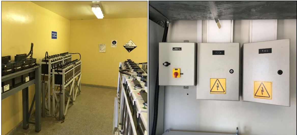
Figura 3.11 – Servicios auxiliares. Banco de baterías (izq.); tableros de distribución (der.) (fuente: autor).
