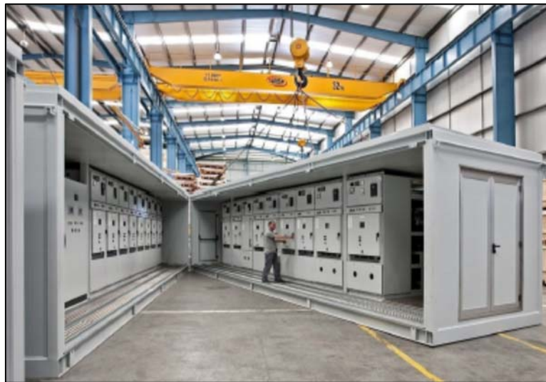
Figura 3.5 – Ejemplo sala eléctrica modular [18].
