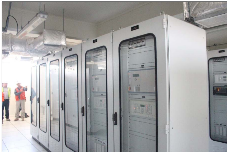
Figura 3.10 – Armarios de control y protecciones (fuente: autor).
