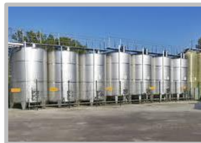
Ilustración 17: Estanques de aceite
