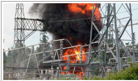
Figura 3.9: Explosión en subestación por falla de transformador.
