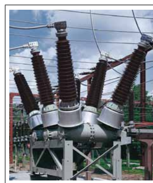
Figura 2.26: Interruptor de Tanque muerto [19].
