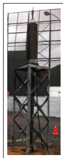
Figura 2.69: Estructura metálica soporte mufa "cable/aire".
