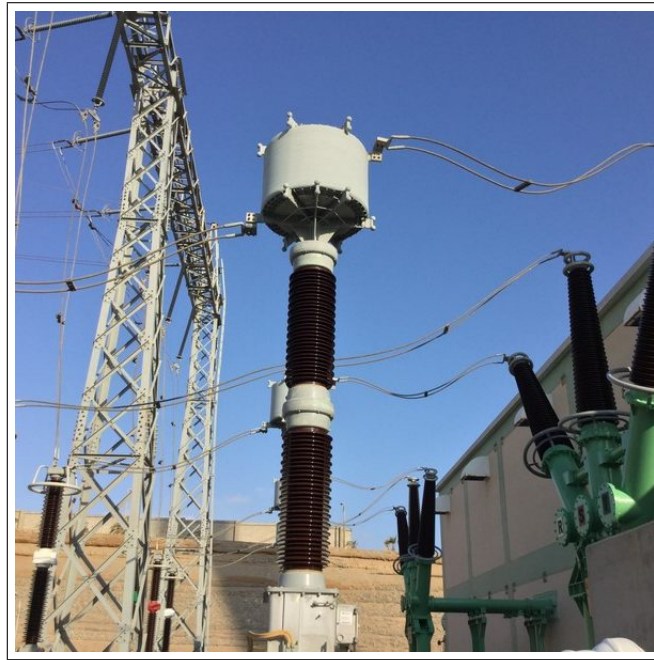
Figura 2.43: Trampa de onda montada sobre aislador [27].
