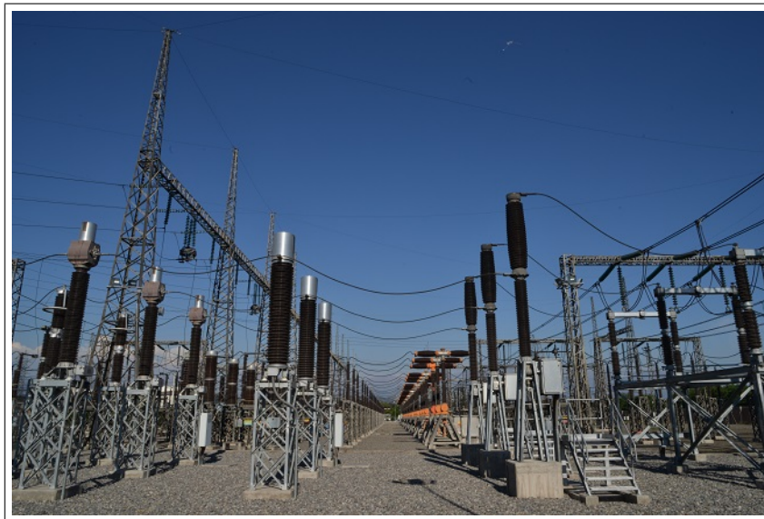
Figura 1.1: Subestación AIS Cerro Navia 220kV [4].
