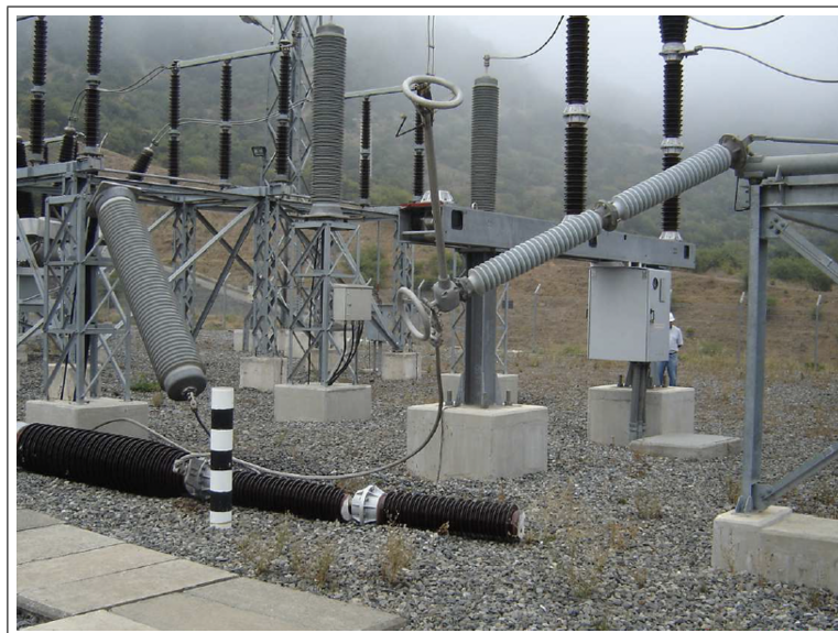
Figura 2.92: Interruptor colapsado arrastrando equipos vecinos [35].
