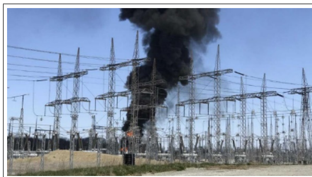
Figura 3.10: Impacto de un rayo en subestación.
