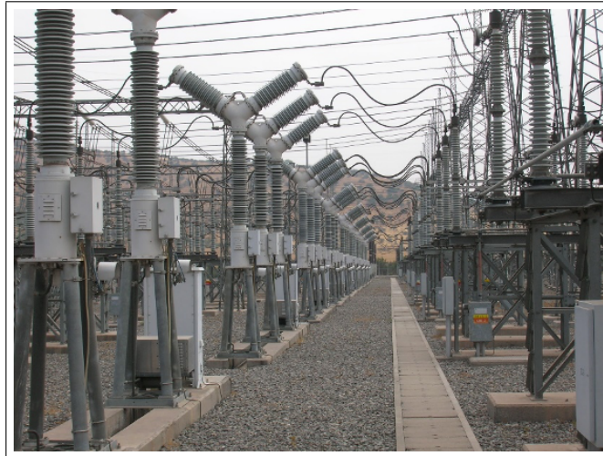
Figura 2.62: Holguras de chicotes entre Interruptores y Desconectores.
