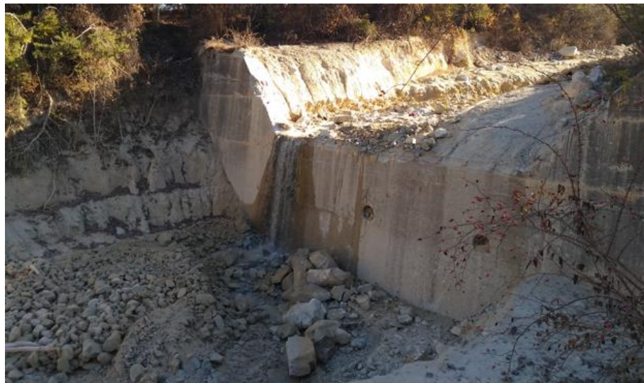
Figura 2.4: Depósitos y sedimentos de tamaño variable ubicados en una presa contenedora ( check dam ) de la quebrada Illgraben, cantón de Valais, Suiza.
