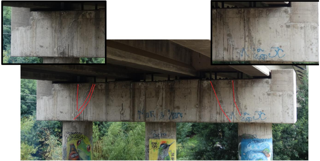
Figura 6.13: Patrón de Daño en Viga de Coronamiento Cepa 4 Puente Águila Norte.
