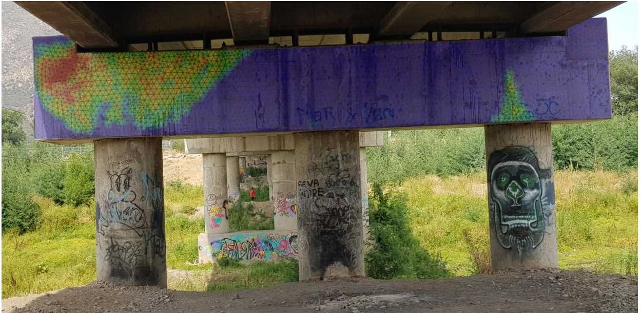
Figura 10.19: Comparación Deformaciones Plásticas de Hormigón versus Foto de Cepa Puente Águila Norte (Cepa N° 4).
