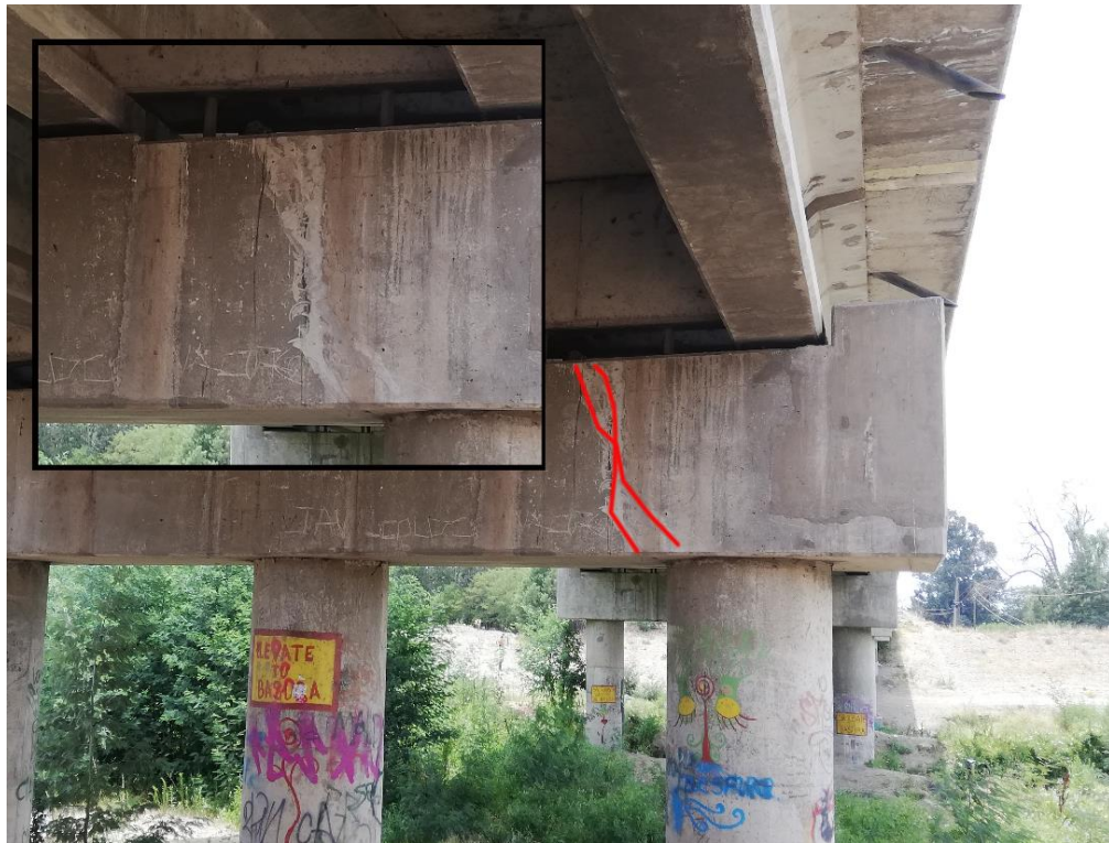
Figura 6.12: Patrón de Daño en Viga de Coronamiento Cepa 1 Puente Águila Norte.
