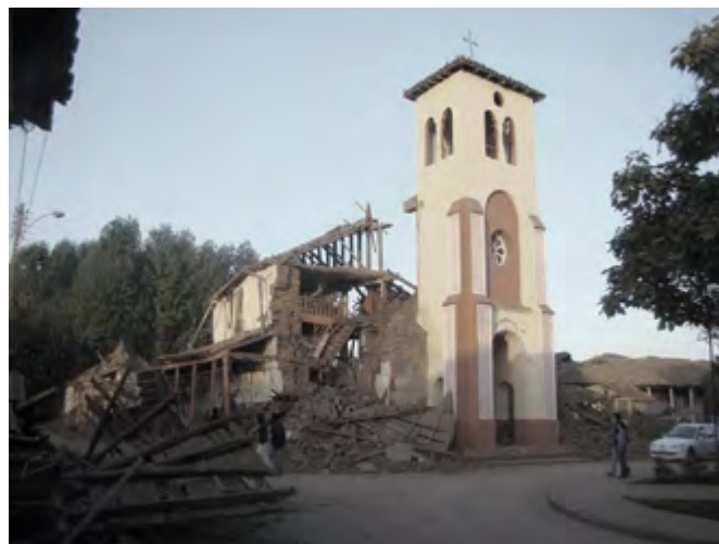
Imágenes de la Iglesia de San Antonio de Padua de Chépica, destruida por terremoto, extraída el 12.08.2019 desde: https://www.plataformaarquitectura.cl/cl/02-44388/iglesia-san-antonio-de-padua-clipica-cheunvogl/clipica_2
