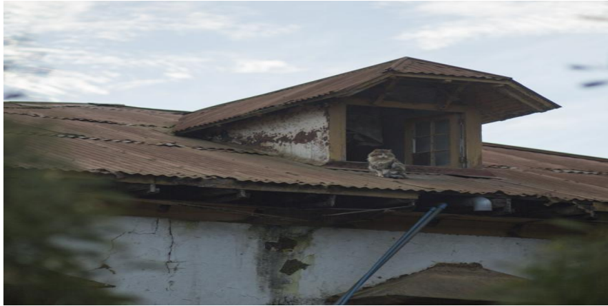
Figura 14. Detalle del daño estructural de una de las viviendas de la zona típica de los barrios Vaticano y Quirinal, por acción de intemperie y la salinidad.
