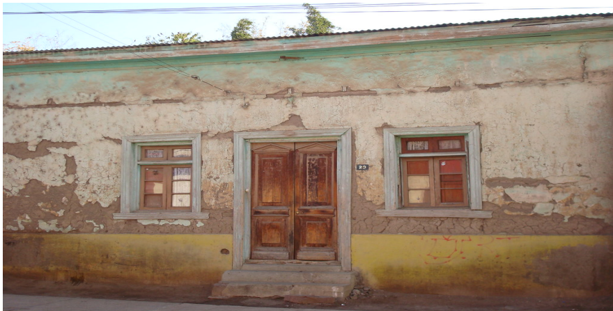
Figura 13. Fachada patrimonial de Putaendo deteriorada por agentes ambientales de erosión y corrosión.
