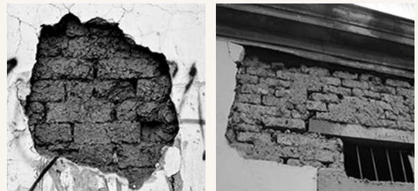
Fuente: Rojas, 2016. Albañilería de adobe en los muros de fachada de las viviendas de Matta Sur.
