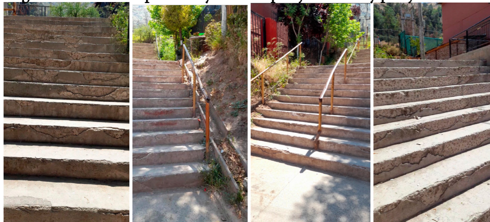
Figura 14: Deterioro pasamos y escalera pasaje el Pellín y pasaje El Laurel.
