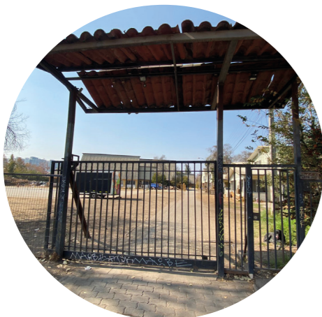
37. Infraestructura de ex Aldeas SOS en abandono
