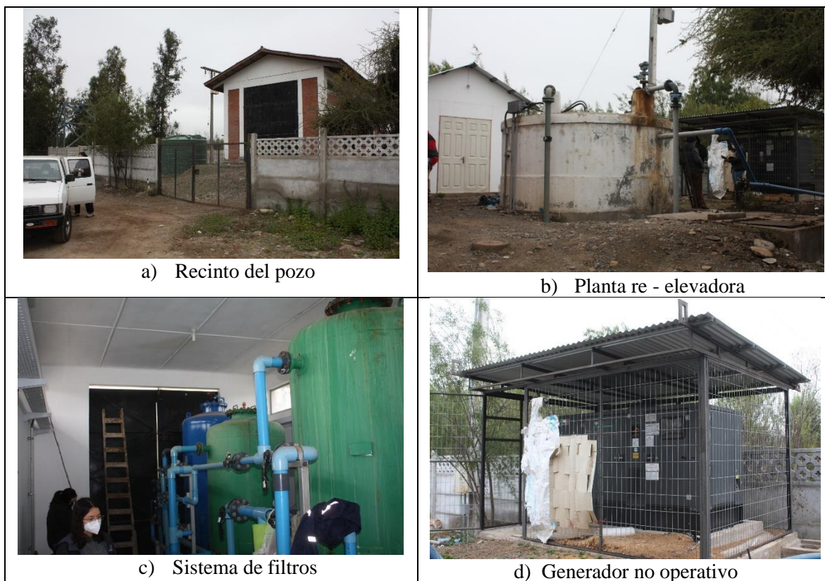
Ilustración 8. Recinto pozo-sistema tratamiento y sentina APR San Julián.
