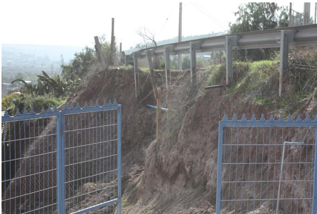
Ilustración 12. Fotografía de tramo con tubería expuesta en sector barrancas.
