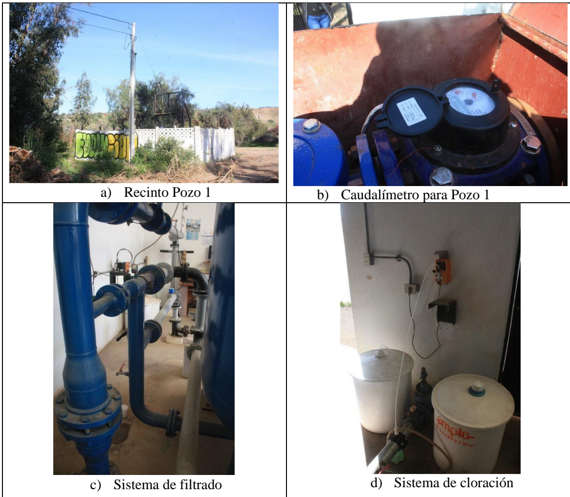
Ilustración 2. Recinto pozo 1 y elementos al interior.
