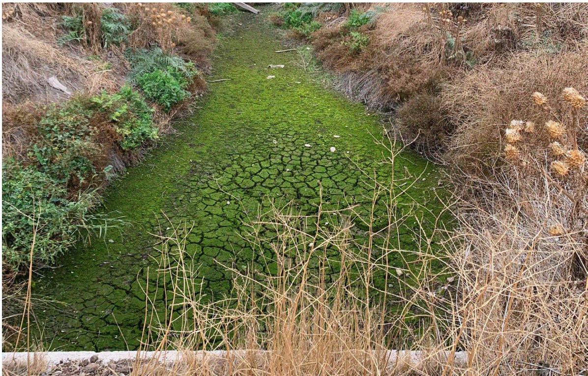
FIG. 34: ACEQUIA SECUNDARIA DEL ESTERO LAS CRUCES SIN AGUA DEBIDO A LA BASURA. FUENTE: ARCHIVO PERSONAL, 2023.
