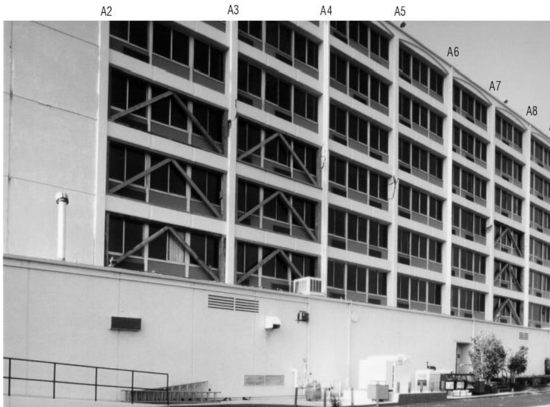
Figura 2.1 Daños en la fachada del edificio Holiday Inn de Van Nuys para el terremoto de Northridge 1994 (Trifunac y otros 1999).
