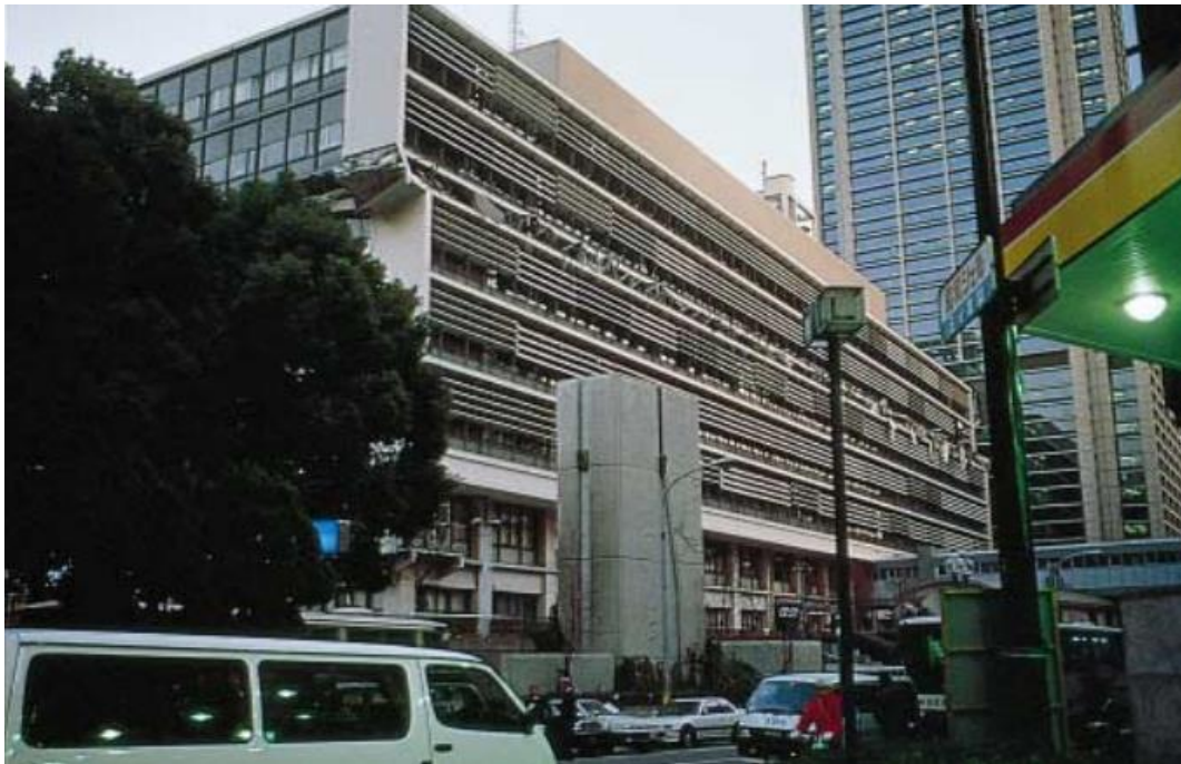
Figura 2.7 Colapso del piso #6 de un edificio de 8 pisos, de hormigón armado, construido en los años 60, fotografía de Christopher Rojahn (Holzer 1995).
