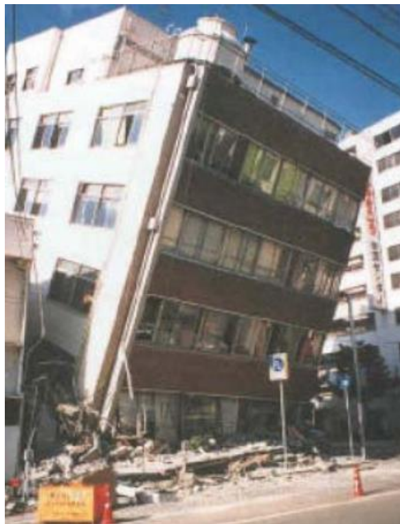
Figura 2.5 Colapso de edificio debido a la falla del primer nivel, durante el terremoto de Kobe 1995 (Astroza 2007).
