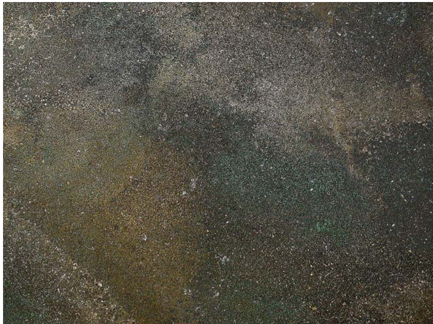
Fig.7: Fotografía que muestra la capa de productos de corrosión y sus distintos colores.
