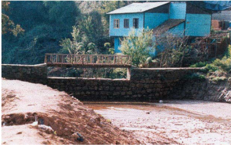
Fig. 3.1 Muro de mampostería instalado en el eje de descarga de una quebrada (calle Francia), en el casco urbano de la ciudad de Valparaíso. La obra fue construida en el año 1940 (Hauser, 2004).
