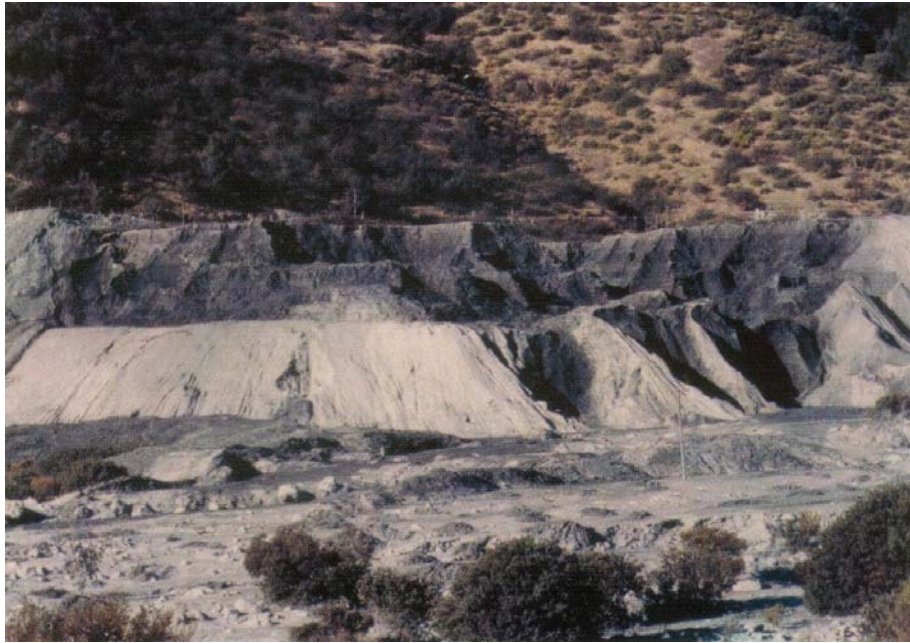
Fig. 1.4 Colapso de un muro perimétrico de depósitos de relave de la mina Cerro Negro, V Región, a causa del sismo del día 3 de Marzo de 1985. En primer plano se observa el flujo de relave (Hauser, 2000).
