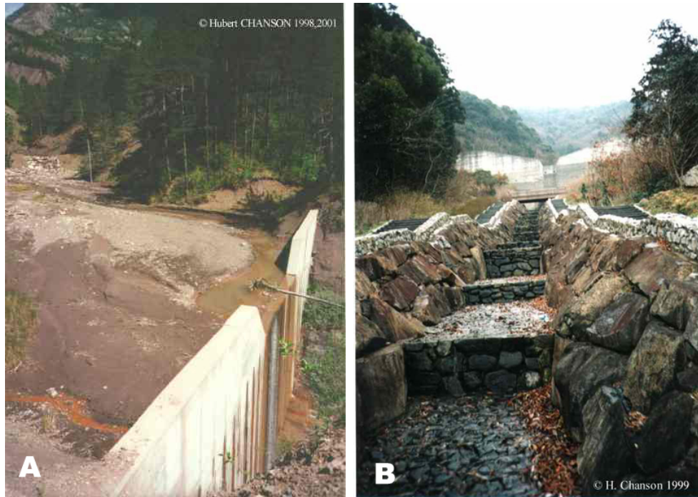
Fig. 2.10 Ejemplo de presas contenedoras. A) Presa llena de sedimentos; B) Vista del canal escalonado aguas abajo de la presa (Chanson, 2001)
