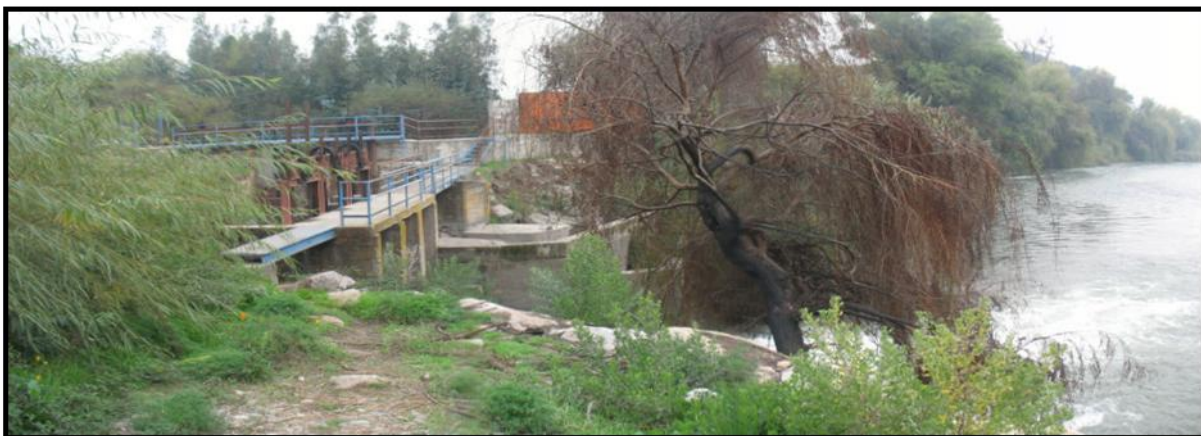
Figura 11 Compuertas Canal Almahue en la 3ª Sección del Río Cachapoal
