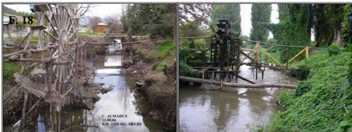
Figura 20 Ejemplos de erosión en los bordes del Canal Almahue provocado por Ruedas/Azudas
