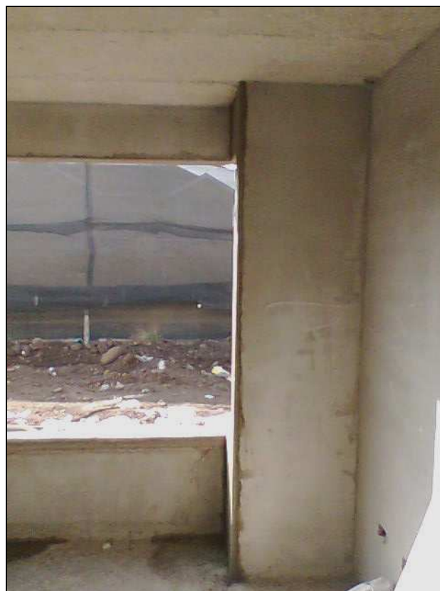
Figura 6: Fotografía lugar típico de Fisura en Albañilería (1.5 [m] de altura aprox.).
