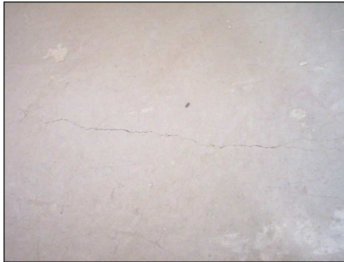
Figura 5: Fotografía Fisura en Albañilería.
