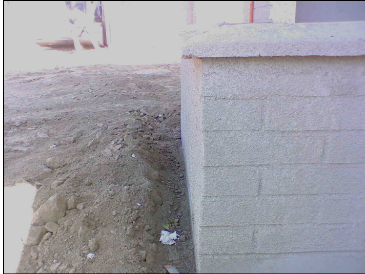
Figura 7: Fotografía Desaplomo en Albañilería.
