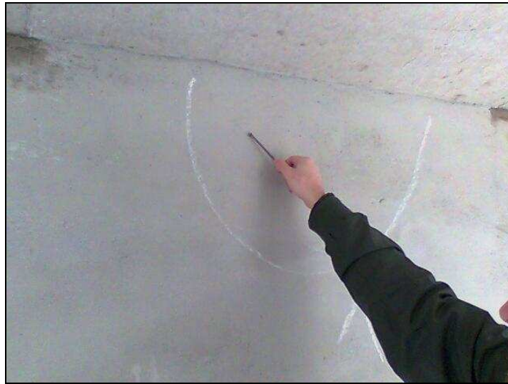
Figura 9: Fotografía Sopladura de Estuco.
