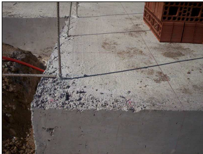
Figura 8: Fotografía Nidos de Hormigón.
