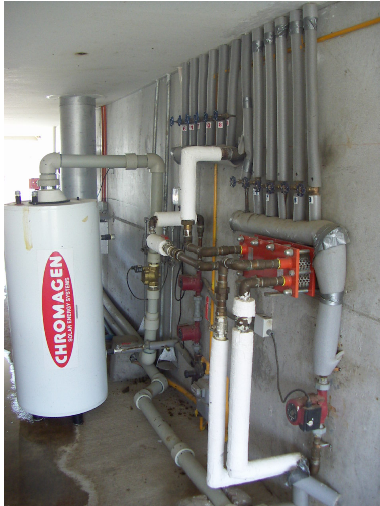
Figura 3.29: Imagen del sistema instalado, Fuente [14]
