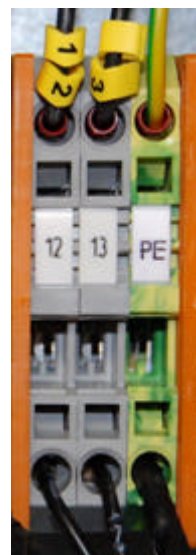
( f ) Detalle de conexión de envío de señales a servo-válvula.
