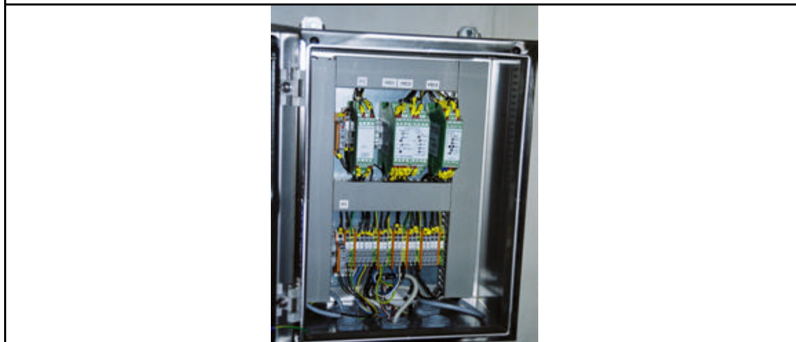
( a ) Caja de módulos eléctricos
