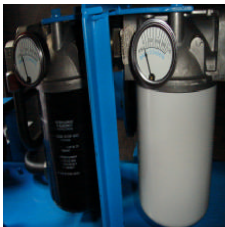
Figura 3.23. Sistema de filtrado.
