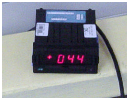
Figura 4.2. Visor de temperatura de termocupla.
