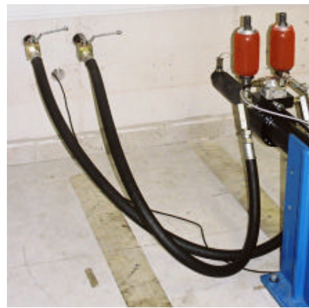
( d ) Conexión mangueras con actuador
