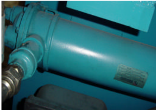
Figura 3.21. Intercambiador de calor.
