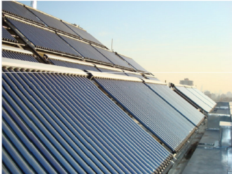
Figura 6.1: Colectores solares Edificio Amazonía
