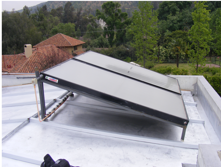
Figura 5.2: Colectores solares Vivienda Unifamiliar
