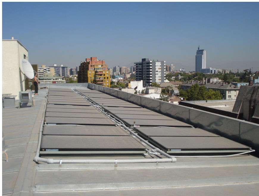
Figura 7.3: Colectores solares Edificio Spazio
