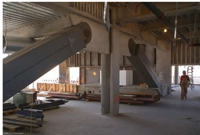
Figura 2-14. Diagonales de pandeo restringido de torre LACCHC en piso 26 [16].
