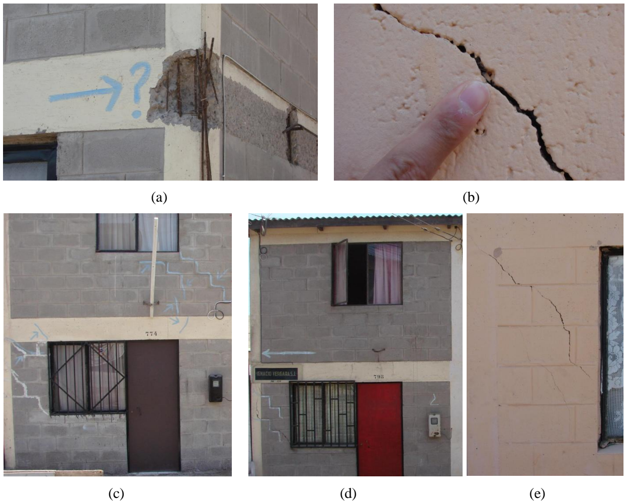
Figura 4. 69: Daño Estructural en Conjunto G.
