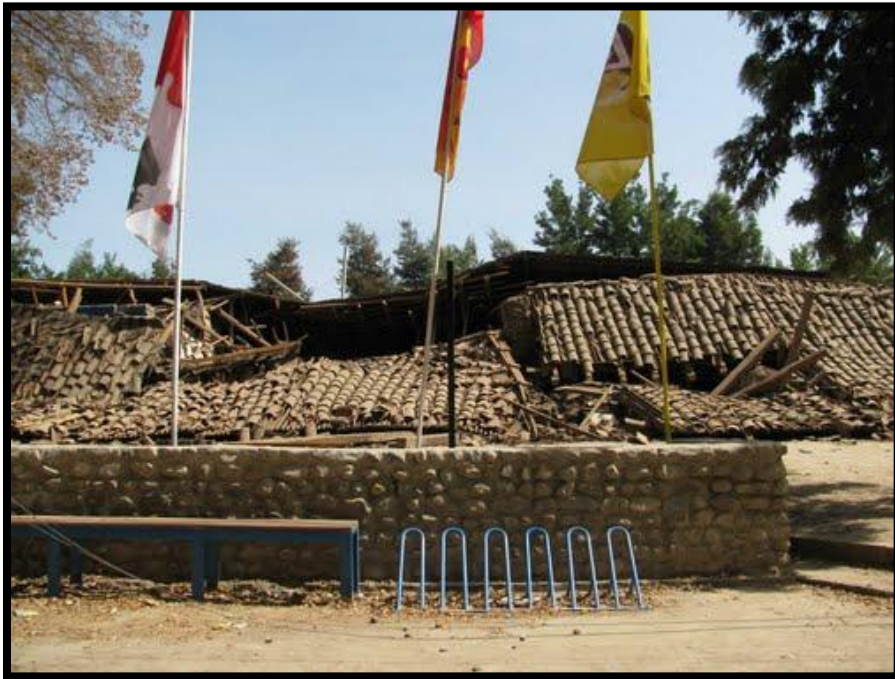
Fotografía 28. Negocio aledaño a la iglesia de Pintué. Total destrucción post terremoto del 2010. (Fuente: Panoramio.com).
