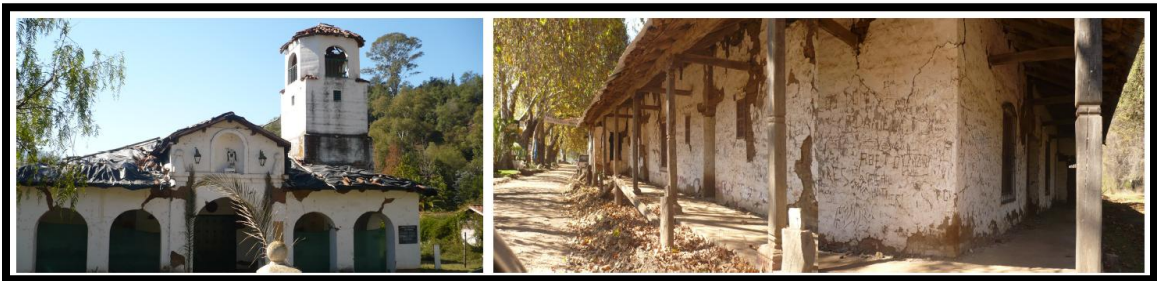
Fotografía 36. Monumentos Históricos de Rangue, construcciones de adobe después del terremoto 2010, Capilla de Rangue y Casa esquina de Rangue, con daños severos en sus estructuras.
