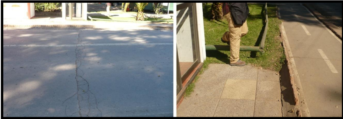
Fotografía 9. Grietas generadas por el terremoto del 2010. Camino principal, Pintué. (Fotografías a más de 1 año ocurrido el terremoto 2010)
