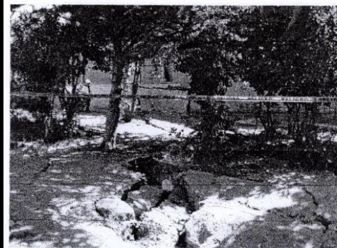
GRIETAS EN TERRENO
