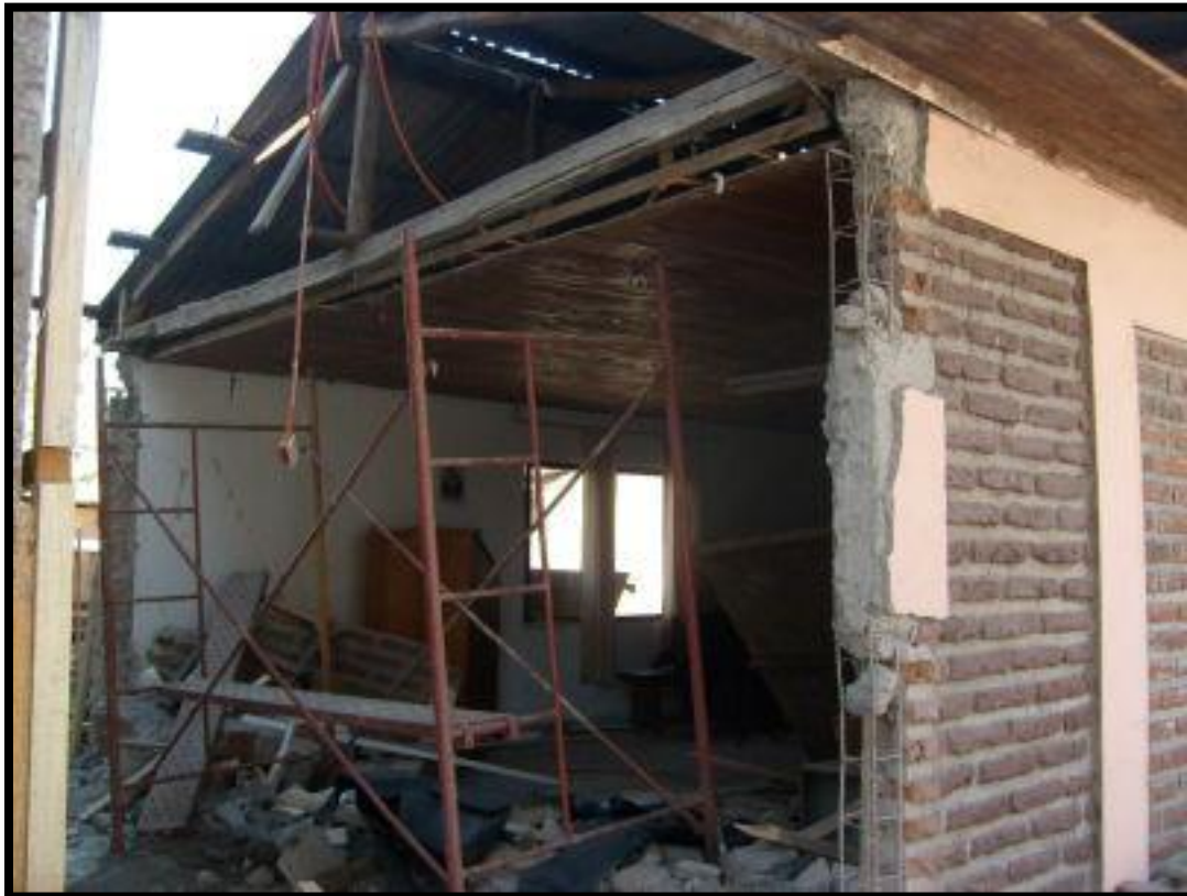
Fotografía 34. Casa de albañilería dañada por el terremoto del 2010, en Valdivia de Paine. (Fuente: valdiviadepaine.es.tl )
