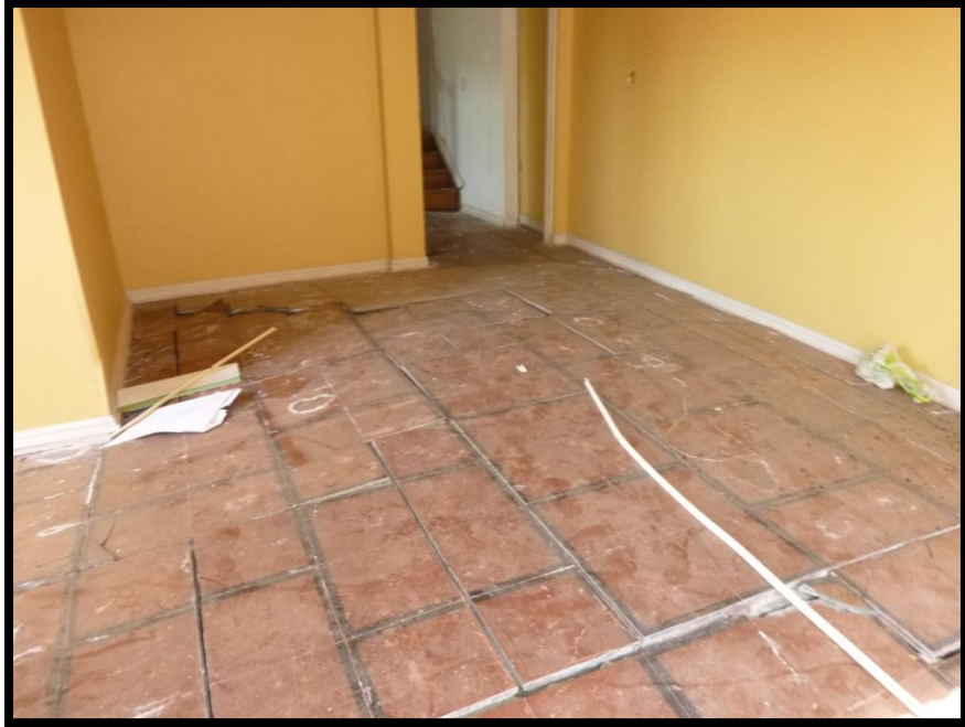
Fotografía 25. Emersión del piso en casa cercana la capilla de Abrantes, producto del asentamiento generado por el terremoto del 2010. (Fotografía: Javiera González)
