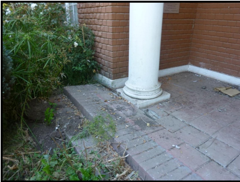
Fotografía 20. Entrada de la capilla de Abrantes, asentamiento de la estructura. A la fecha, (2011) todavía se puede observar la presencia de agua en superficie. (Fotografía: Javiera González)
