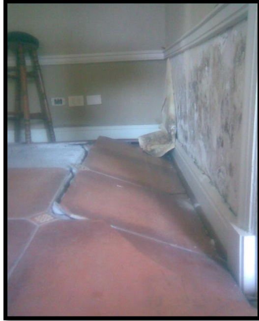
Fotografía 27. Asentamiento interior de casa patronal, cercana a la empresa de Champiñones Abrantes, generado por el terremoto del 2010. (Fotografía: Ilustre Municipalidad de Buin).
