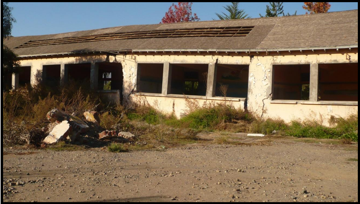
Fotografía 15. Daño severo en salas y pabellón de la Escuela Elías Sánchez Ortúzar, Champa, generado por el terremoto 2010. Vista norte del pabellón afectado por las grietas.
