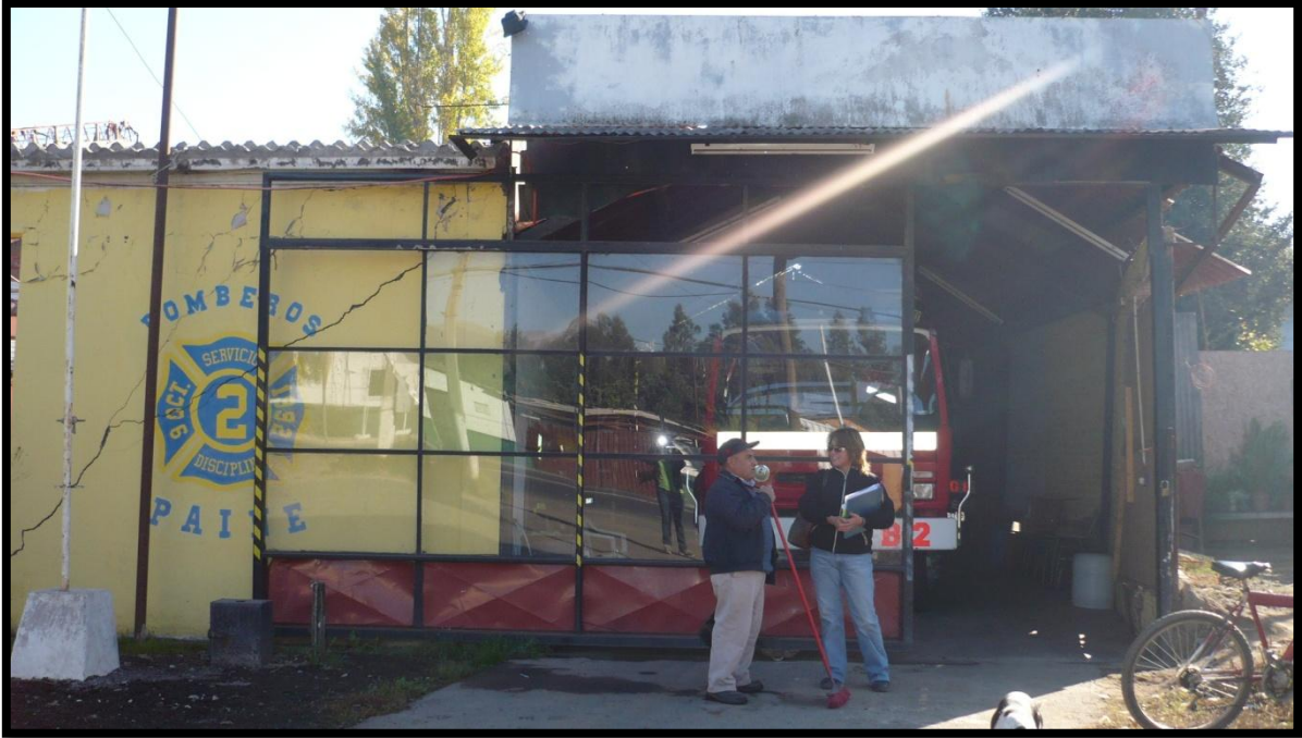
Fotografía 17. Bomberos de la localidad de Champa, afectados por grietas en murallas y suelo, generadas por el terremoto del 2010.
