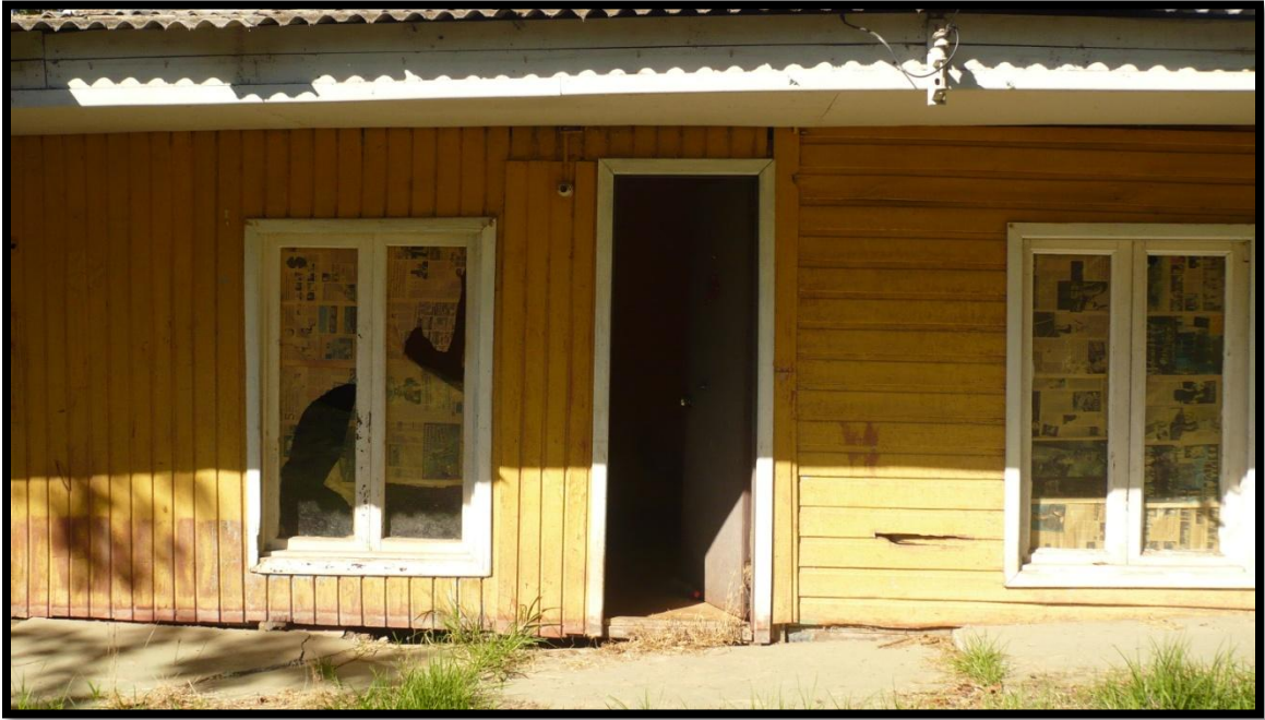
Fotografía 31. Casa aledaña a la comisaria de Carabineros de Pintué, la cual sufrió asentamiento debido al terremoto del 2010.
