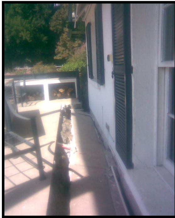
Fotografía 26. Asentamiento producto de grietas generadas por el terremoto del 2010, en casa patronal cercana a la empresa de Champiñones Abrantes. (Fotografía: Ilustre Municipalidad de Buin).
