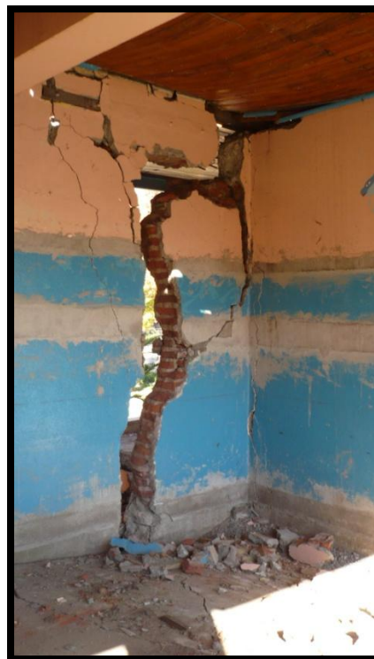
Fotografía 14. División de uno de los pabellones de la edificación existente, generado en el terremoto 2010. Asentamiento de la edificación. Escuela Elías Sánchez Ortúzar, Champa.
