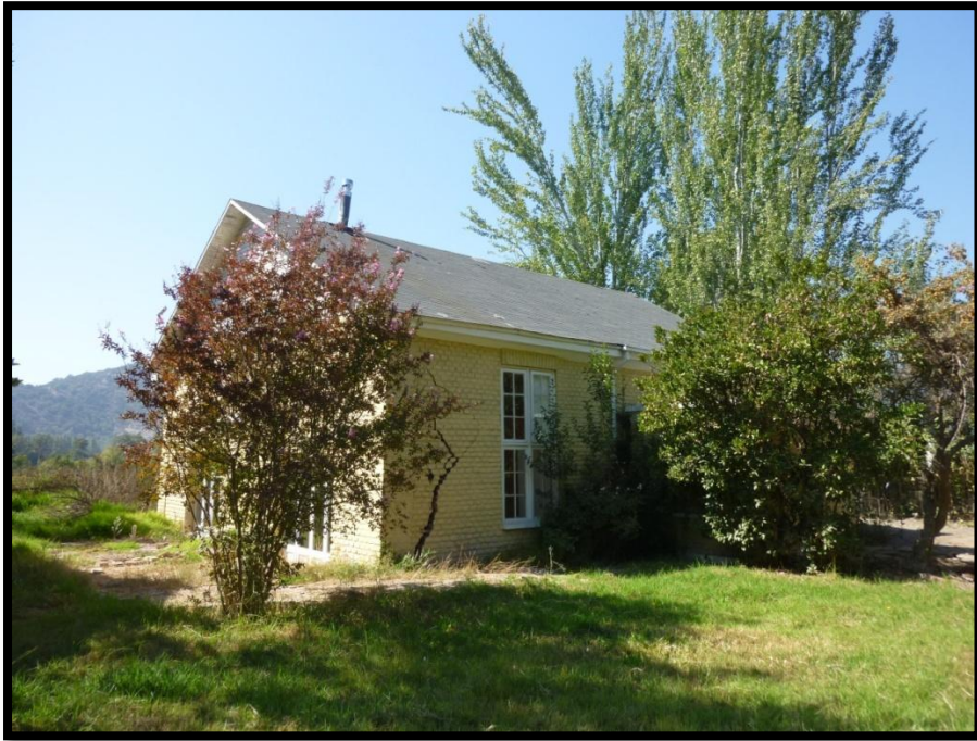
Fotografía 23. Daño y asentamiento producto del terremoto del 2010, en una casa cercana la capilla de Abrantes. (Fotografía: Javiera González).
