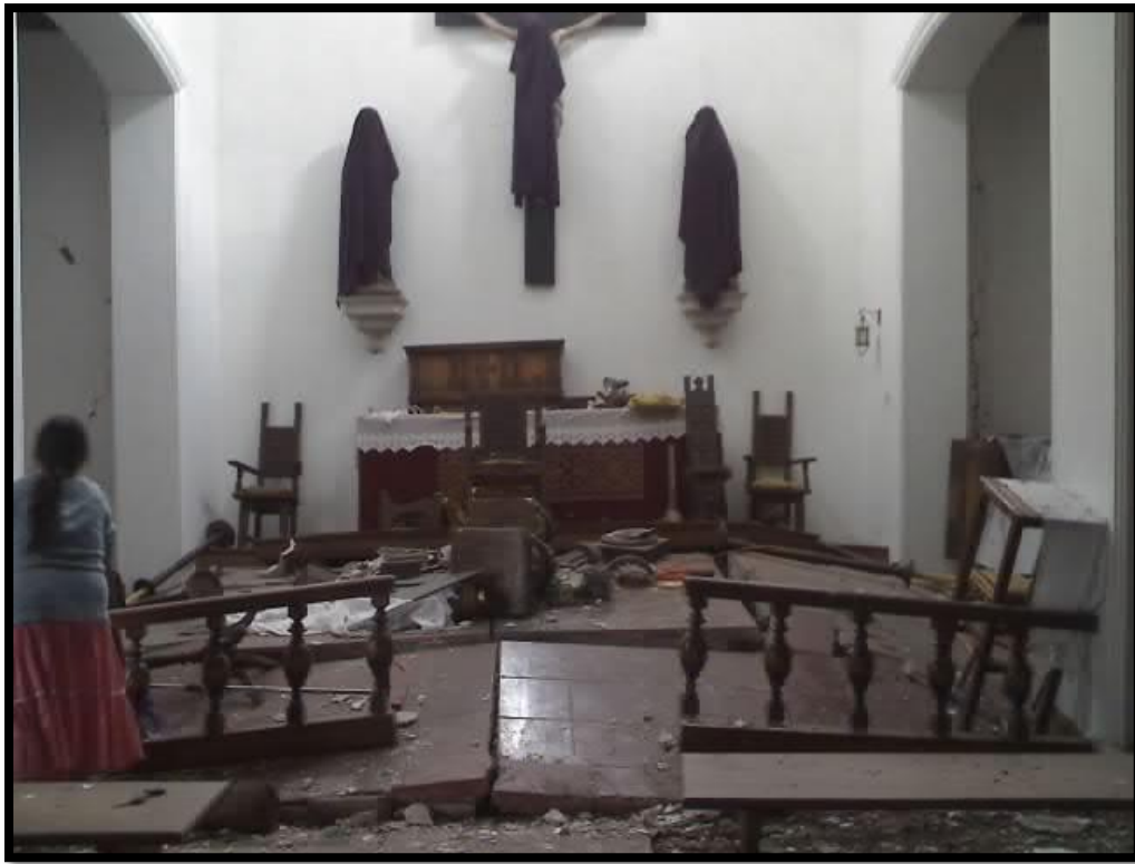
Fotografía 22. Interior de la capilla de Abrantes, el daño observado corresponde a la emersión del piso producto del asentamiento de la edificación. (Fotografía: Javiera González).
