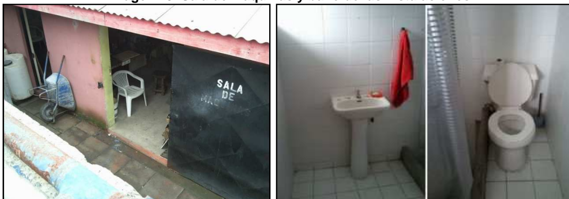
Imagen 15 Sala de Máquinas y baño de las instalaciones
