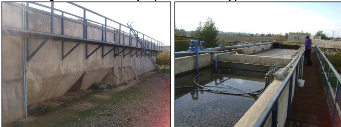
Imagen 22 Vista elevación y en planta de reactores y pasarela de la PTAS
