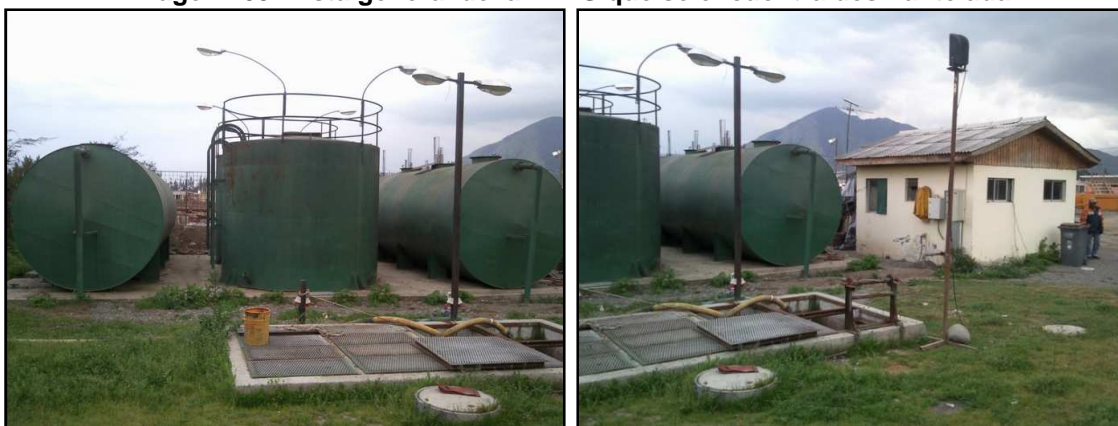
Imagen 109 Vista general de la PTAS que se encuentra desmantelada
