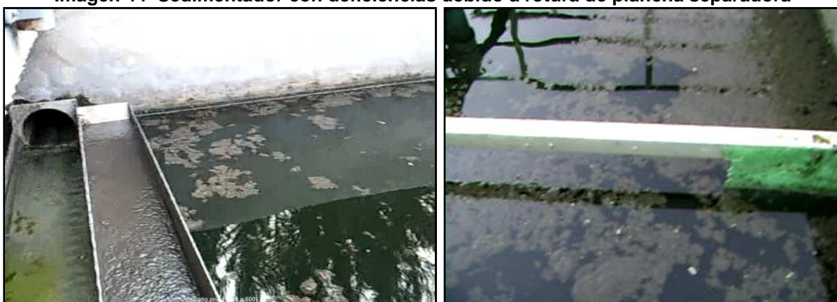
Imagen 44 Sedimentador con deficiencias debido a rotura de plancha separadora
