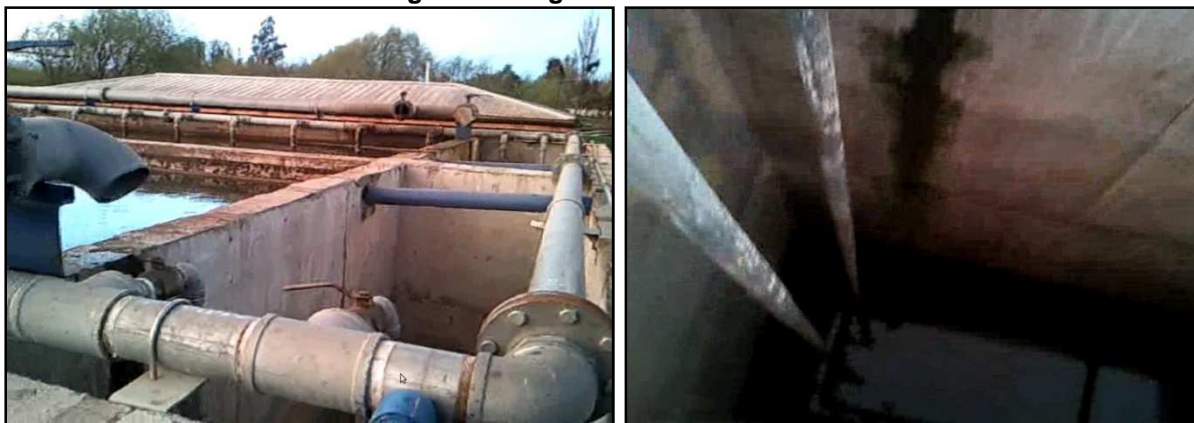
Imagen 121 Digestor aireado de lodos
