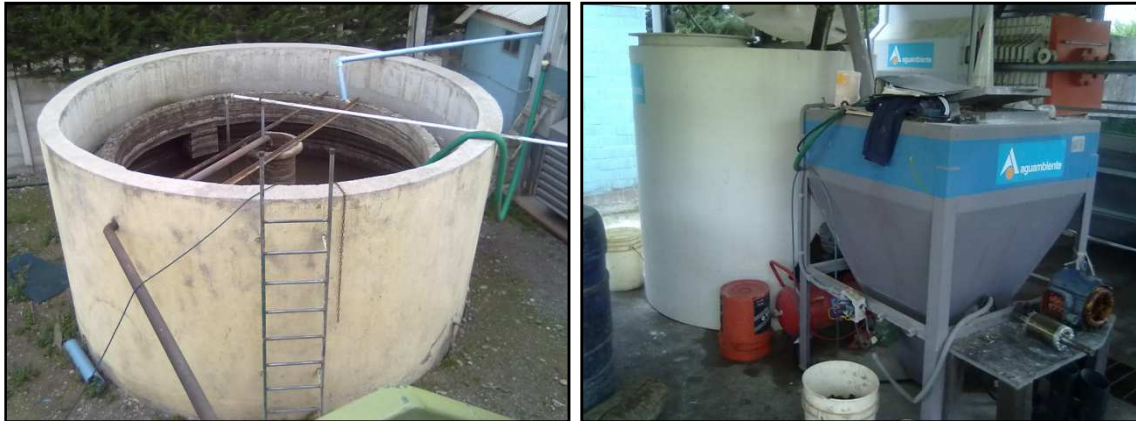
Imagen 107 Espesador, Digestor y Tanque de mezcla
