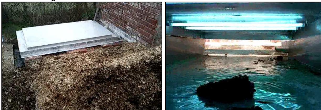
Imagen 66 Vista exterior e interior de cámara de contacto de desinfección
