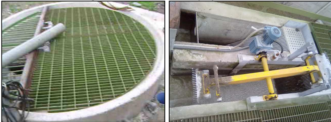
Imagen 100 Planta de elevación y reja mecánica
