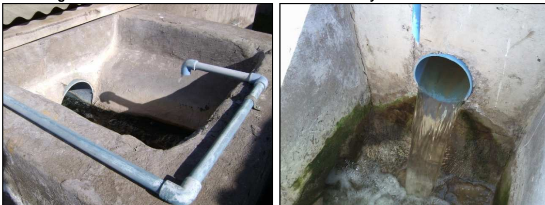
Imagen 37 Unidad de adición de cloro diluido y unidad de dechloración
