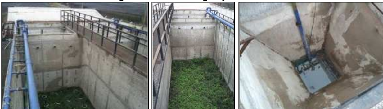
Imagen 14 Reactor biológico y sedimentador
