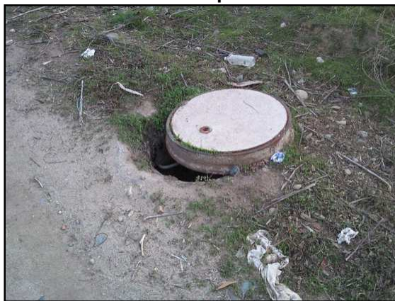
Imagen 39 Problema con sello de tapas de cámaras de alcantarillado
