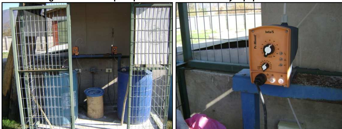
Imagen 35 Bidones para proceso de dosificación y equipos de bombeo
