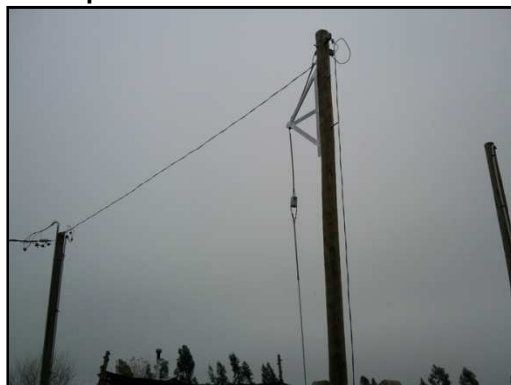
Imagen 20 Poste que sostiene el tendido eléctrico hacia la PTAS
