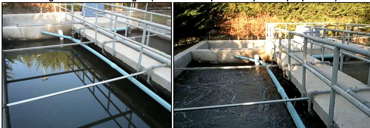
Imagen 43 Reactor Biológico (2 Unidades en paralelo separadas por pasarela)
