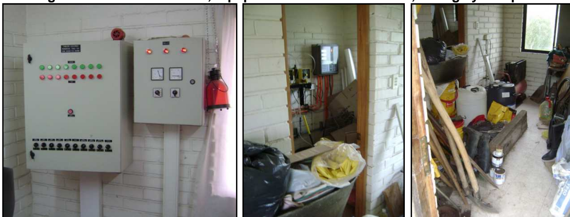
Imagen 93 Tablero eléctrico, equipamiento de desinfección, bodega y compresor
