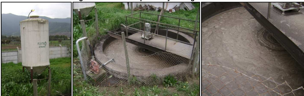
Imagen 78 Vista del Espesador y del Digestor de lodos
