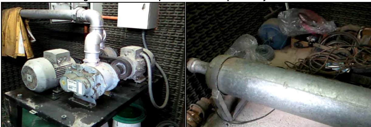
Imagen 47 Sala de máquinas con dos sopladores y silenciador
