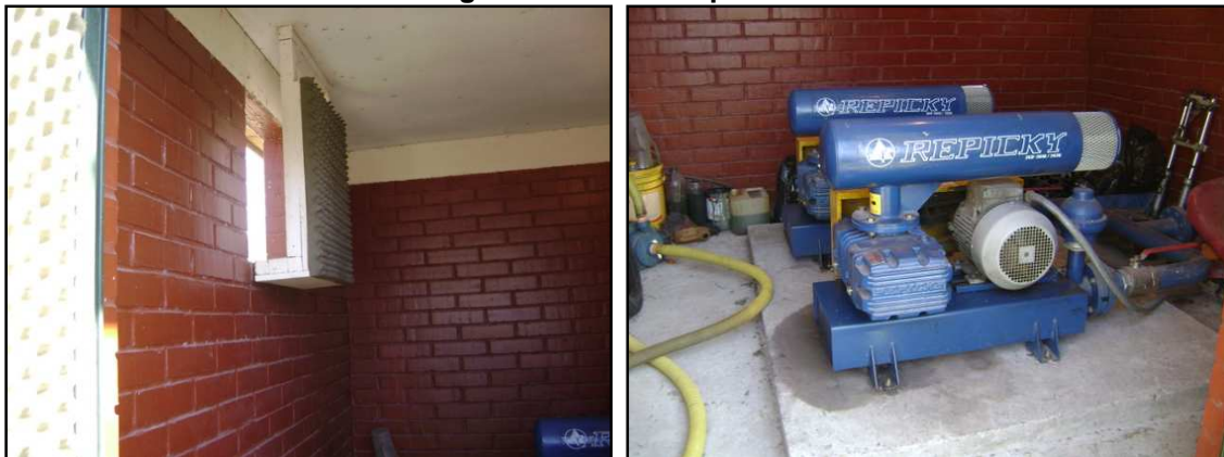
Imagen 34 Sala de sopladores
