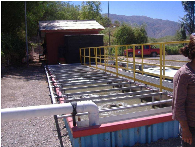
Cámara decantación y separación
