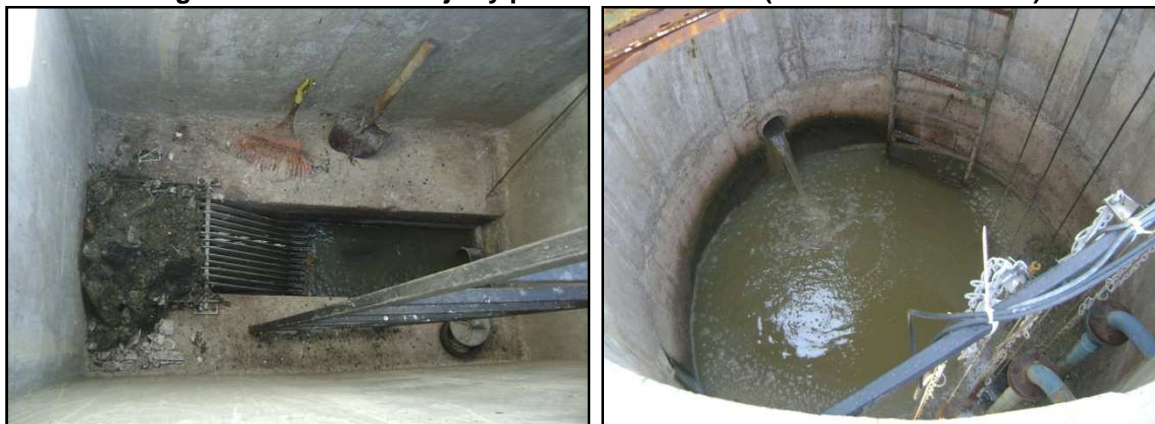
Imagen 28 Cámara de rejas y planta de elevación (Estación de bombeo)
