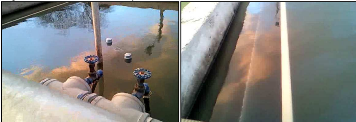
Imagen 117 Vista del sedimentador y rebalse en vertedero de salida hacia cámara de desinfección
