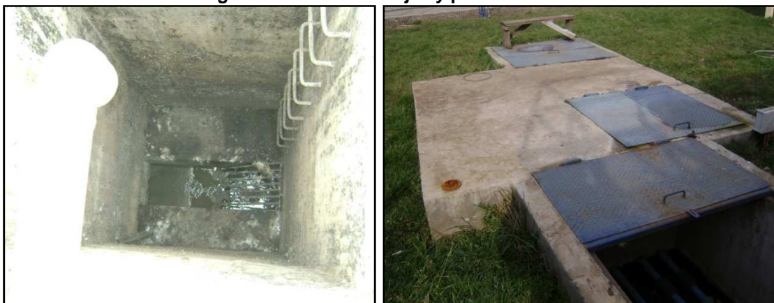
Imagen 21 Cámara de rejas y planta elevadora
