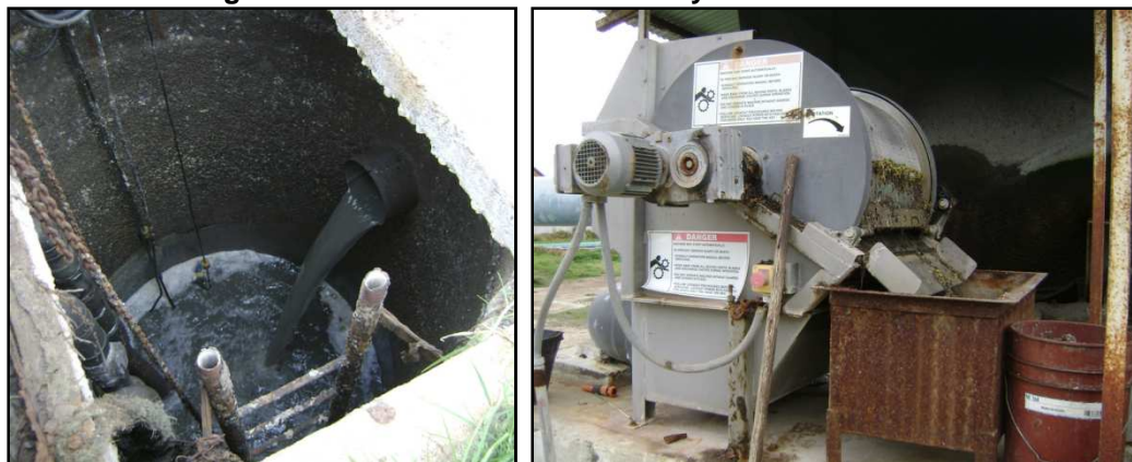
Imagen 72 Vista de Planta elevadora y Filtro rotatorio fino
