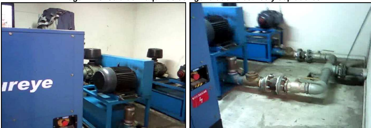
Imagen 118 Sala de máquinas con generador eléctrico y sopladores
