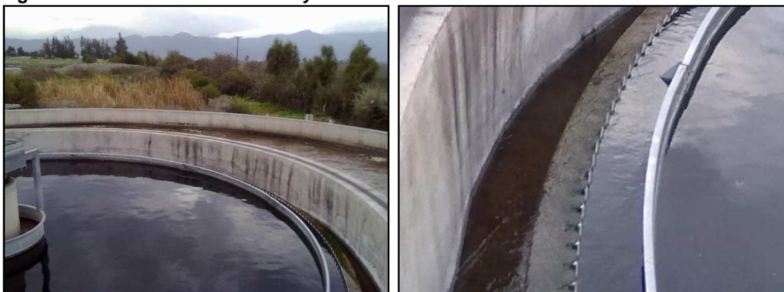
Imagen 103 Vista del sedimentador y del efluente clarificado en el vertedero del sedimentador
