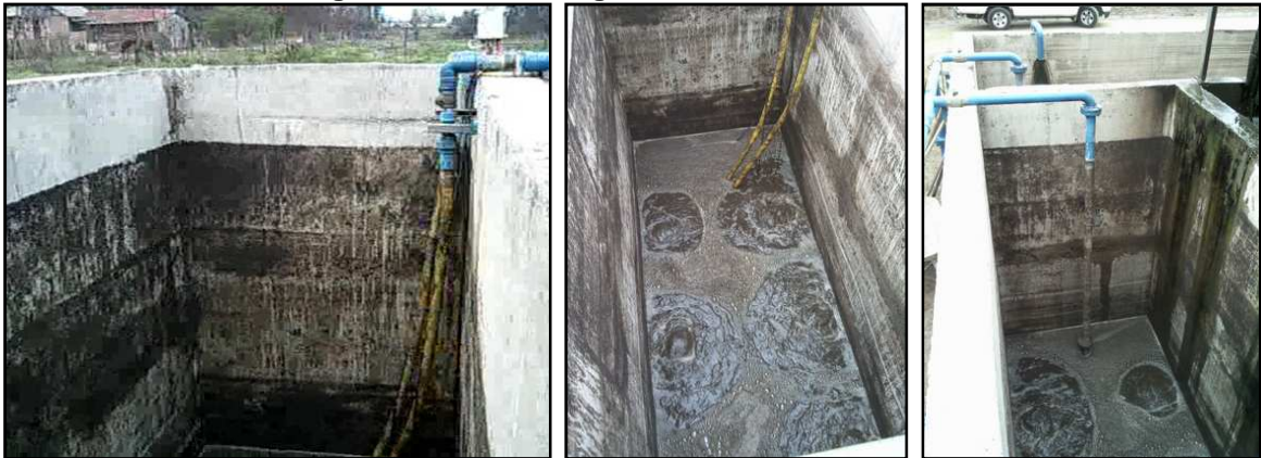
Imagen 59 Vista del digestor de lodos en aireación
