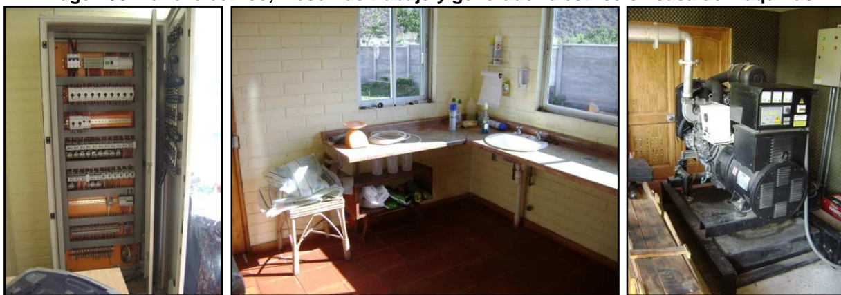
Imagen 33 Panel eléctrico, mesón de trabajo y generador eléctrico en casa de máquinas
