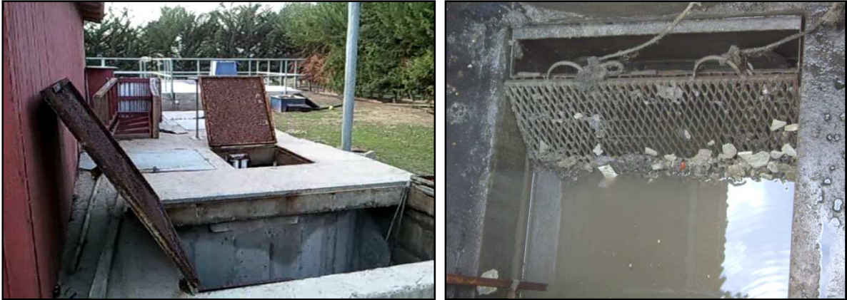
Imagen 40 Cámaras de inspección de rejas y estación de bombeo, detalle de reja
