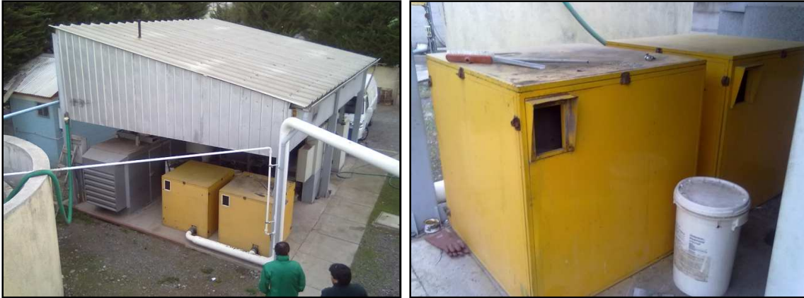
Imagen 104 Casa de máquinas con generador y 2 sopladores
