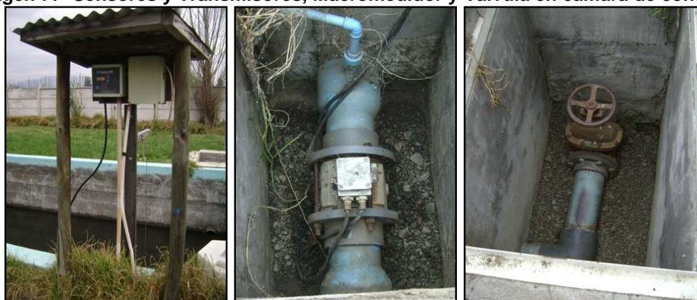
Imagen 77 Sensores y Transmisores, Macromedidor y Válvula en cámara de contacto
