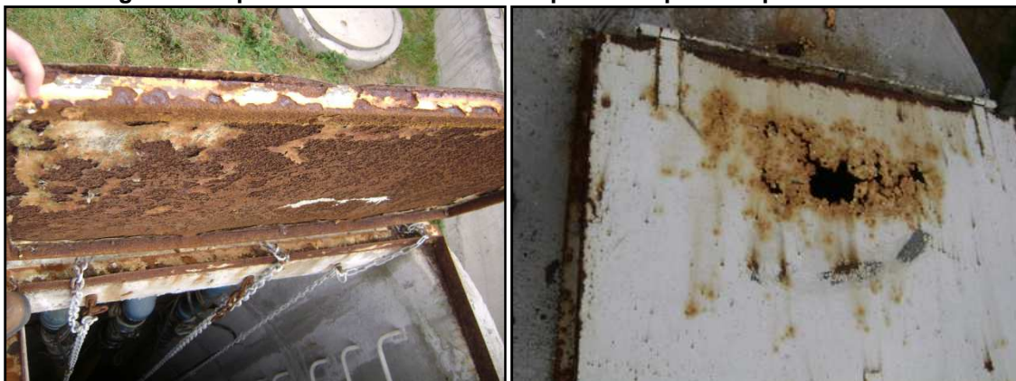
Imagen 82 Tapa metálica en mal estado que cubre pozo de planta elevadora
