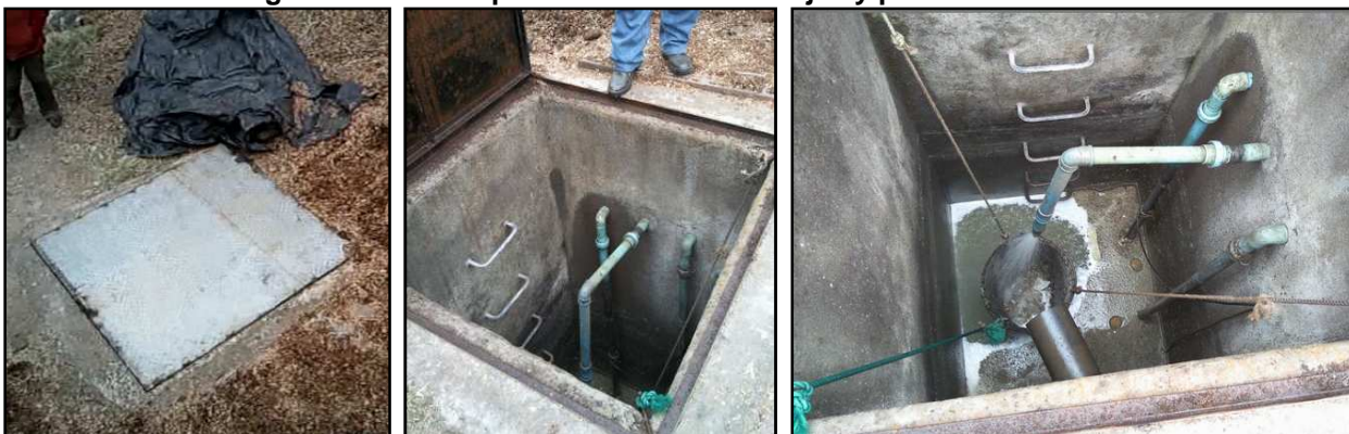
La reja (canastillo) y las bombas de elevación se ubican juntas en la misma cámara.
