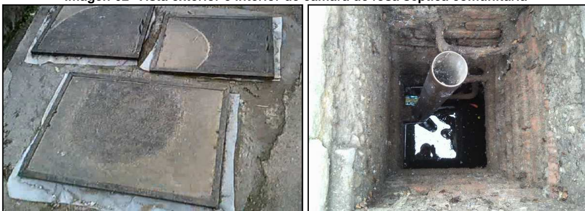
Imagen 62 Vista exterior e interior de cámara de fosa séptica comunitaria
