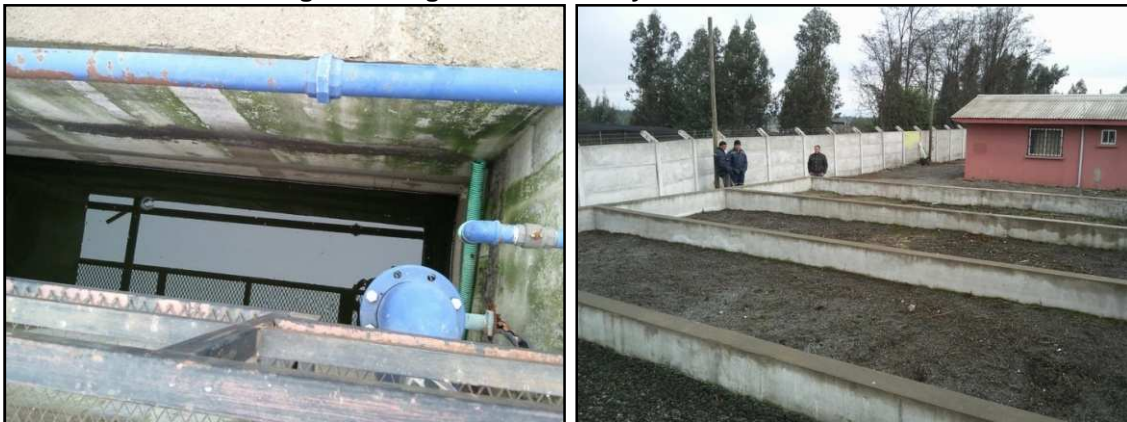
Imagen 19 Digester de lodos y cancha de secado
