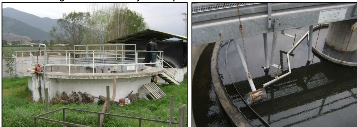
Imagen 75 Vista lateral y de la superficie del Sedimentador secundario
