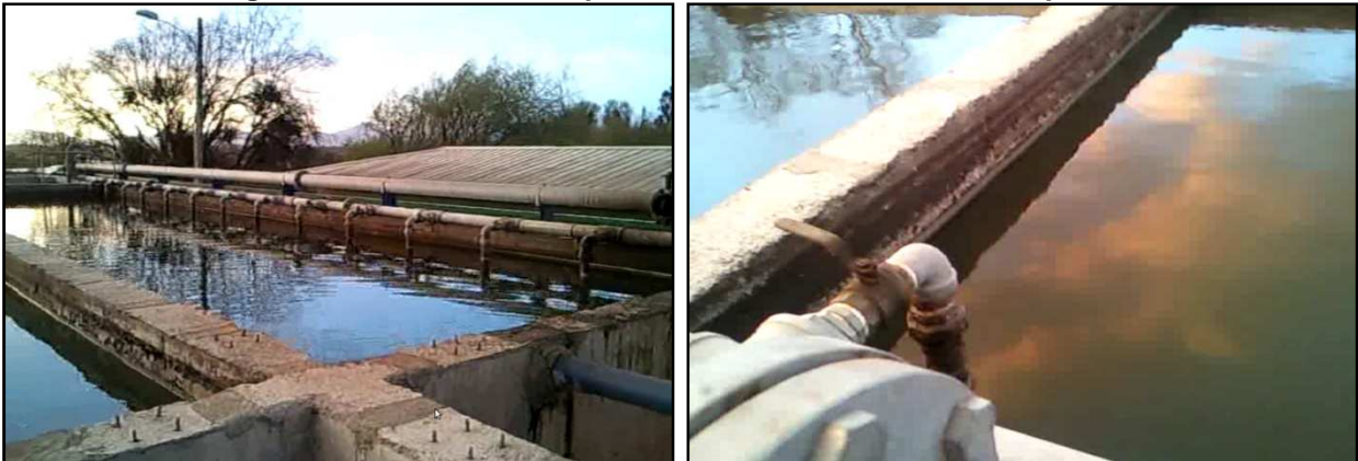
Imagen 116 Vista del estanque de aireación detenido en su operación
