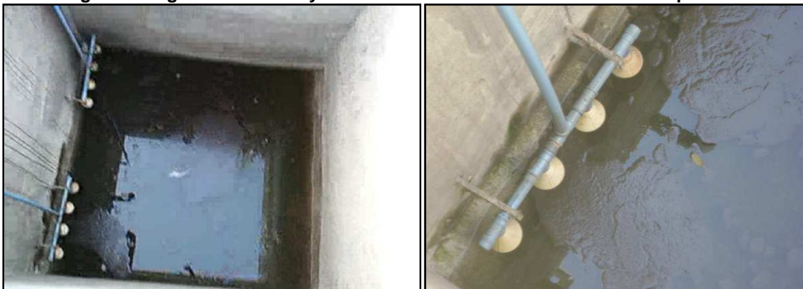
Imagen 49 Digestor de lodos y difusores de aire con tubería de PVC en parte final
