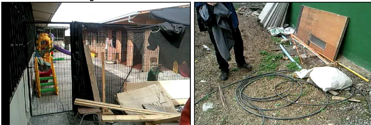
Imagen 97 Vista alrededor de las instalaciones de la PTAS
