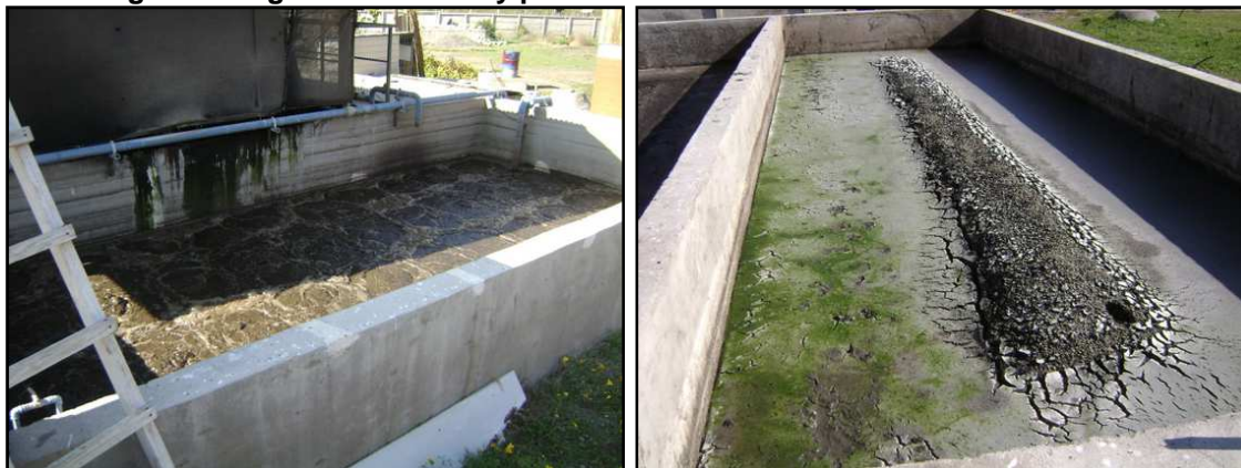
Imagen 32 Digestor de lodos y primera sección de cancha de secado de lodos
