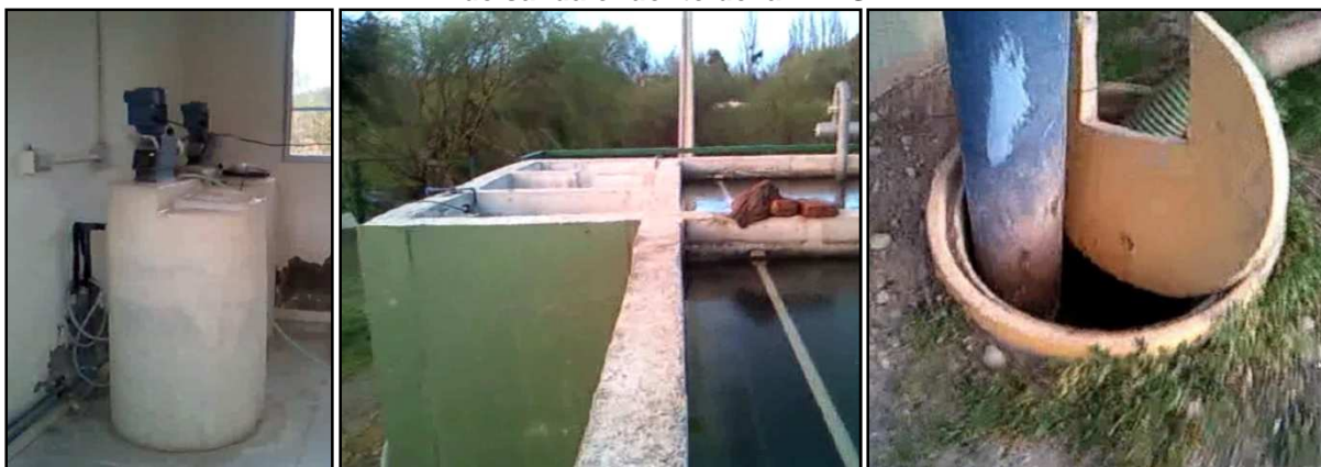
Imagen 120 Bidones para dosificación de desinfectante, cámara de contacto desinfección y punto de salida efluente de la PTAS
