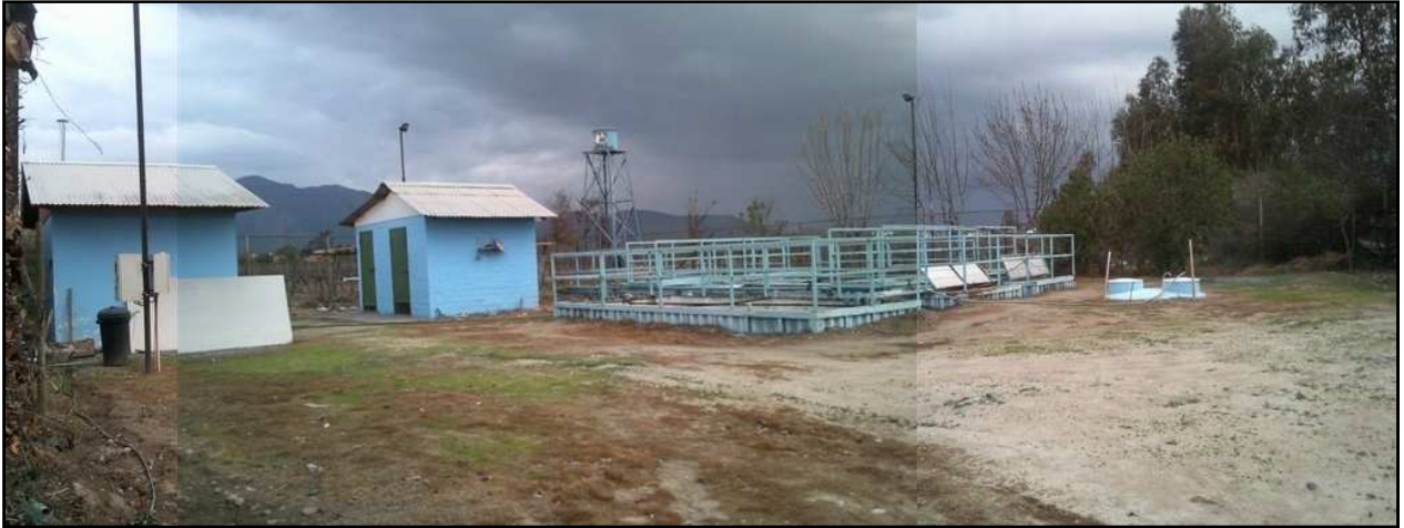
Imagen 112 Vista lateral de las instalaciones de la Planta de Tratamiento de Aguas Servidas
