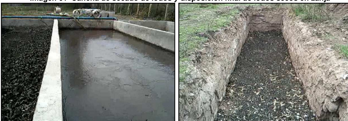
Imagen 61 Cancha de secado de lodos y disposición final de lodos secos en zanja
