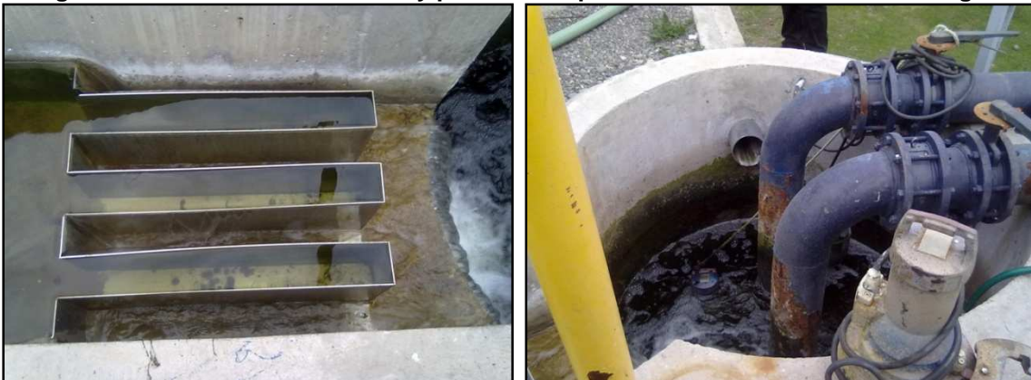
Imagen 106 Efluente desinfectado y planta de impulsión del efluente a canal de regadío
