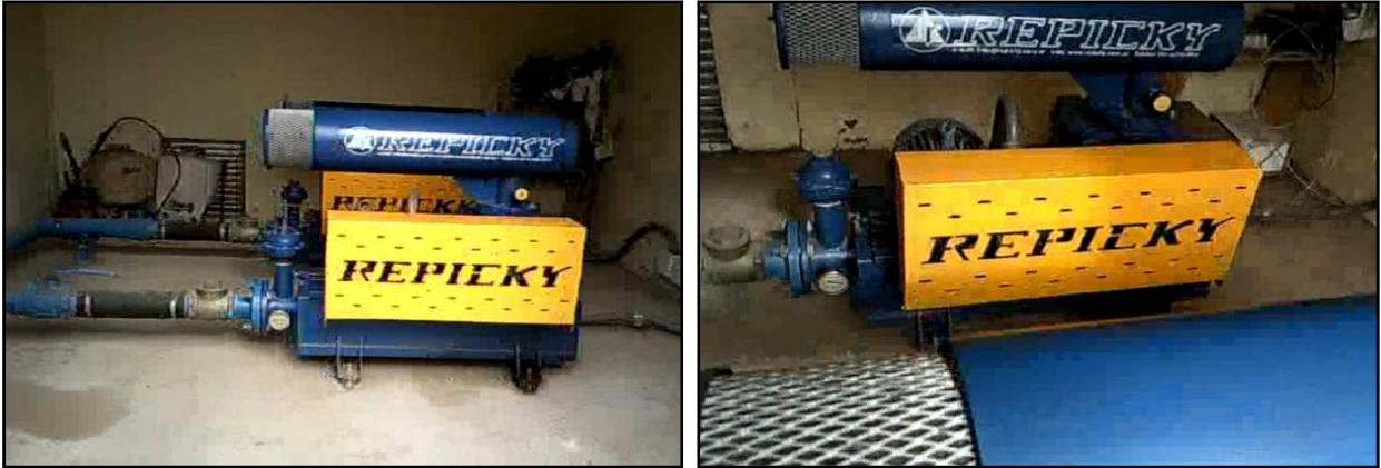
Imagen 56 Sopladores en la casa de máquinas
