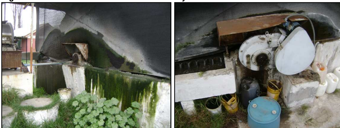
Imagen 73 Vista de la cubierta de Malla Raschel y rotor del Biodisco con vertedero de salida
