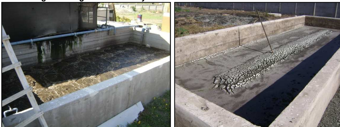
Imagen 38 Digestor de lodos y último sector de cancha de secado de lodos
