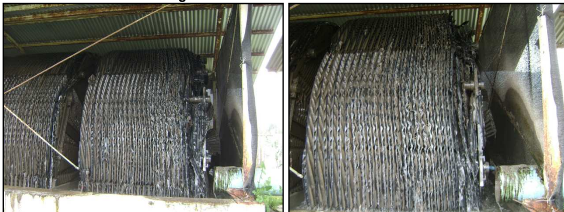
Imagen 74 Vista del disco en mal estado
