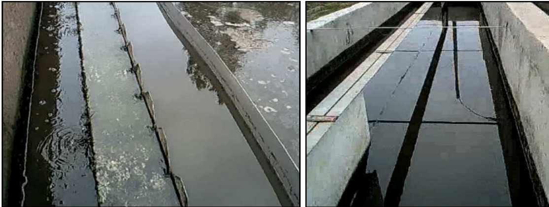
Imagen 57 Vertedero de salida del sedimentador y entrada a cámara de contacto desinfección
