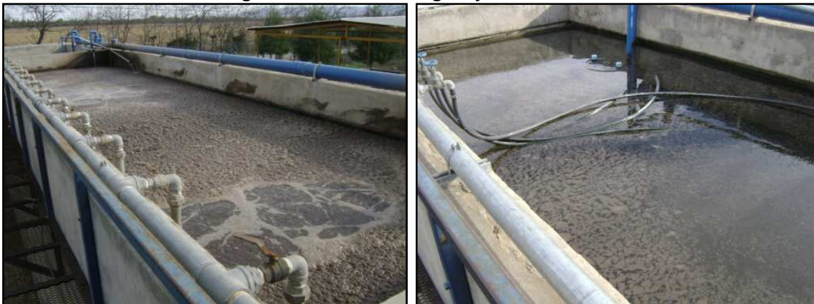
Imagen 23 Reactor Biológico y Sedimentador
