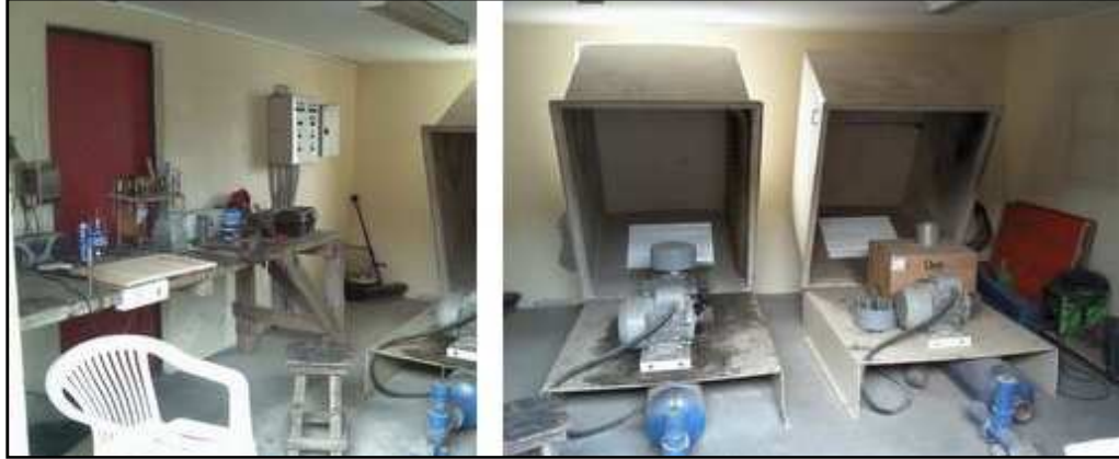
Imagen 16 Sala de Sopladores
