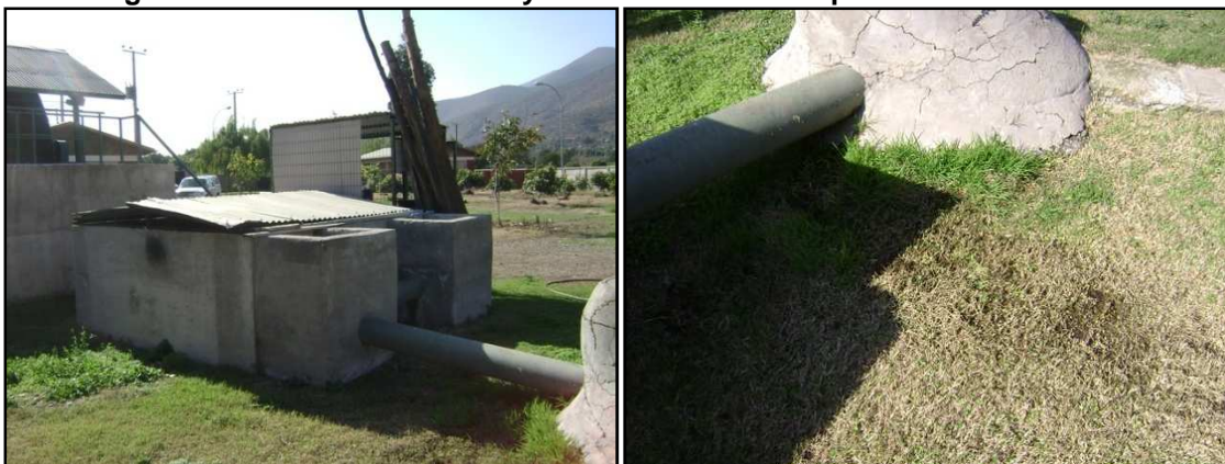
Imagen 36 Cámara de contacto y filtración en cámara posterior a desinfección
