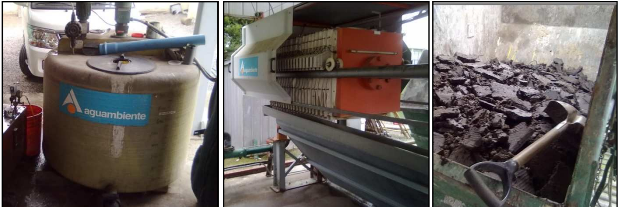
Imagen 108 Estanque de almacenamiento de cal, prensa de lodos y lodos deshidratados
