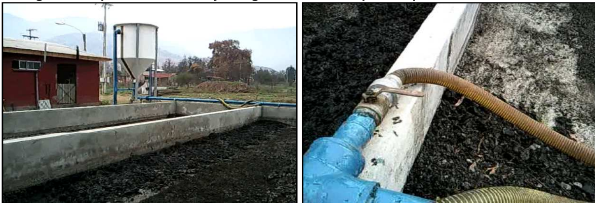
Imagen 60 Espesador de lodos y mangueras utilizadas para disposición de lodos en cancha
