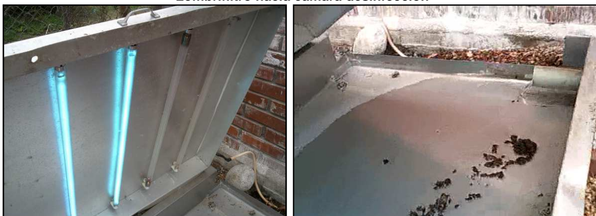
Imagen 67 Vista interior de cámara de desinfección, con tubos ultravioleta y tubería efluente de Lombrifiltro hacia cámara desinfección
