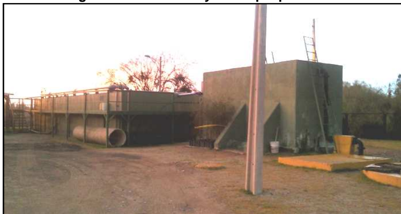
Imagen 114 Vista general de la PTAS y estanque previo al reactor biológico
