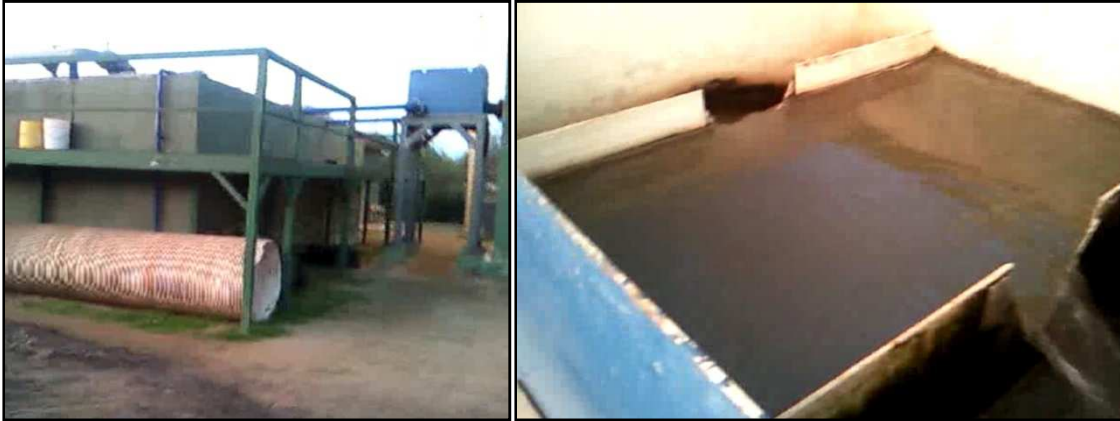
Imagen 115 Vista de la cámara de repartición previa al reactor biológico
