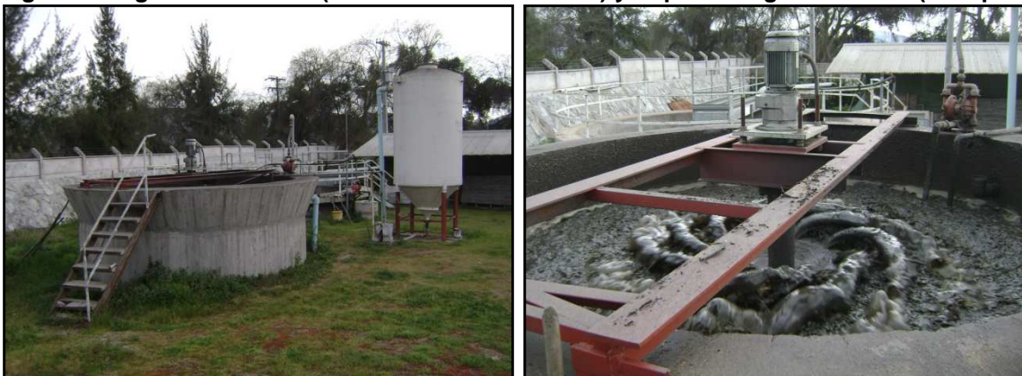
Imagen 91 Digestor aeróbico (aireado mecánicamente) y Espesador gravitacional (sin operar)
