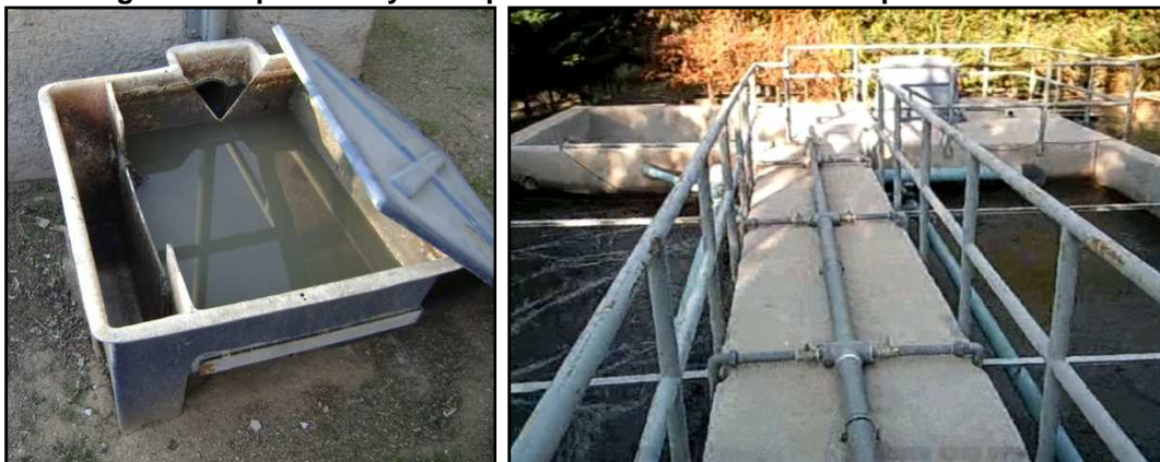
Imagen 42 Aquietador y vista planta de tratamiento desde pasarela central
