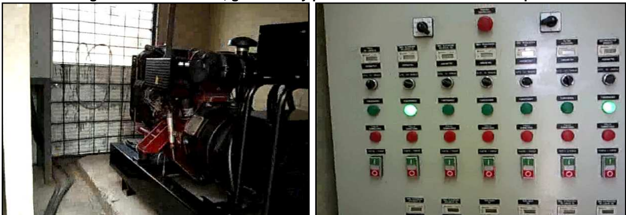
Imagen 55 Toma de aire, generador y panel eléctrico en la casa de máquinas
