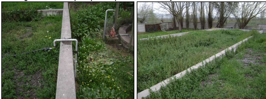
Imagen 79 Llave de paso para disposición de lodos y cancha de secado de lodos
