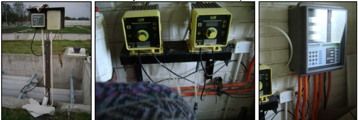
Imagen 88 Transmisor y Sensor en cámara de contacto, bombas dosificadoras y controlador cloración y dechloración en casa de máquinas
