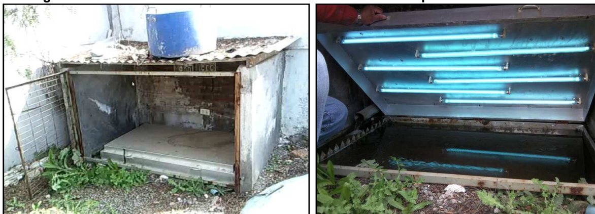
Imagen 98 Vista exterior e interior de cámara de desinfección por radiación ultravioleta
