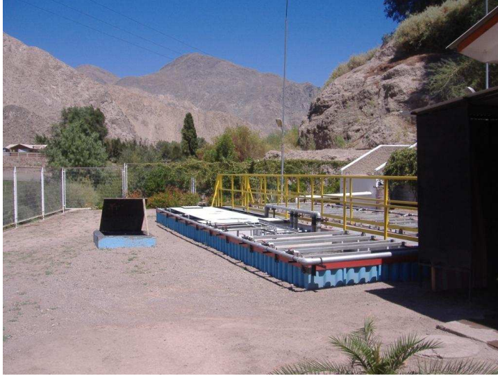
Cámara de Cloración y repartición
