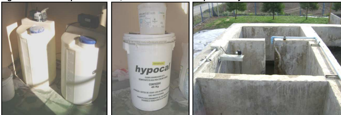
Imagen 26 Bidones para dilución, almacenamiento de químicos y vista de cámara de contacto
