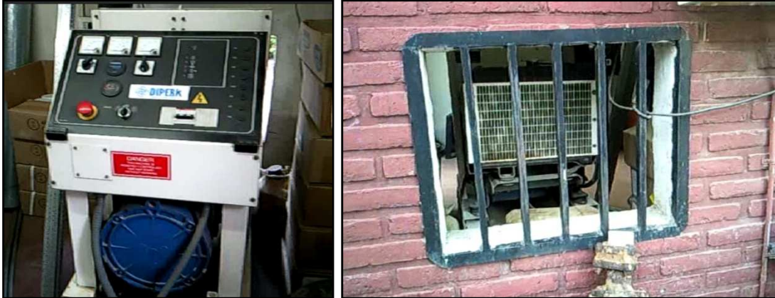
Imagen 45 Generador eléctrico y toma de aire
