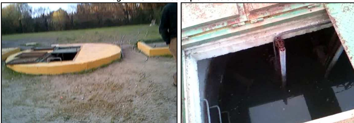
Imagen 113 Vista de la planta de elevación
