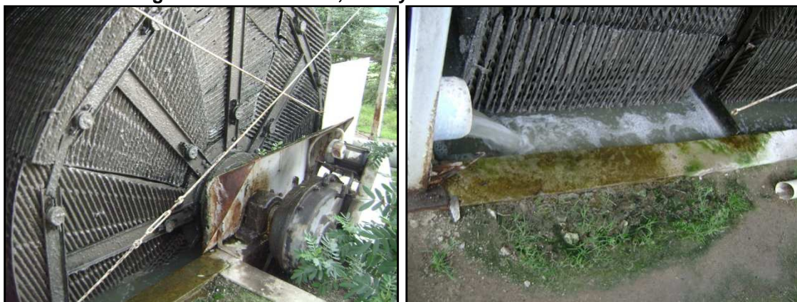
Imagen 84 Primer disco, rotor y tubería de afluente al Biodisco
