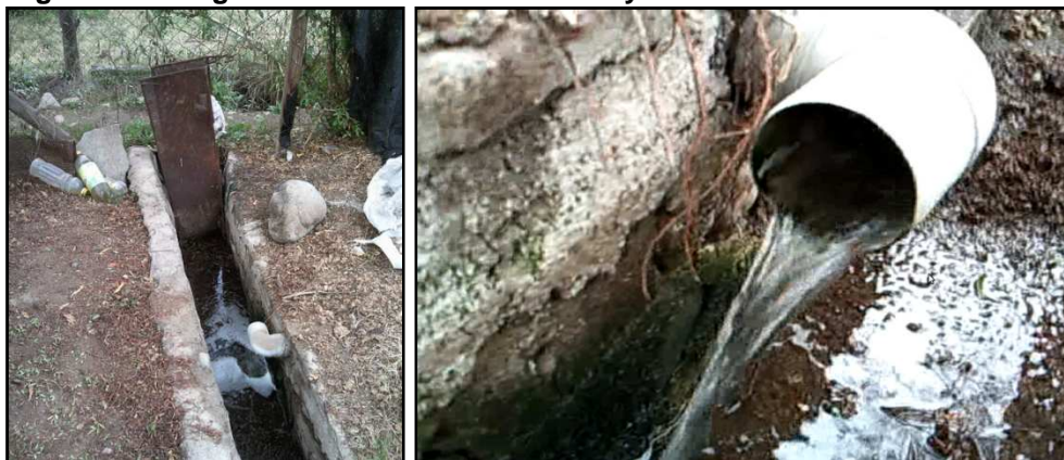
Imagen 68 Desagüe de Planta de Tratamiento y tubería de efluente desinfectado
