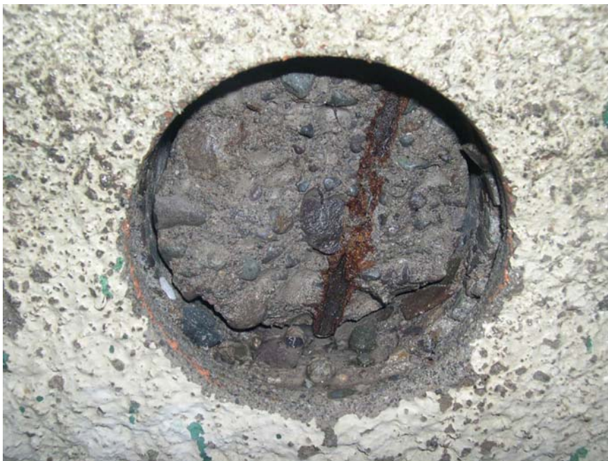
Foto N°50 : Testigo sacado de viga con fierro corroído
