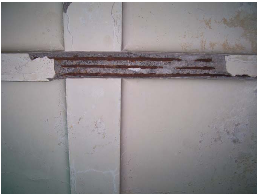
Foto N°16 : Viga con corrosión avanzada
