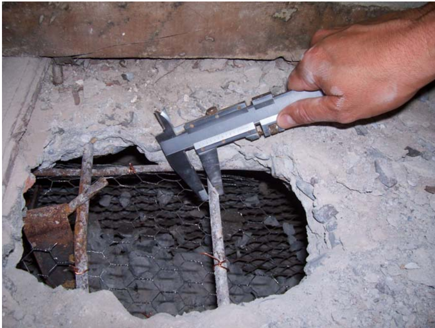
Foto N°77 : Vista losa sala de Títulos y Grados. Fierros con corrosión.
