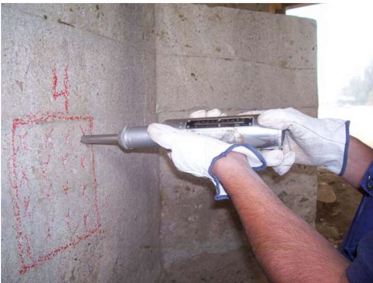
Foto N° 5: Ejemplo de utilización Martillo Schmidt Puente Quillota
