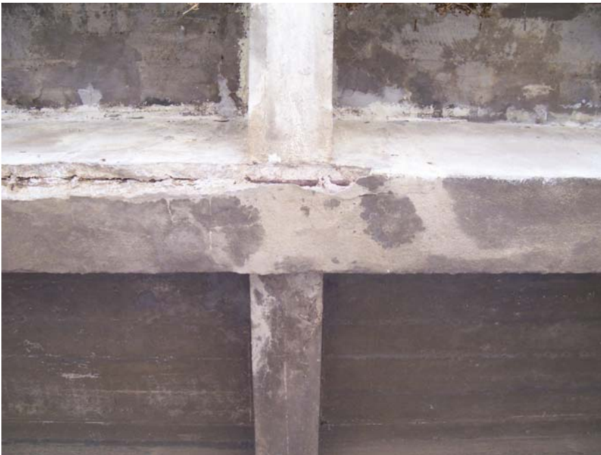
Foto N°32 : Vista viga corroída
