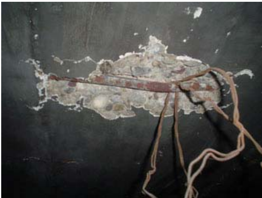
Foto N° 74: Losa sala 3-sur con barras corroídas
