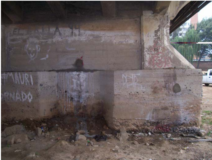
Foto N° 19: Cepa ensayada en dos puntos y posteriormente reparada
