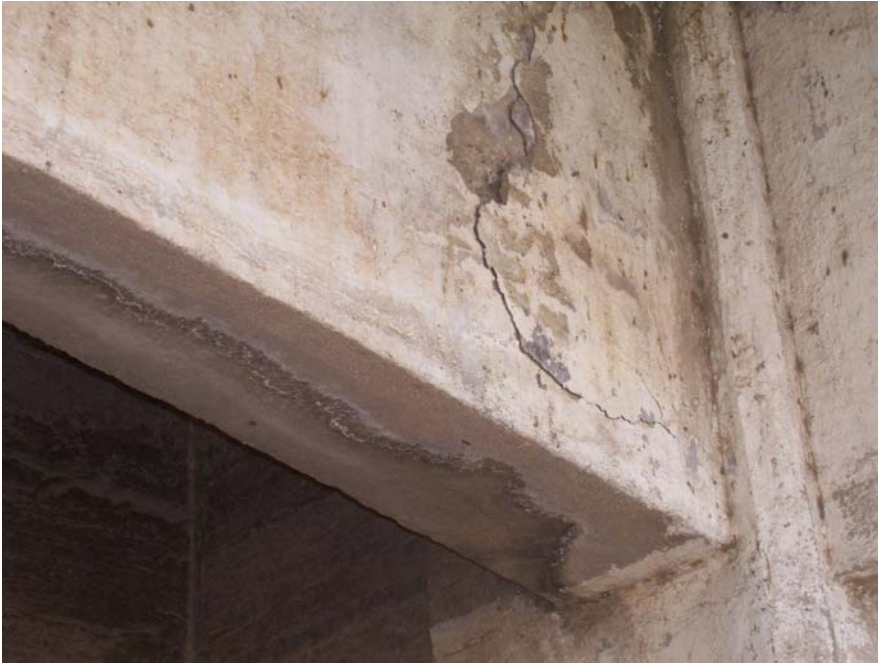
Foto N°31 : Vista viga agrietada
