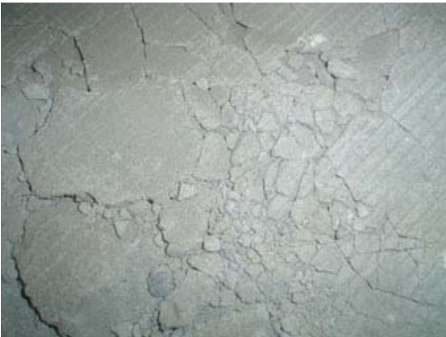
Foto N°72 : Losa sala 18-sur con grietas
