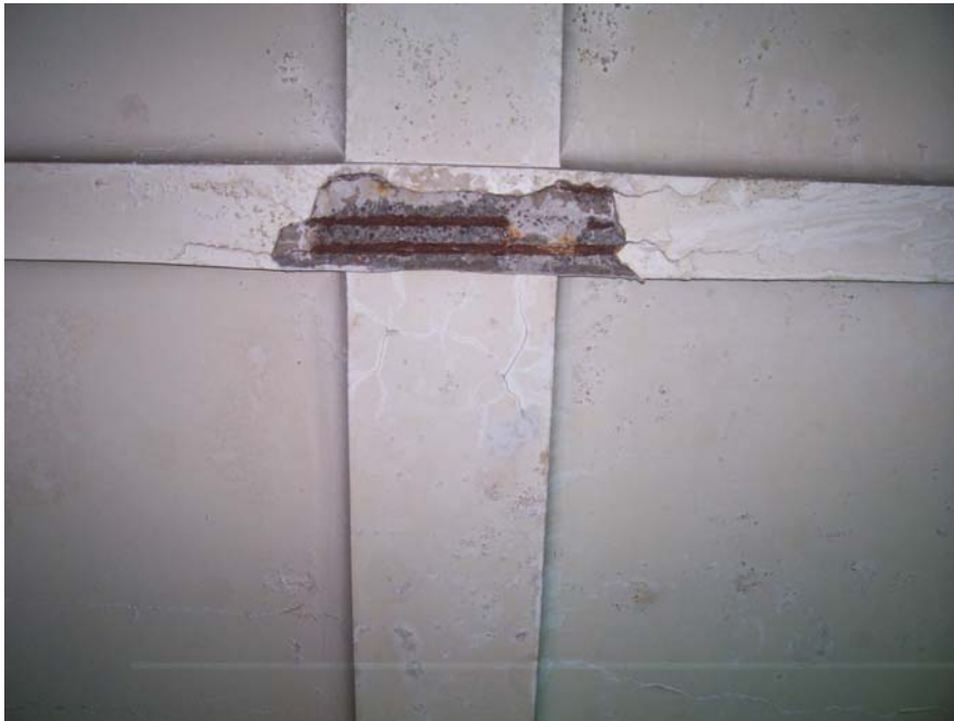
Foto N° 17: Viga con corrosión avanzada
