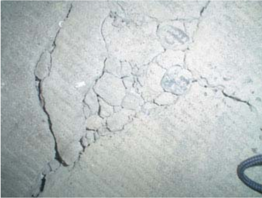
Foto N°71 : Losa sala 18-sur con grietas
