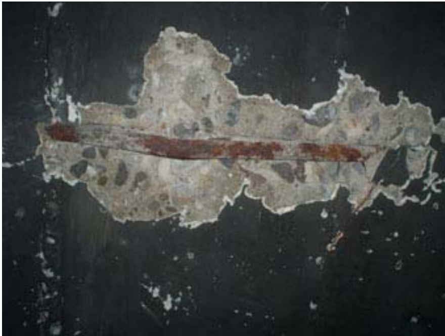
Foto N°75 : Losa sala 3-sur con barras corroídas
