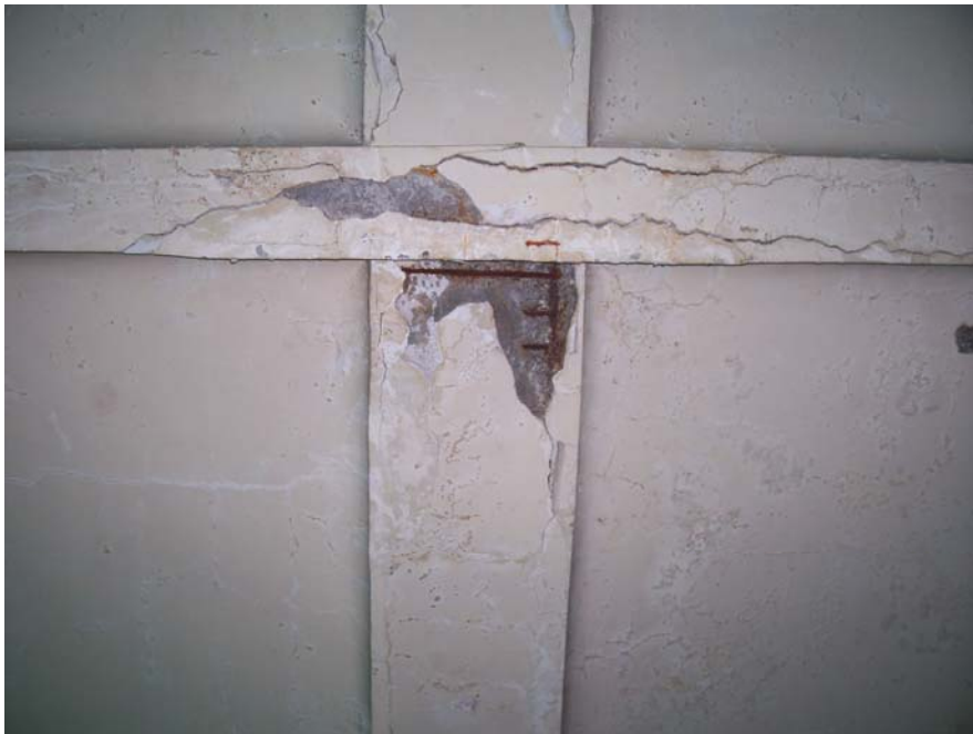
Foto N° 15: Viga con corrosión avanzada
