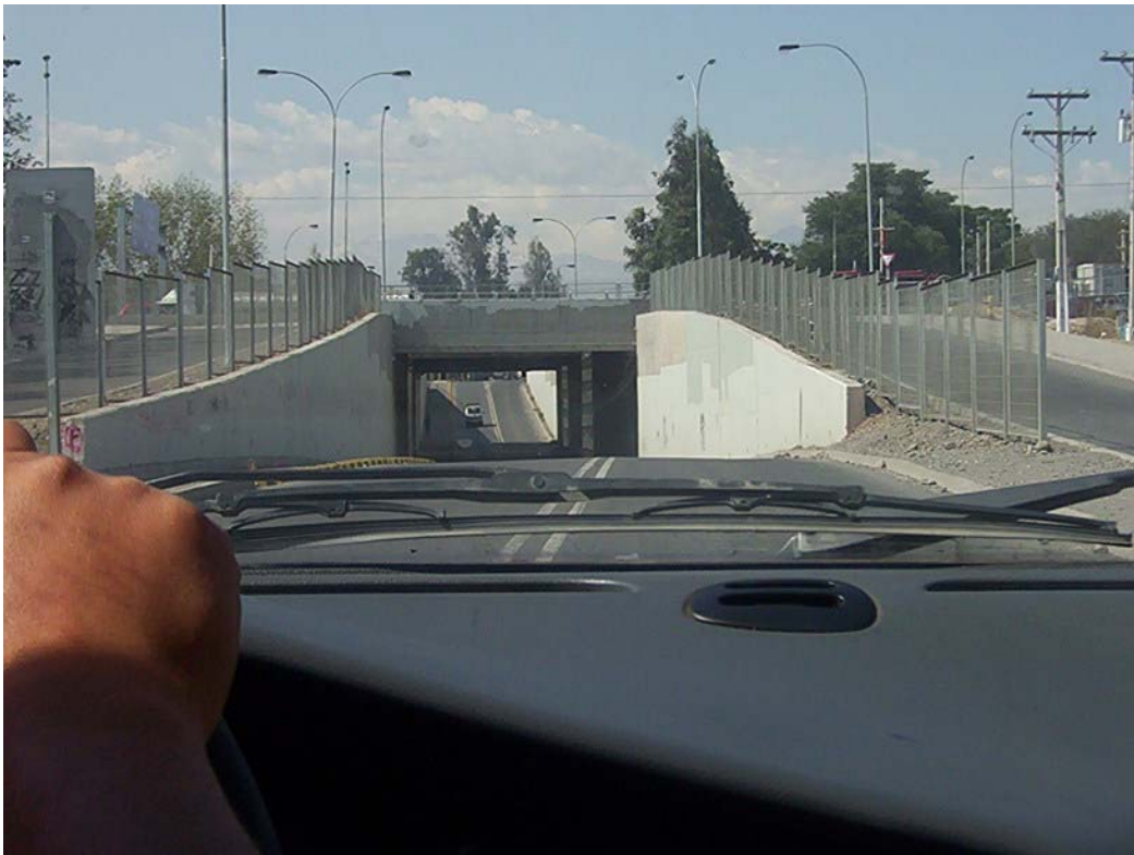
Paso Bajo Nivel Avenida Las Acacias (Camino Las Acacias) con Autopista Central, ubicado aproximadamente a 1 kilómetro del asentamiento Pérez Ossa.
