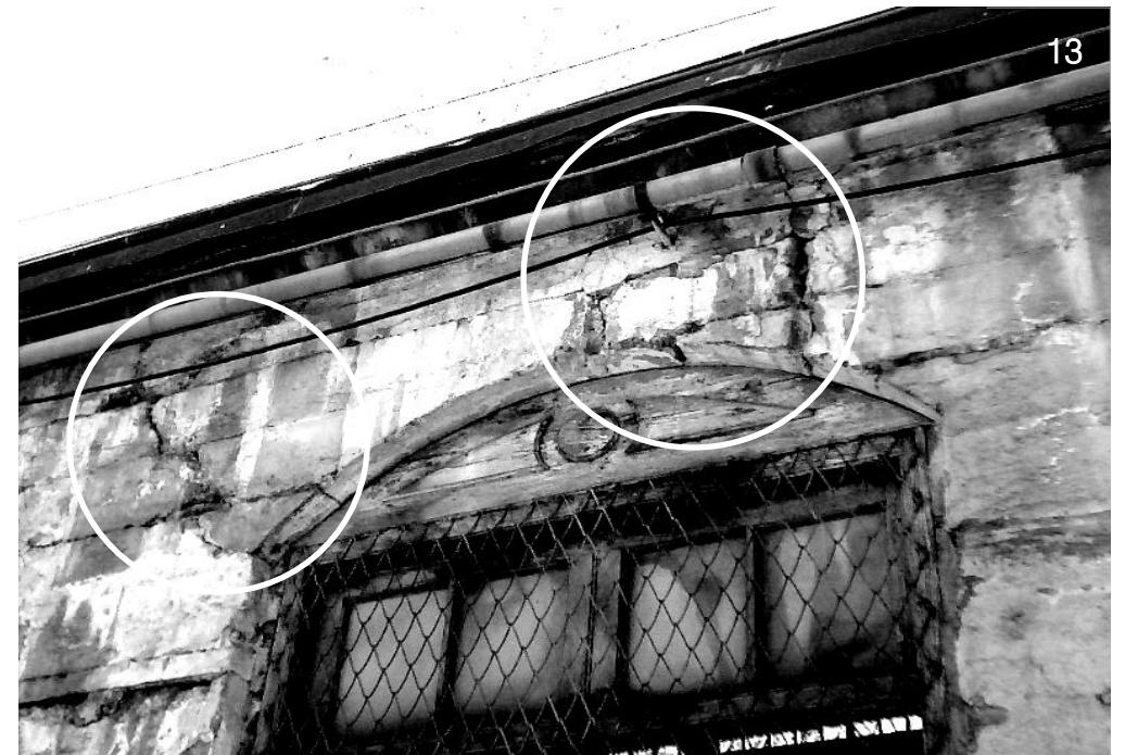
Fallo en dinteles de hormigón simple.
