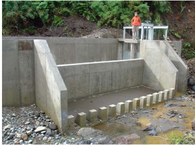
Figura 6-2: Desarenador con vertedero lateral y compuertas de control.
