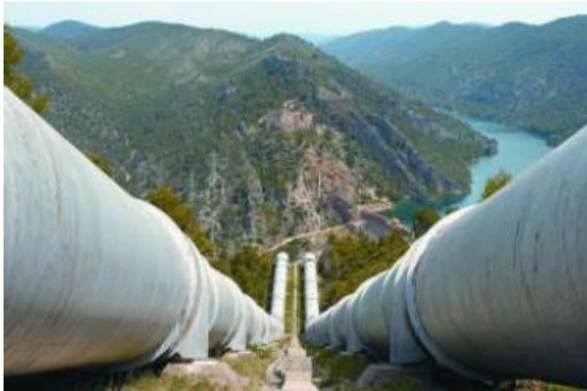
Figura 6-4: Tubería en presión.
