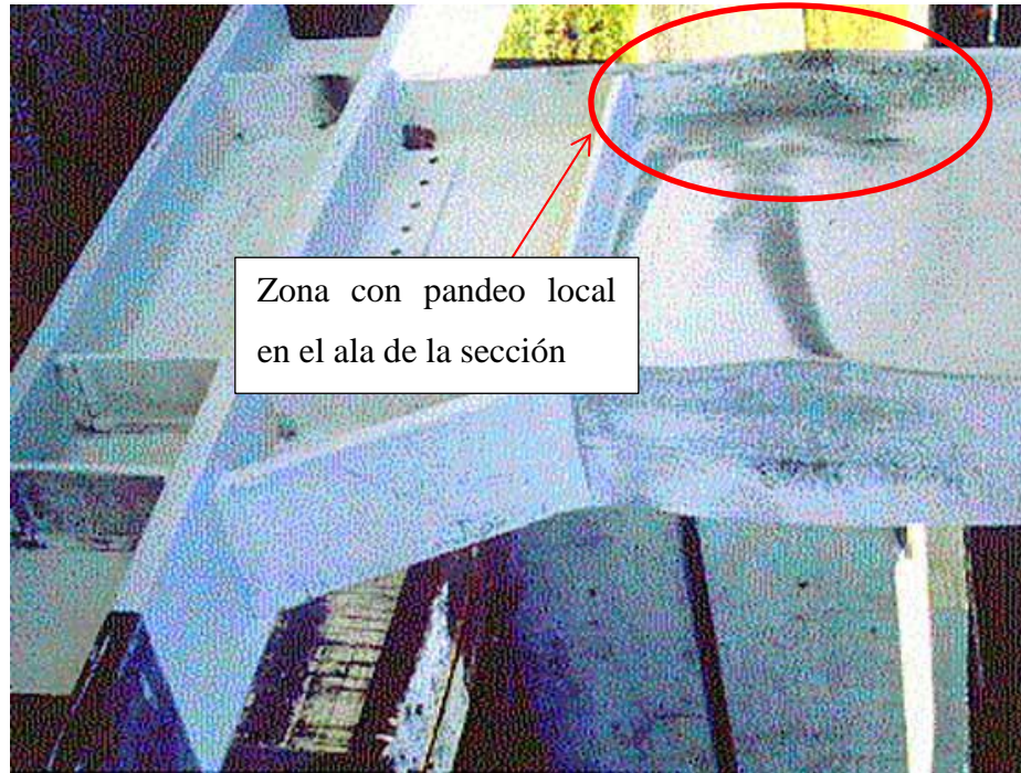
Figura IV.24: Pandeo sección ensayo #21
