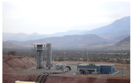
Imagen 3: Sistema de Captación y Abatimiento Bio Gas
