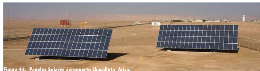
Figura 43. Paneles Solares aeropuerto Chacalluta, Arica.
