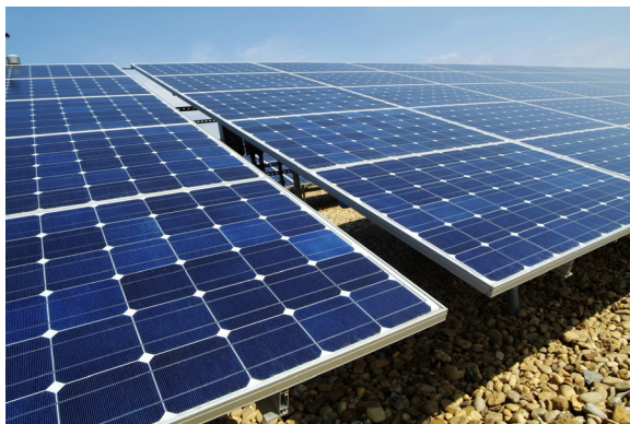
Figura 5. Paneles Solares Fotovoltaicos Fuente: www.peusso.com.ar
