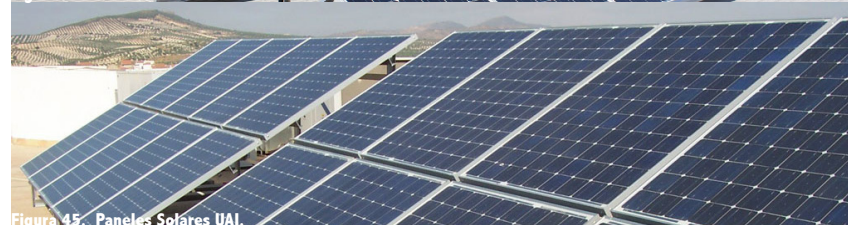
Figura 45. Paneles Solares UAI.
