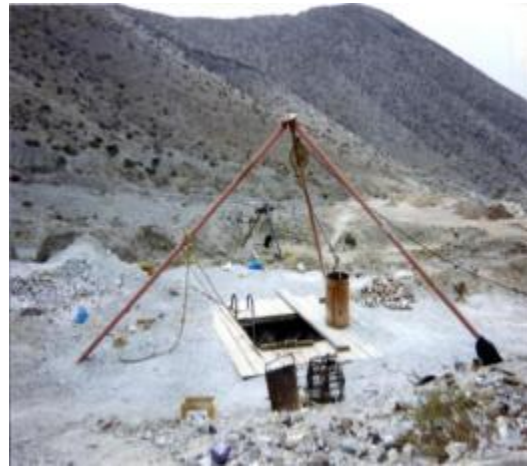
Pata de cabra y portalón de pique
