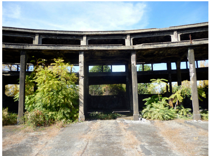
Fig. 80: Casa de Máquinas San Rosendo Fuente: Elaboración propia
