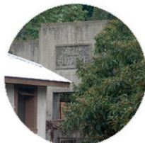
06 - Ruinas Inmueble Agua Potable
