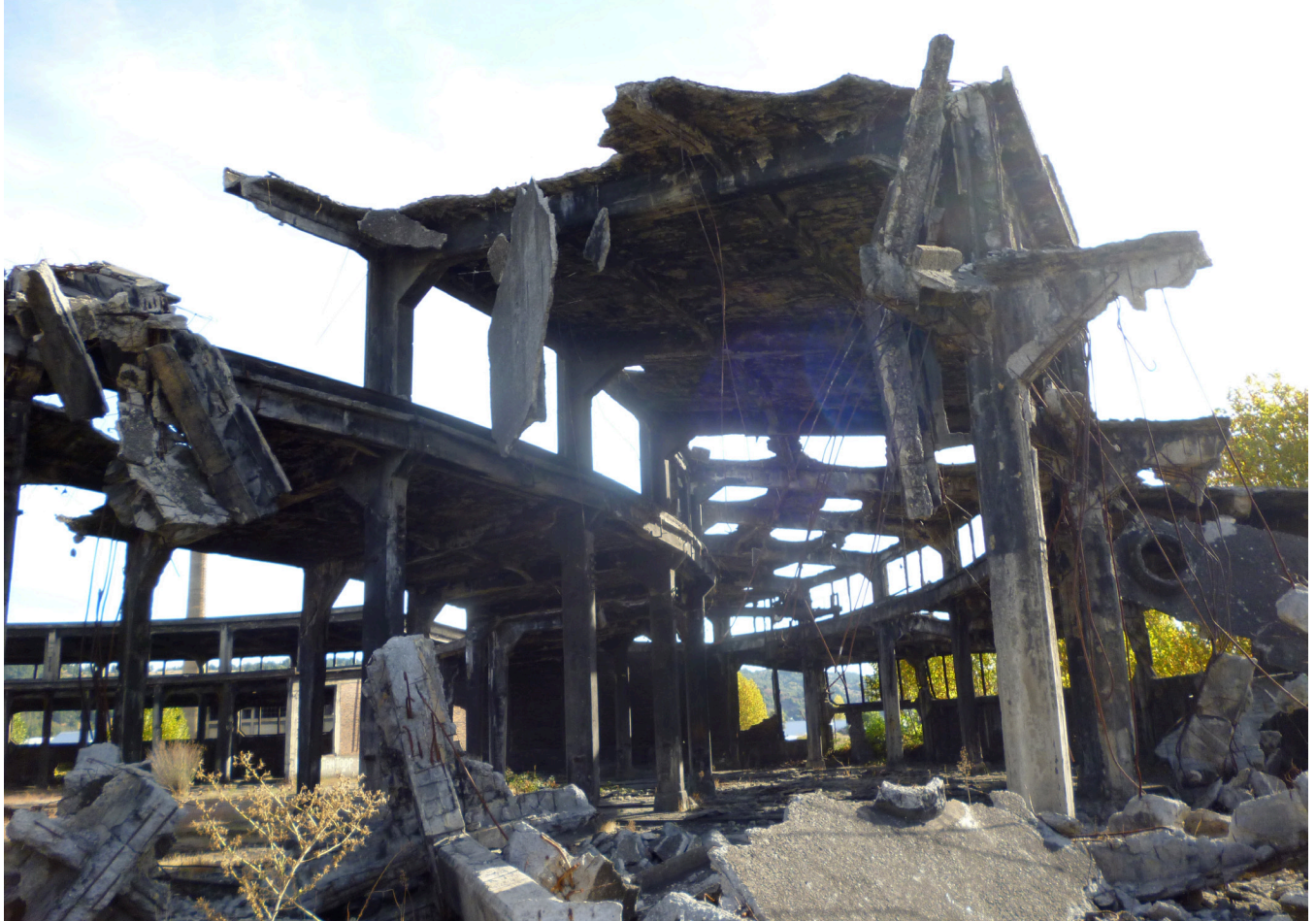
Fig. 27: Casa de Máquinas, año 2012 (Sector gravemente afectado por el terremoto del 27 de Febrero de 2010). [Fuente Imagen: Elaboración Propia.]
