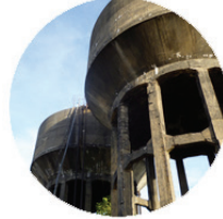
10 - Torres de Agua
