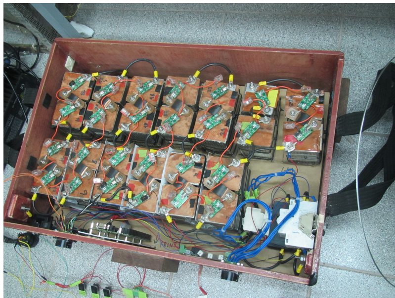
Figura C.4: Banco de baterías Eolian III.
