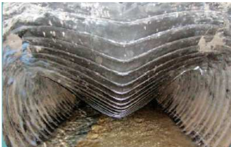
Figura 2.7: Daño en Colector Zona Norte, Santiago (Ahumada y Duarte, 2012)
