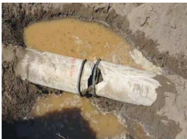
Figura 2.6: Rotura de Impulsión a Navidad (Ahumada y Duarte, 2012)
