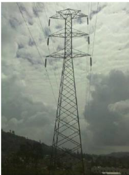
Figura 2.1 Torre de suspensión
