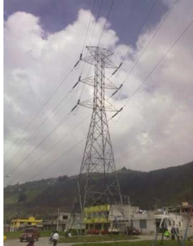
Figura 2.2 Torres de Anclaje
