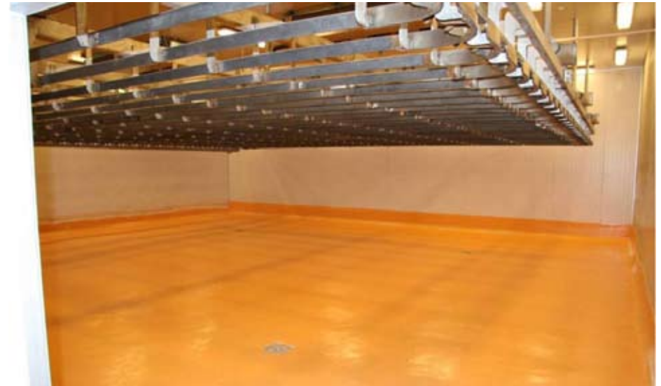
Figura 146: Cámara de Frío
