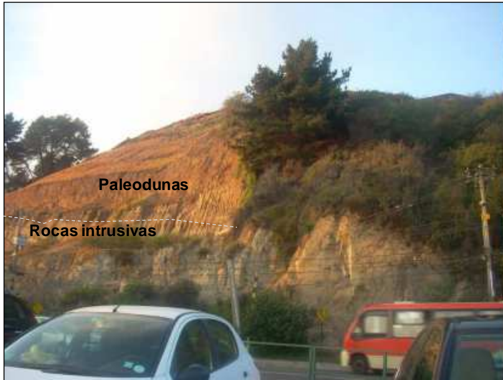
Fotografía 5.9. Evidencias de procesos erosivos y meteorización (cárcavas) en paleodunas y rocas intrusivas Fuente: Obtención propia. Sector Las Salinas – Reñaca.
