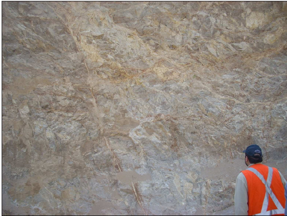
Fotografía 7.4.a. Talud NW, mostrando zona de cizalle, con presencia de fallas y planos de debilidad. Baja resistencia de la roca (dureza estimada R1 a R2). Fuente: Obtención propia
