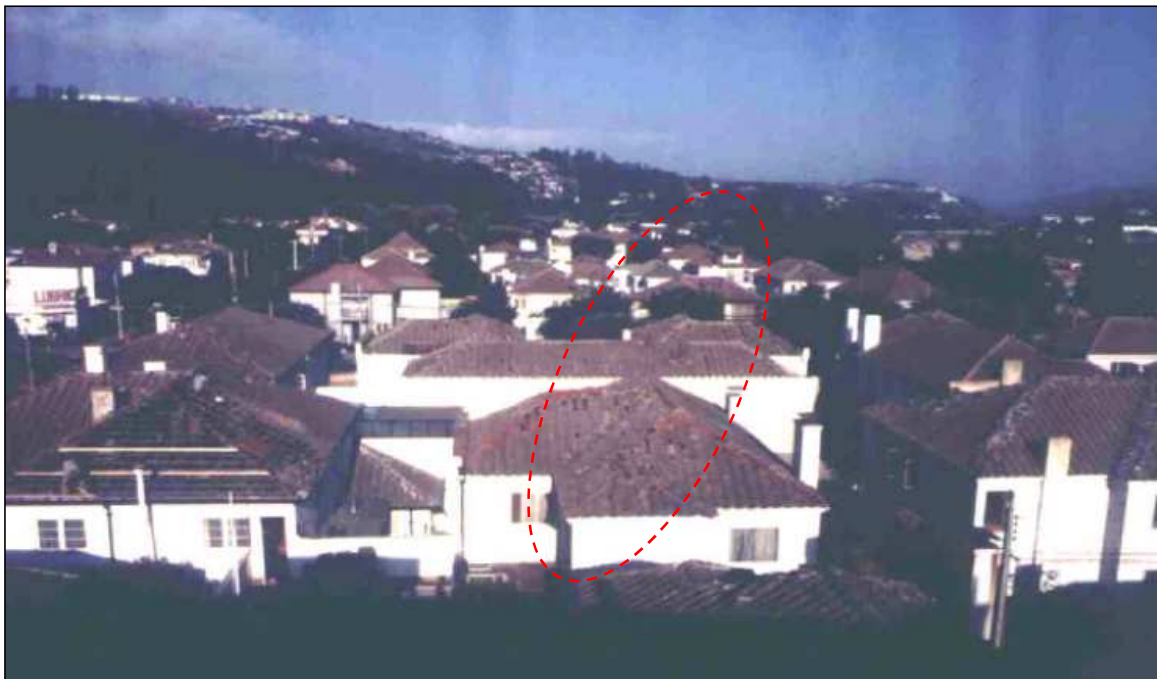
Fotografía 7.2. Daños locales en techos de casas ubicadas sobre el trazado de la falla Marga-Marga (1 Norte con 5 Oriente, destacado en rojo) producto del terremoto de 1985 Fuente: Galdanes y Saragoni, 2002.
