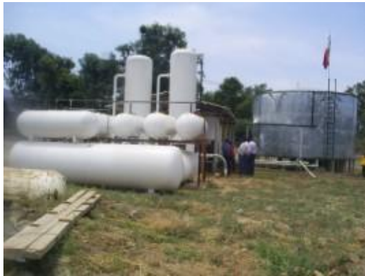
Planta generadora de Biogás.
