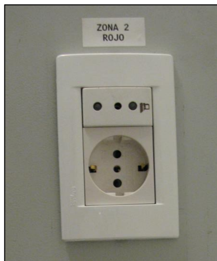
Figura 56: Enchufes hembra schuko y de computación al costado del gabinete. En estos enchufes se conectan las chaquetas calefactoras y la termocupla respectivamente.
