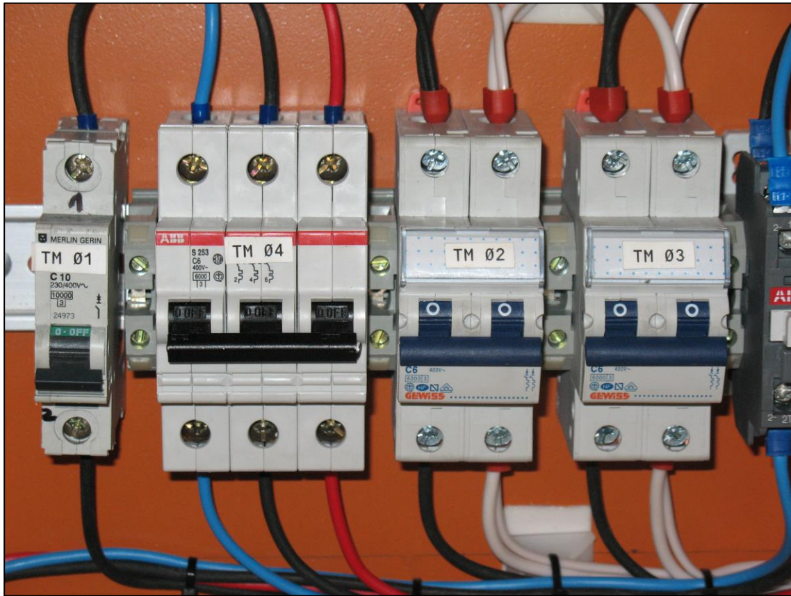
Figura 54: Riel DIN 1/16 donde se montaron los termomagnéticos. De izquierda a derecha se observa el termomagnético monopolar maestro, el tripolar que enciende el motor, y los dos bipolares que conectan las dos zonas de calefacción.
