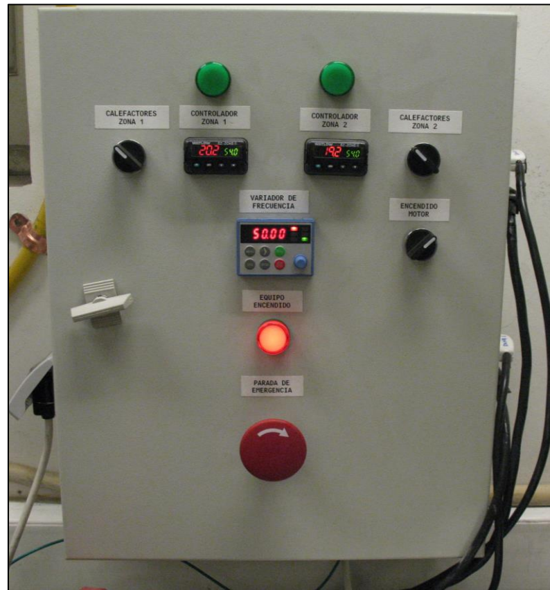
Figura 50: Gabinete eléctrico para control el control del reactor.
