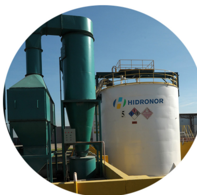
Fig. 1.7: Planta tratamiento residuos tecnológicos, Pudahuel, Región Metropolitana
