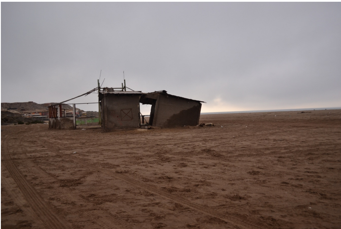
FIGURA 13. VIVIENDA DESTRUIDA DESPUÉS DE TSUNAMI 11/03/2011.
