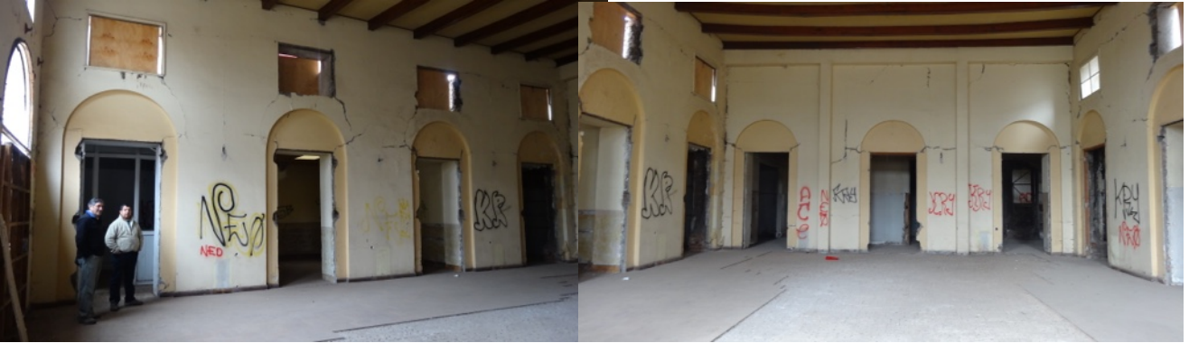
Salón 2, comedor restaurante, mal estado. Presencia de fisuras y gritas
