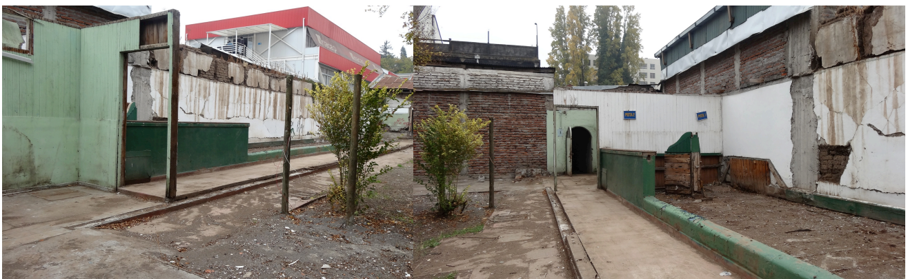
Sala palitroque, estructura colapsada
