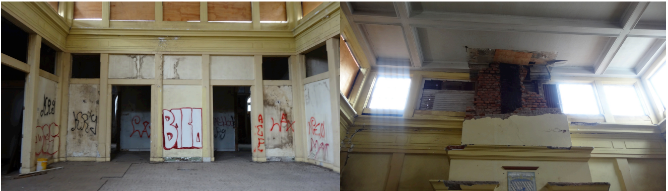
Salón 1, hall, estado regular / hall, chimenea, mal estado.
