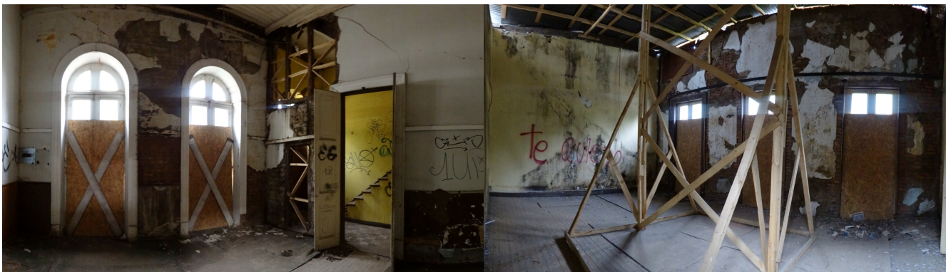
Zona Fachada , sala de juegos primer nivel, tabique en mal estado / oficina segundo nivel , mal estado
