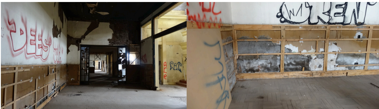
Zona lateral, salón 1, comedor, estado regular.
