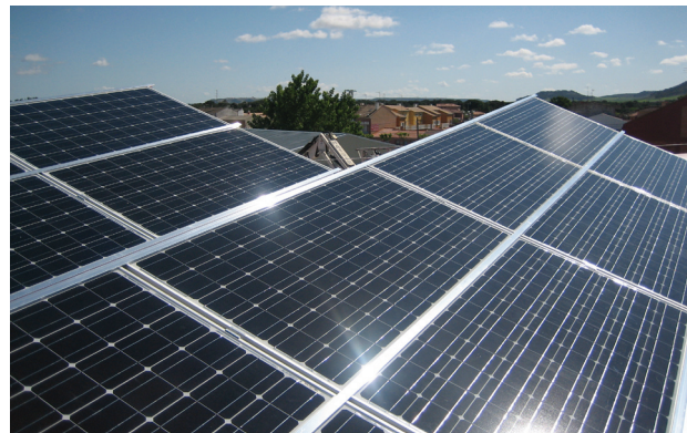
Figura n°40. Paneles fotovoltaicos. Fuente: imágenes de Google.
