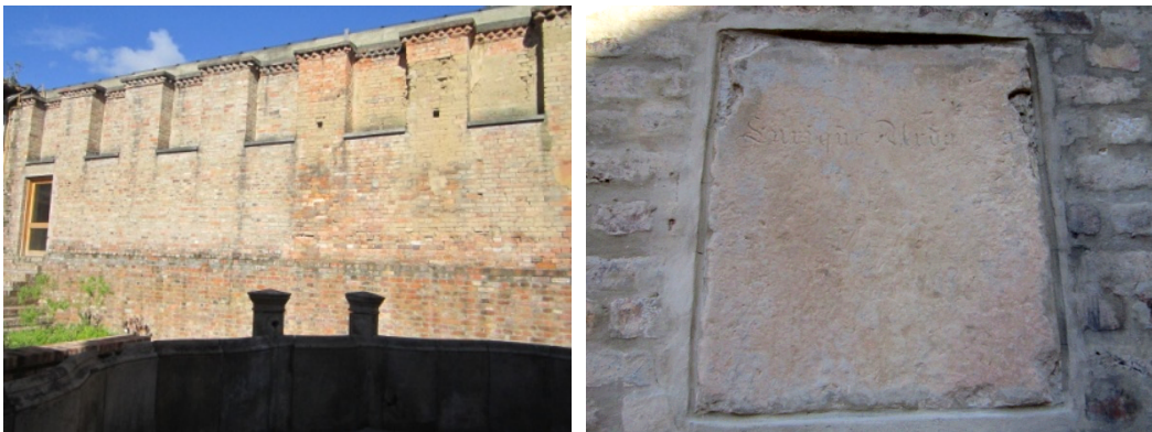
Imagen 55: Muro que encierra espacio Masón y Placa en portal. Ref. Archivo fotográfico CRC. 203
